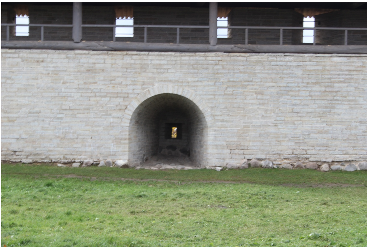
38. Печура подошвенного боя северо-западного прясла. Вид с востока.
