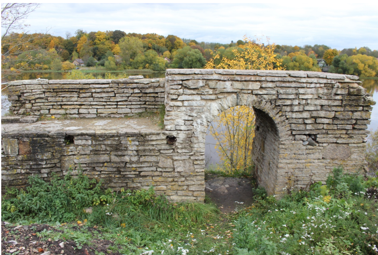
36. Фрагмент восточного прясла стены XII в. с «торговой аркой». Вид с запада.
