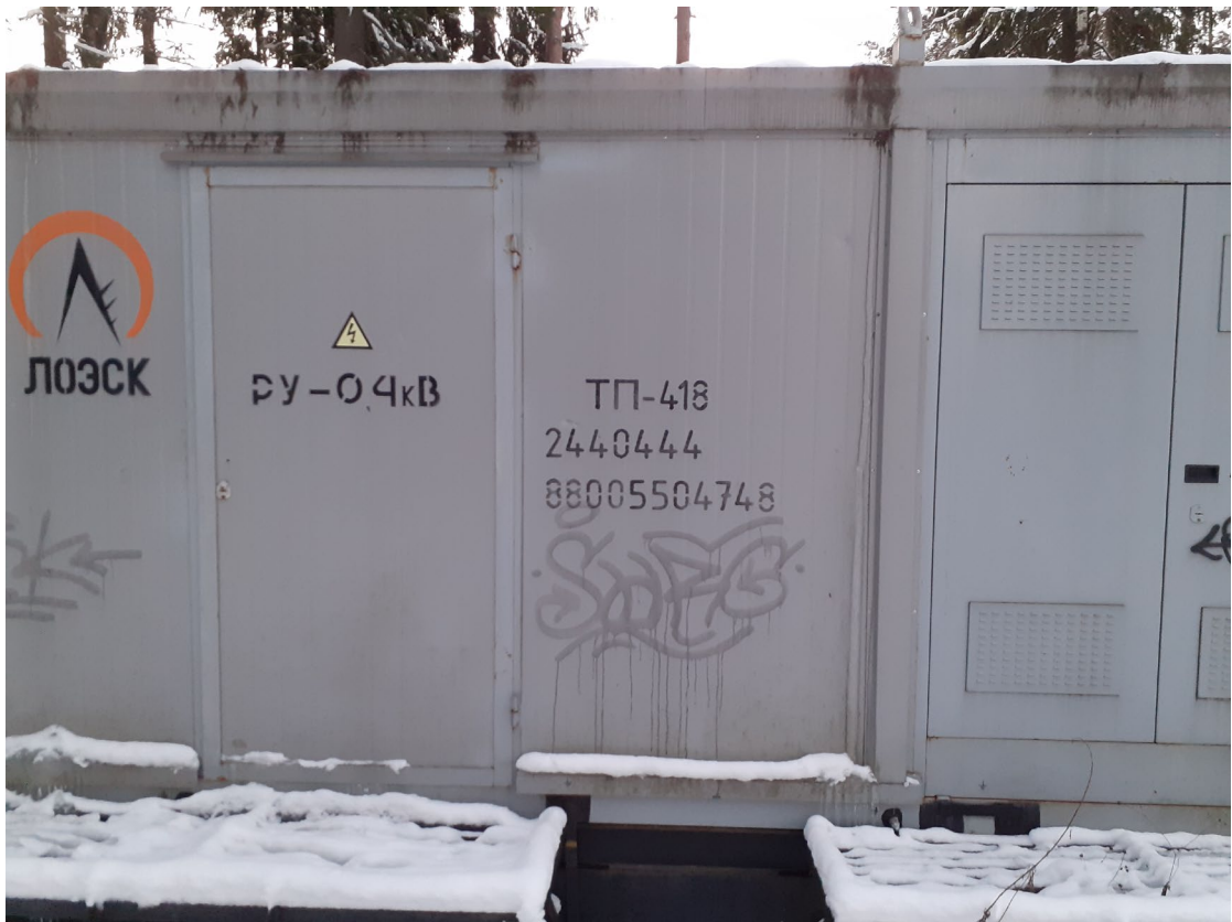
Рис. 22. Фотофиксация 2021 г. ОКН «Углежогная куча Сертолово 1». Трансформаторная подстанция (ТП-418).
