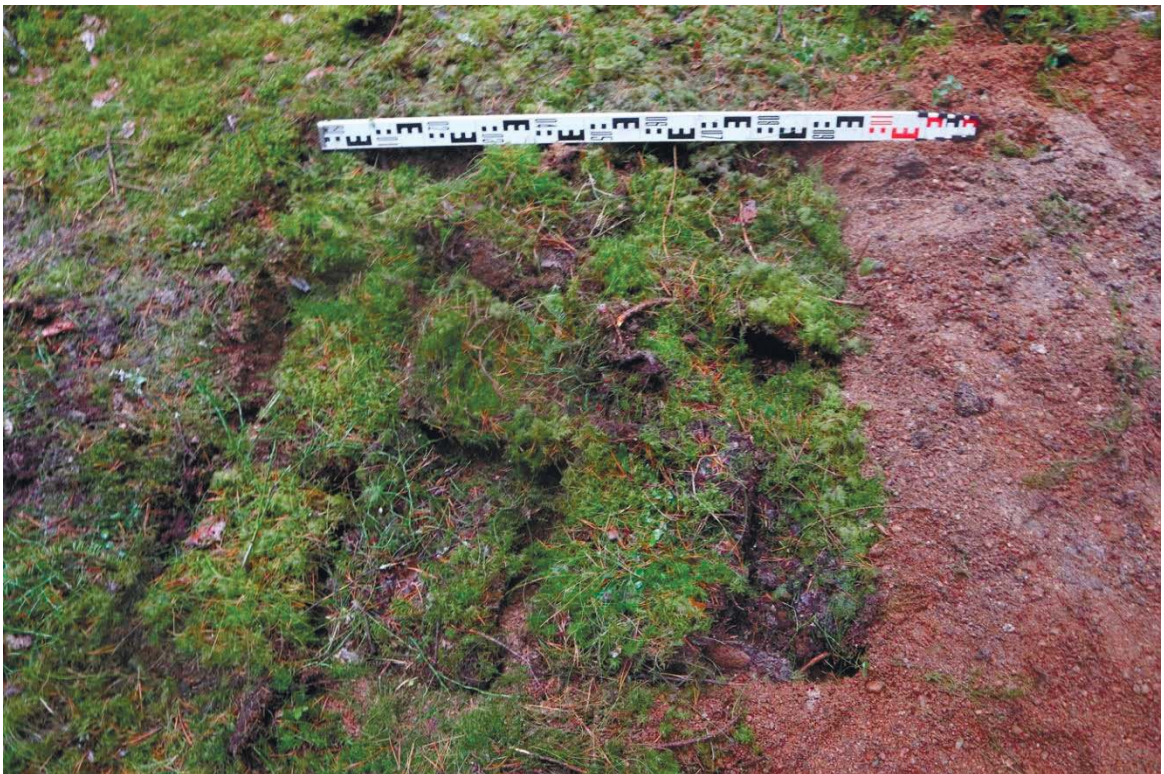
Рис. 420. Ленинградская область, Выборгский район. Строительство подъездной автомобильной дороги к «Приморскому универсально-перегрузочному комплексу» в Морском порту Приморск от автомобильной дороги федерального значения А-181 «Скандинавия». ОАН «Стоянка Черничное 2». Шурф 79. Рекультивация. Вид с юга
