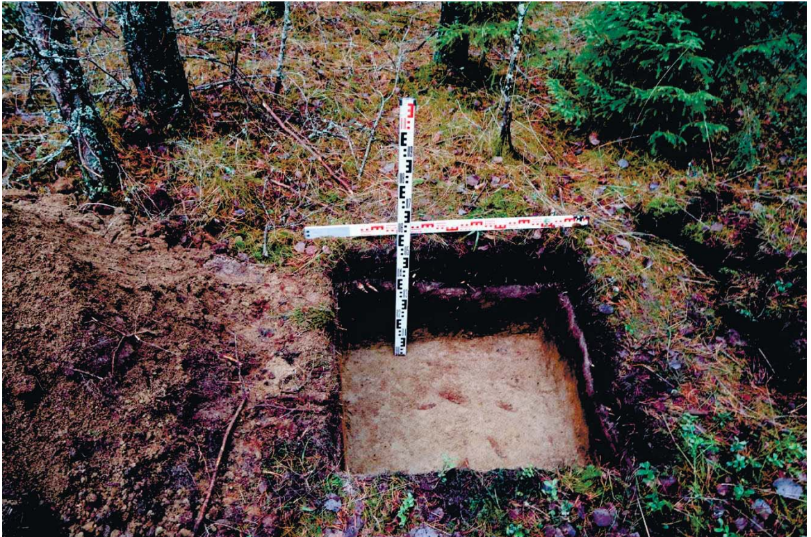
Рис. 96. Ленинградская область, Выборгский район. Строительство подъездной автомобильной дороги к «Приморскому универсально-перегрузочному комплексу» в Морском порту Приморск от автомобильной дороги федерального значения А-181 «Скандинавия». Шурф 17. Общий вид зачистки по материковому слою. Вид с юга
