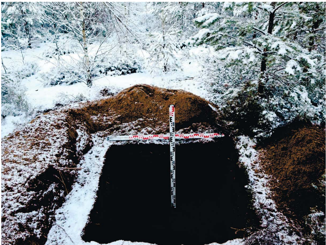
Рис. 271. Ленинградская область, Выборгский район. Строительство подъездной автомобильной дороги к «Приморскому универсально-перегрузочному комплексу» в Морском порту Приморск от автомобильной дороги федерального значения А-181 «Скандинавия». Шурф 56. Общий вид зачистки по материковому слою. Вид с юга
