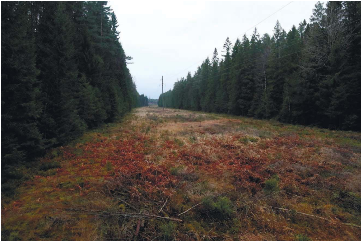
Рис. 305. Ленинградская область, Выборгский район. Строительство подъездной автомобильной дороги к «Приморскому универсально-перегрузочному комплексу» в Морском порту Приморск от автомобильной дороги федерального значения А-181 «Скандинавия». Прохождение трассы проектируемой автодороги через ЛЭП к северу от поселения Глебычево 3. Вид с юго-востока
