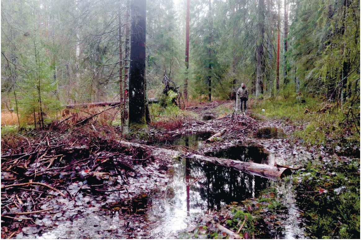
Рис. 17. Ленинградская область, Выборгский район. Строительство подъездной автомобильной дороги к «Приморскому универсально-перегрузочному комплексу» в Морском порту Приморск от автомобильной дороги федерального значения А-181 «Скандинавия». Прохождение трассы проектируемой автодороги в междуречье ручьев Каменный и Мельничный. Вид с юга
