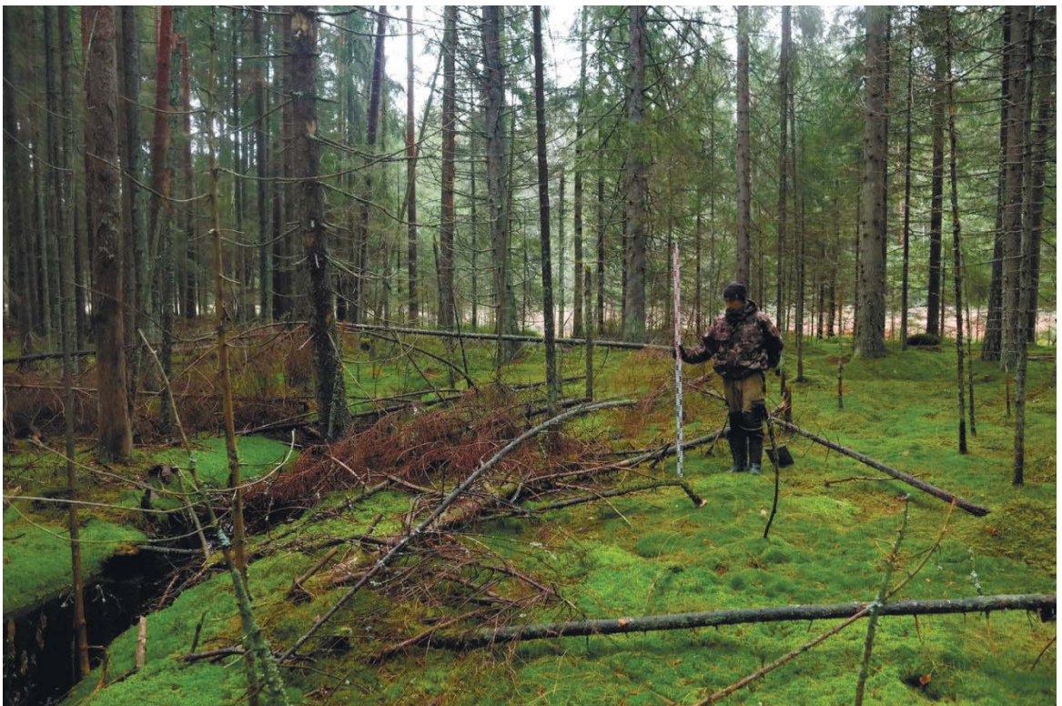
Рис. 304. Ленинградская область, Выборгский район. Строительство подъездной автомобильной дороги к «Приморскому универсально-перегрузочному комплексу» в Морском порту Приморск от автомобильной дороги федерального значения А-181 «Скандинавия». Прохождение трассы проектируемой автодороги вдоль безымянного ручья к северу от поселения Глебычево 3. Вид с юго-запада
