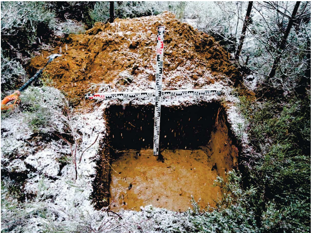
Рис. 227. Ленинградская область, Выборгский район. Строительство подъездной автомобильной дороги к «Приморскому универсально-перегрузочному комплексу» в Морском порту Приморск от автомобильной дороги федерального значения А-181 «Скандинавия». Шурф 46. Общий вид зачистки по материковому слою. Вид с юга
