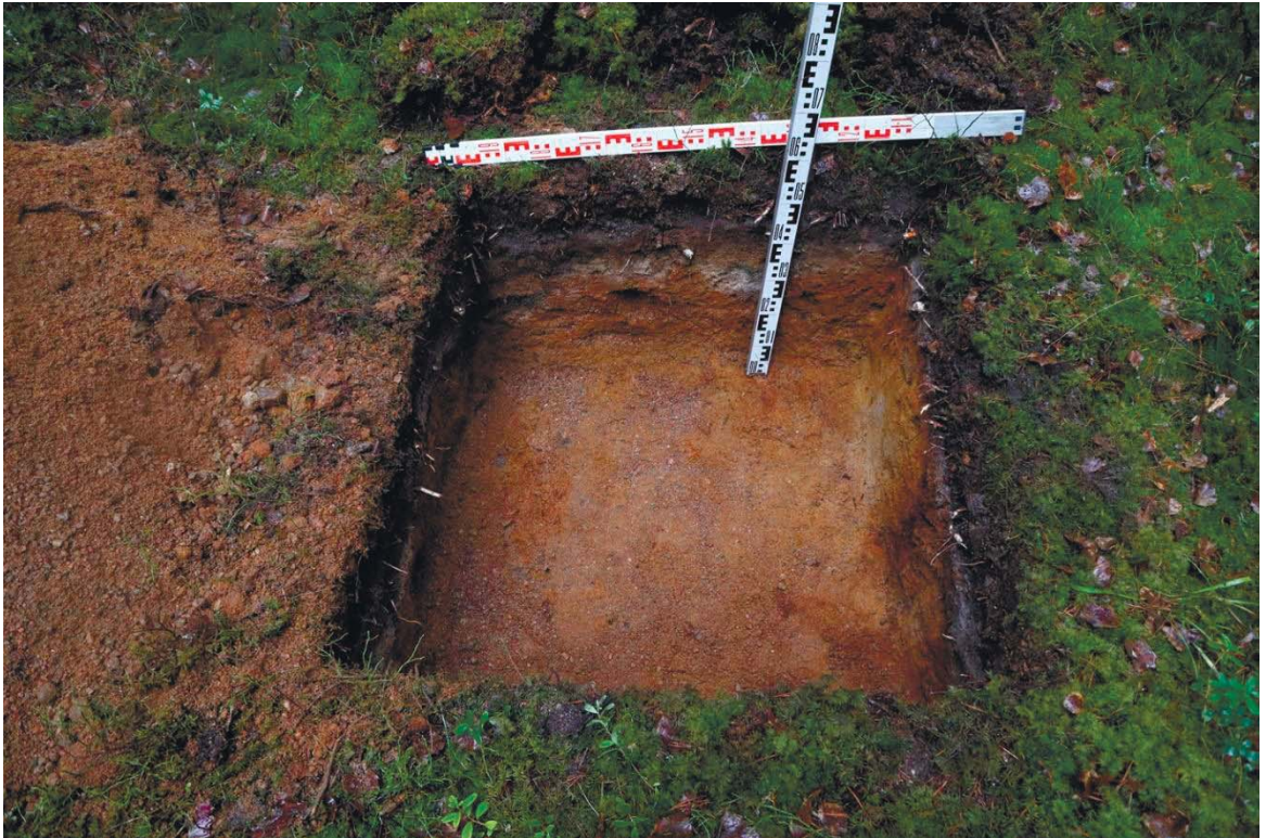
Рис. 422. Ленинградская область, Выборгский район. Строительство подъездной автомобильной дороги к «Приморскому универсально-перегрузочному комплексу» в Морском порту Приморск от автомобильной дороги федерального значения А-181 «Скандинавия». ОАН «Стоянка Черничное 2». Шурф 80. Общий вид зачистки по материковому слою. Вид с юга
