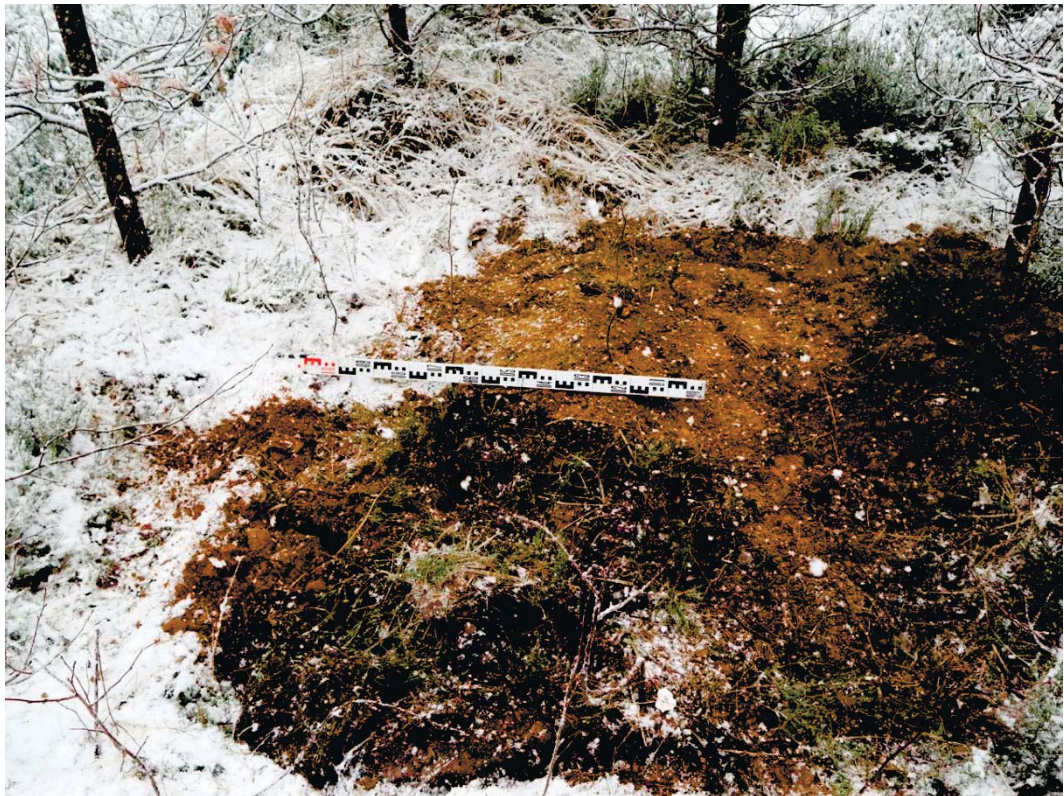
Рис. 241. Ленинградская область, Выборгский район. Строительство подъездной автомобильной дороги к «Приморскому универсально-перегрузочному комплексу» в Морском порту Приморск от автомобильной дороги федерального значения А-181 «Скандинавия». Шурф 49. Рекультивация. Вид с юга
