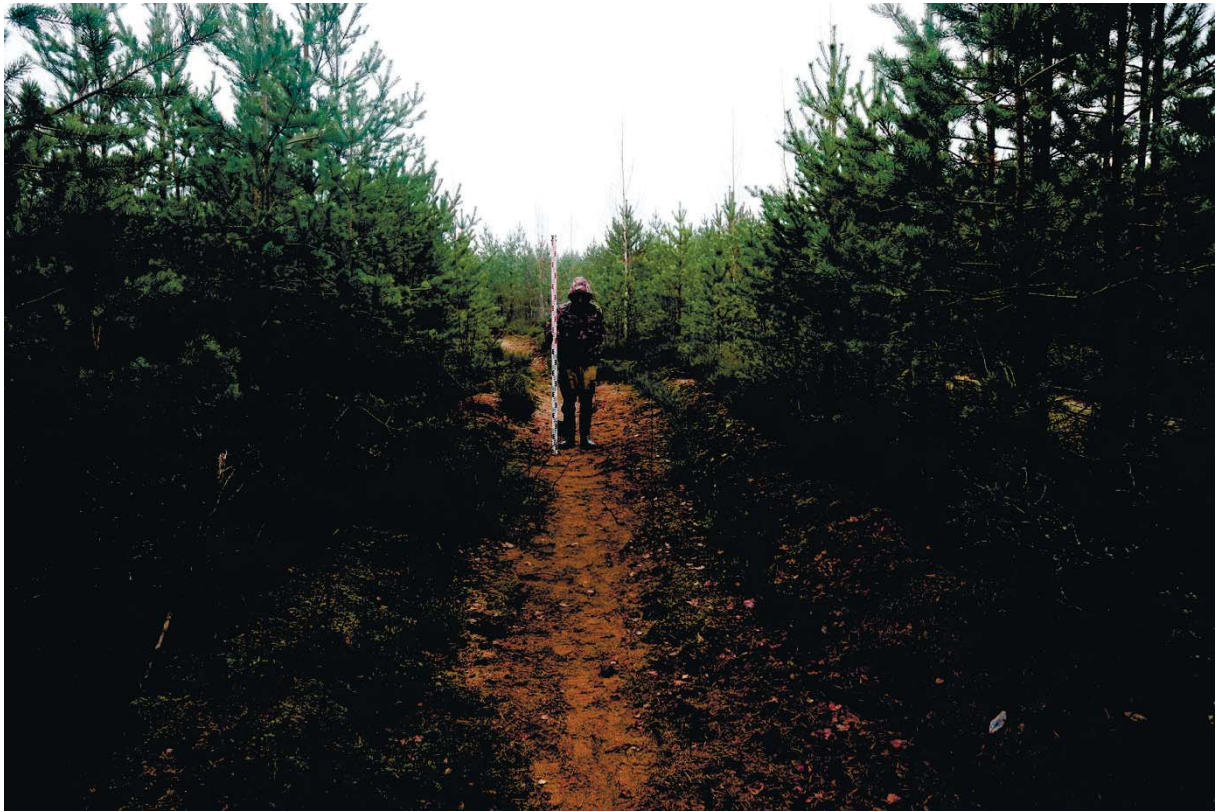
Рис. 217. Ленинградская область, Выборгский район. Строительство подъездной автомобильной дороги к «Приморскому универсально-перегрузочному комплексу» в Морском порту Приморск от автомобильной дороги федерального значения А-181 «Скандинавия». Шурф 45. Общий вид до начала работ. Вид с северо-запада
