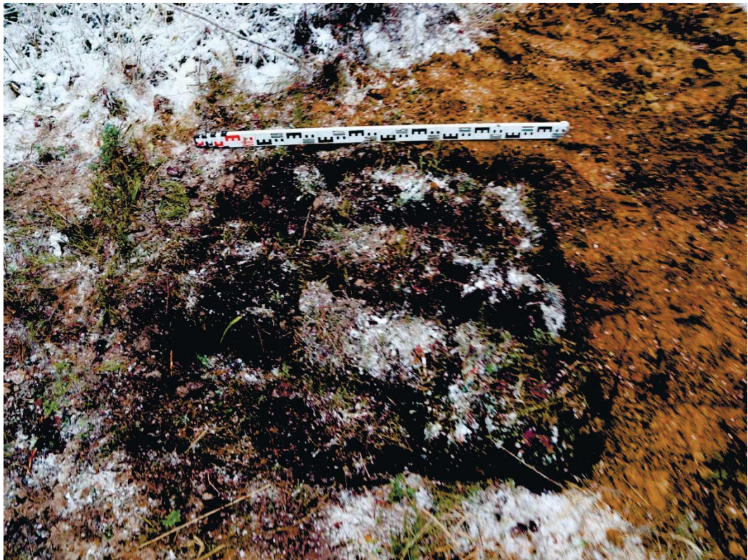
Рис. 253. Ленинградская область, Выборгский район. Строительство подъездной автомобильной дороги к «Приморскому универсально-перегрузочному комплексу» в Морском порту Приморск от автомобильной дороги федерального значения А-181 «Скандинавия». Шурф 52. Рекультивация. Вид с юга
