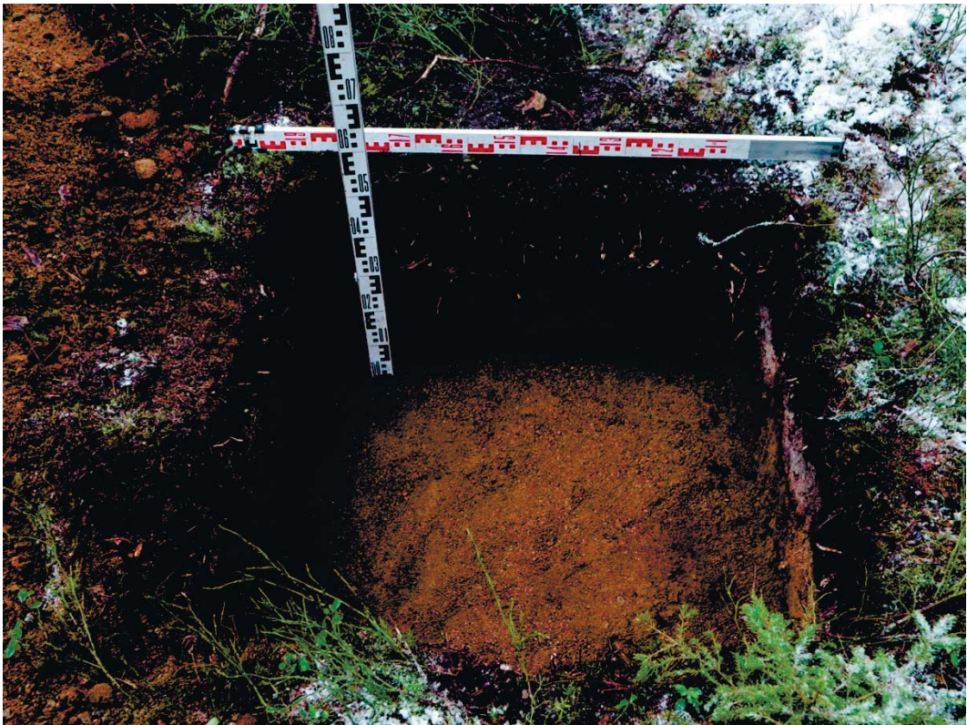
Рис. 180. Ленинградская область, Выборгский район. Строительство подъездной автомобильной дороги к «Приморскому универсально-перегрузочному комплексу» в Морском порту Приморск от автомобильной дороги федерального значения А-181 «Скандинавия». Шурф 37. Общий вид зачистки по материковому слою. Вид с юга
