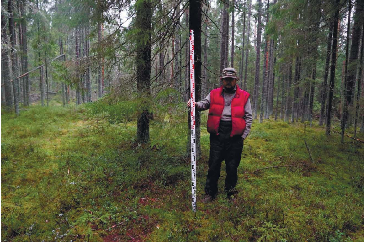
Рис. 421. Ленинградская область, Выборгский район. Строительство подъездной автомобильной дороги к «Приморскому универсально-перегрузочному комплексу» в Морском порту Приморск от автомобильной дороги федерального значения А-181 «Скандинавия». ОАН «Стоянка Черничное 2». Шурф 80. Общий вид до начала работ. Вид с юга
