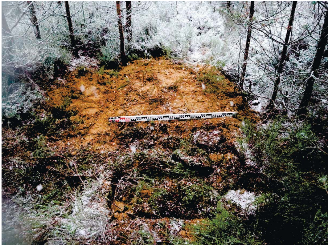
Рис. 229. Ленинградская область, Выборгский район. Строительство подъездной автомобильной дороги к «Приморскому универсально-перегрузочному комплексу» в Морском порту Приморск от автомобильной дороги федерального значения А-181 «Скандинавия». Шурф 46. Рекультивация. Вид с юга
