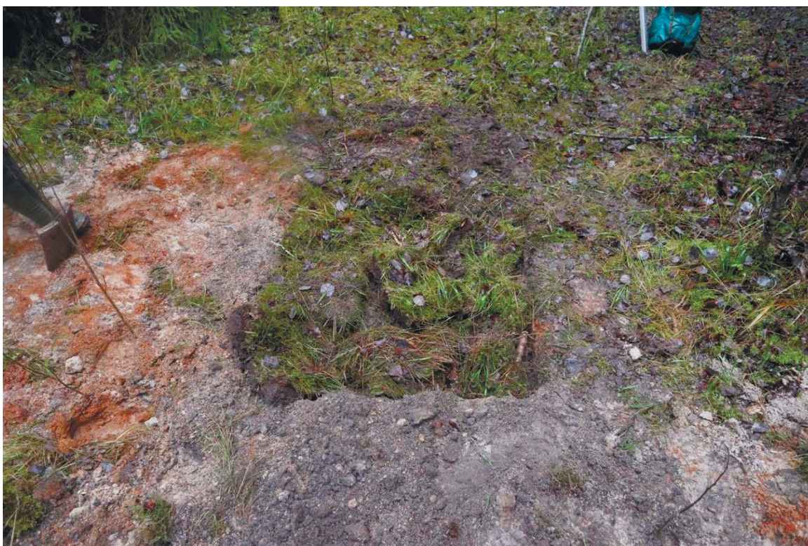
Рис. 356. Ленинградская область, Выборгский район. Строительство подъездной автомобильной дороги к «Приморскому универсально-перегрузочному комплексу» в Морском порту Приморск от автомобильной дороги федерального значения А-181 «Скандинавия». Шурф 72. Рекультивация. Вид с юга
