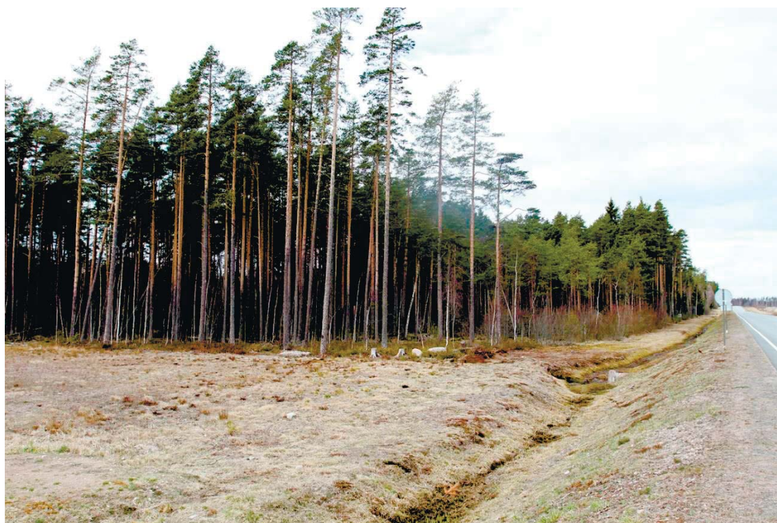
Рис. 14. Ленинградская область, Выборгский район. Строительство подъездной автомобильной дороги к «Приморскому универсально-перегрузочному комплексу» в Морском порту Приморск от автомобильной дороги федерального значения А-181 «Скандинавия». Общий вид трассы проектируемой автодороги в месте подхода к «Приморскому универсально-перегрузочному комплексу». Вид с Приморского шоссе с юго-запада
