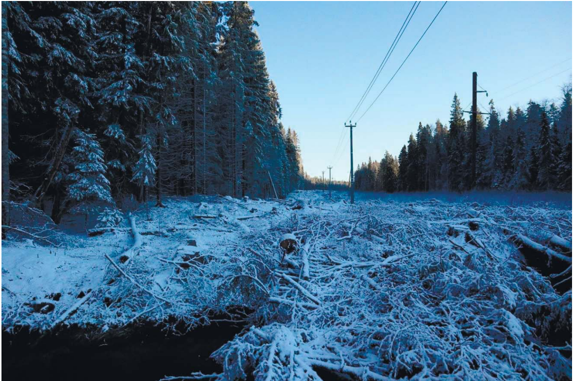
Рис. 495. Ленинградская область, Выборгский район. Строительство подъездной автомобильной дороги к «Приморскому универсально-перегрузочному комплексу» в Морском порту Приморск от автомобильной дороги федерального значения А-181 «Скандинавия». Вид на правый берег р. Большая. Вид с юго-запада
