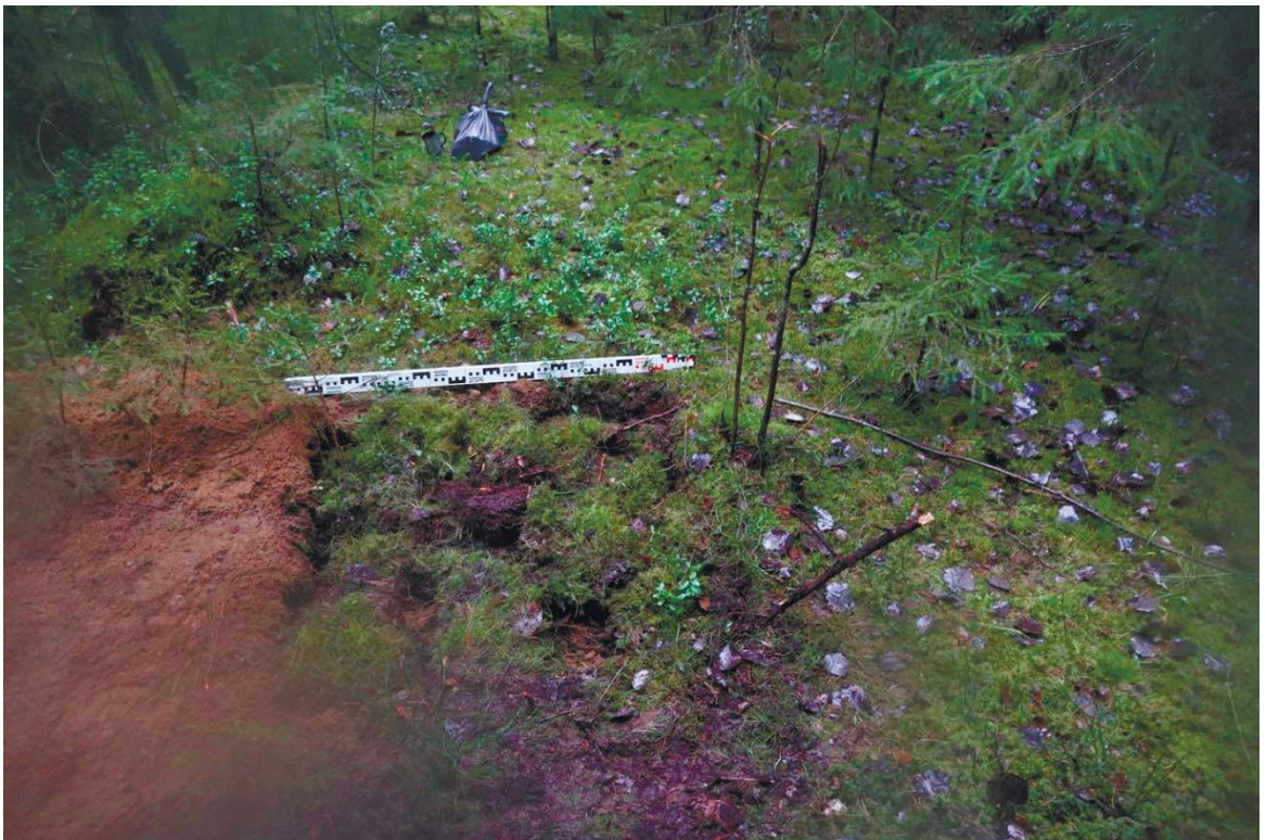
Рис. 387. Ленинградская область, Выборгский район. Строительство подъездной автомобильной дороги к «Приморскому универсально-перегрузочному комплексу» в Морском порту Приморск от автомобильной дороги федерального значения А-181 «Скандинавия». ОАН «Стоянка Черничное 2». Шурф 74. Рекультивация. Вид с юга
