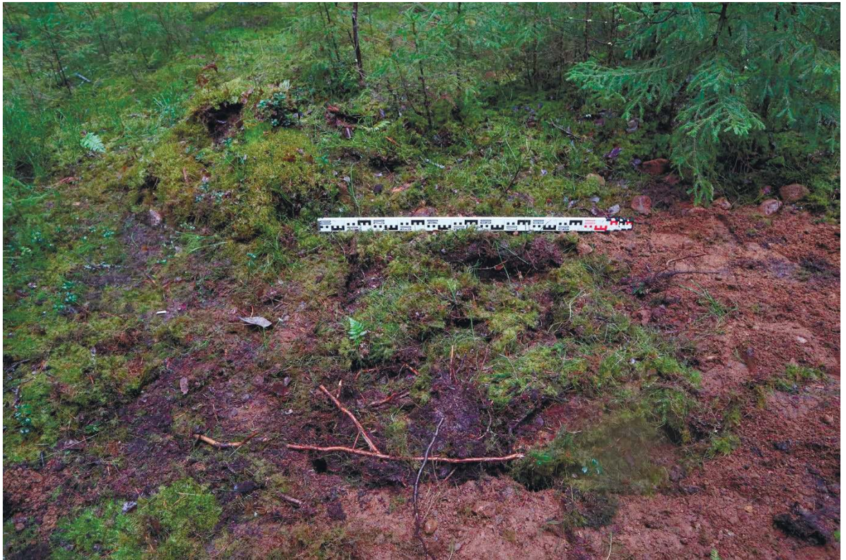
Рис. 382. Ленинградская область, Выборгский район. Строительство подъездной автомобильной дороги к «Приморскому универсально-перегрузочному комплексу» в Морском порту Приморск от автомобильной дороги федерального значения А-181 «Скандинавия». ОАН «Стоянка Черничное 2». Шурф 73. Рекультивация. Вид с юга
