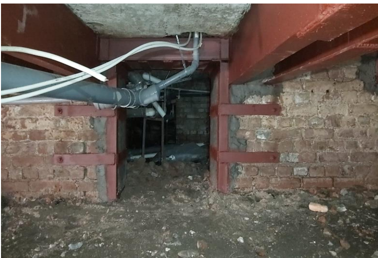
22. «Дом Петинена,1908 г.», Ленинградская область, Выборгский район, г. Выборг, Ленинградский пр., д. 31. Подвал. Фрагмент. Фото 05.03.2021 г.
