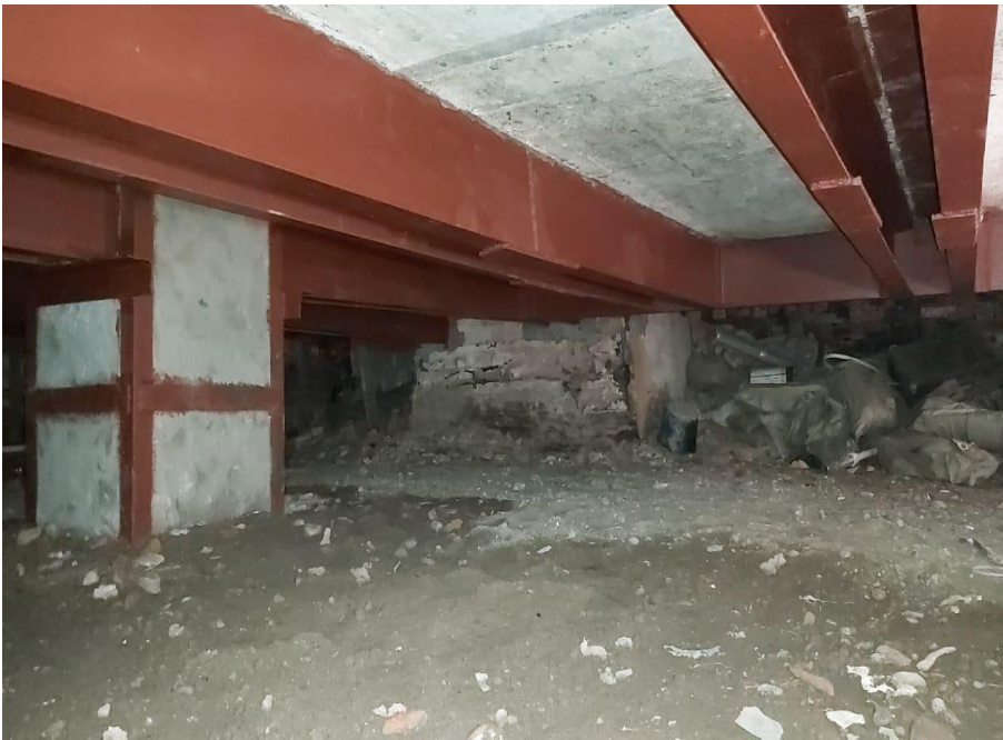
26. «Дом Петинена,1908 г.», Ленинградская область, Выборгский район, г. Выборг, Ленинградский пр., д. 31. Подвал. Фрагмент. Фото 05.03.2021 г.
