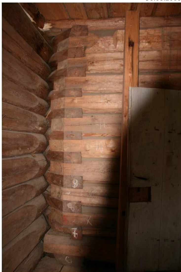
16. Никольская церковь (деревянная). Внутренний угол. Давыдова Н.А. 30.08.2018.
