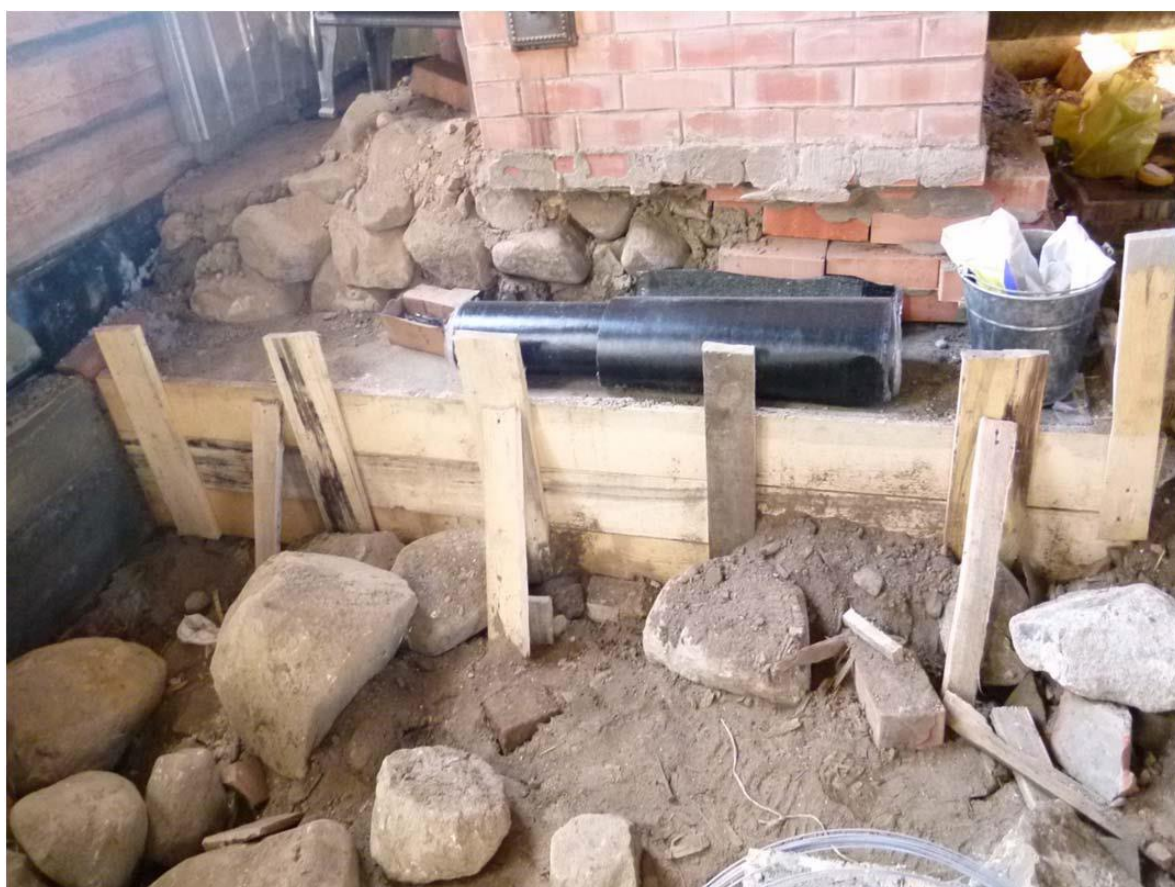
Илл. 30. Процесс ремонтных работ церкви святого пророка Илии. 2010-е г. Устройство фундамента новодельной кирпичной печи.
