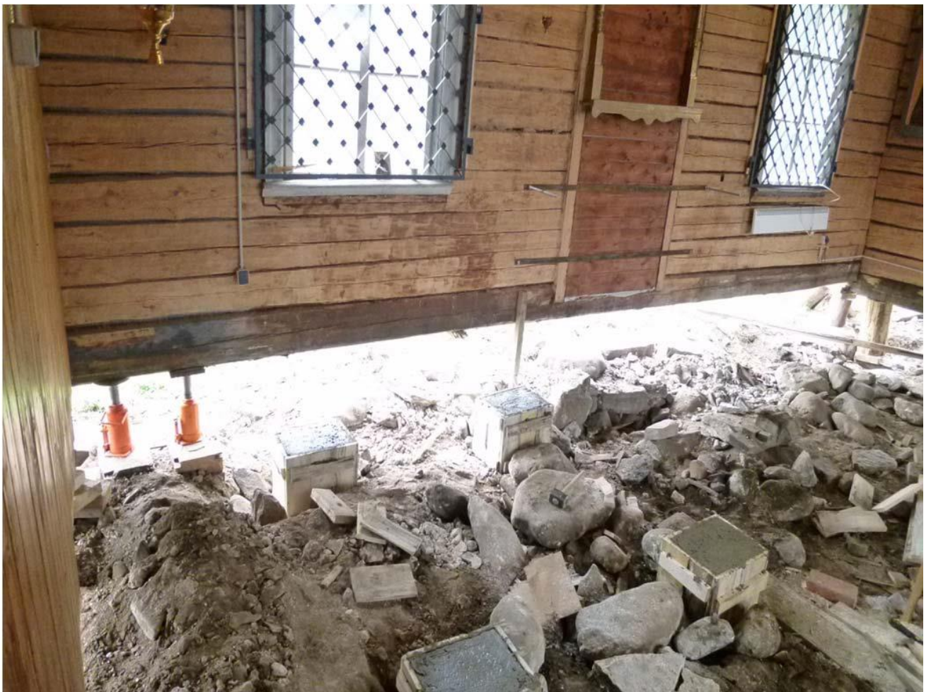
Илл. 28. Процесс ремонтных работ церкви святого пророка Илии. 2010-е г. Замена нижних венцов и устройство новых фундаментных конструкций
