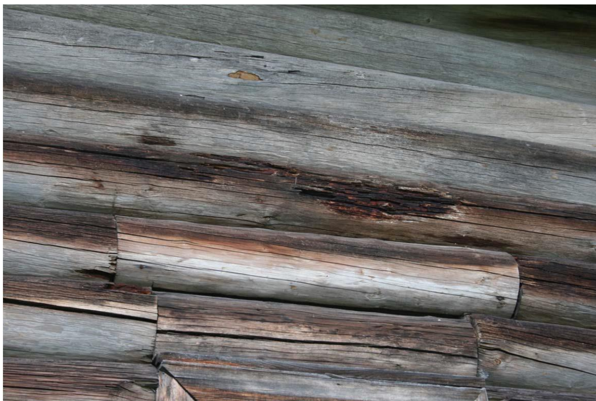
9. Никольская церковь (деревянная). Протезы бревен сруба. Давыдова Н.А. 30.08.2018.
