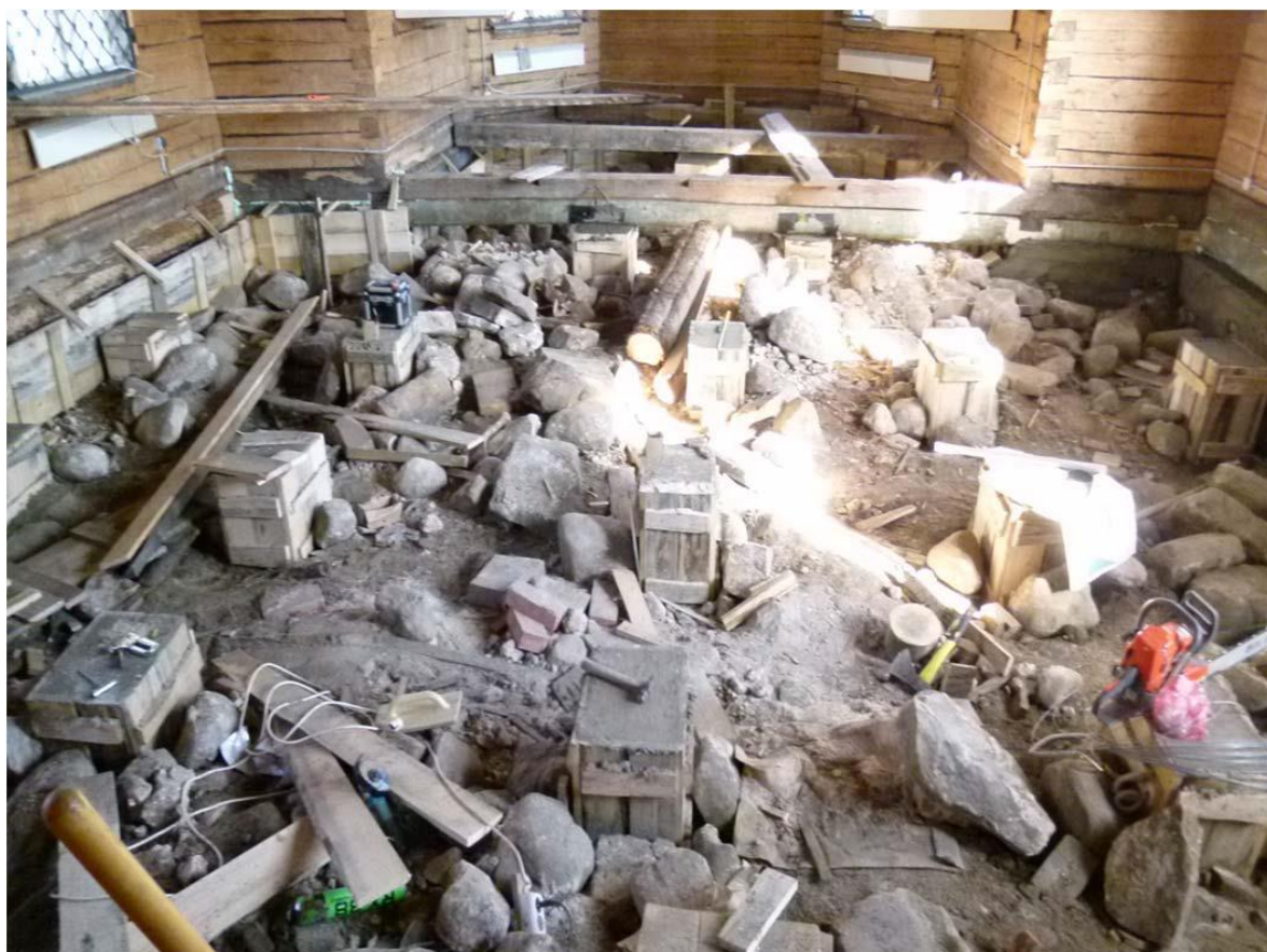
Илл. 29. Процесс ремонтных работ церкви святого пророка Илии. 2010-е г. Устройство бетонных столбиков опирания половых лаг.
