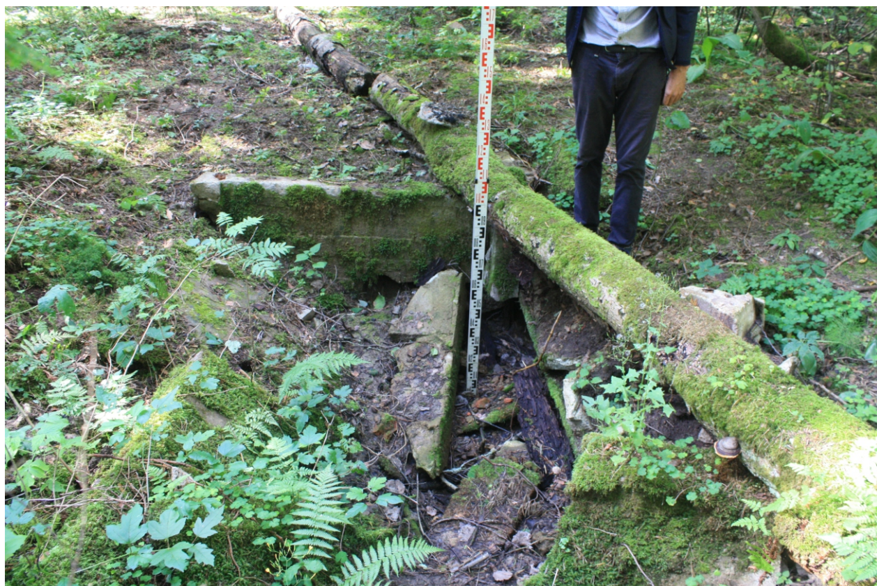
Илл. 30. Ленинградская область. Лужский муниципальный район. г. Луга. Участок с кадастровым номером 47:29:0103018:316. Точка фото-фиксации №11. Общий вид на южную часть обследованного участка, остатки «септика». Вид с северо-востока.
