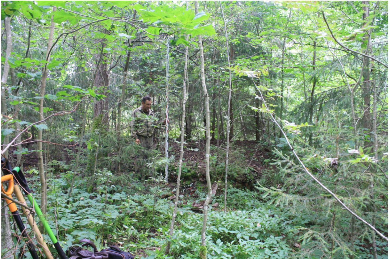
Илл. 15. Ленинградская область. Лужский муниципальный район, г. Луга. Участок с кадастровым номером 47:29:0103018:316. Точка фото-фиксации №1. Общий вид на остатки фундамента. Вид с северо-запада.
