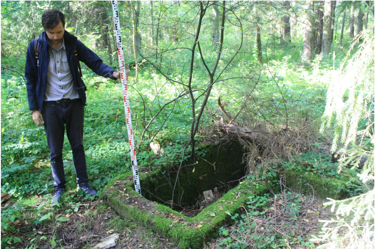
Илл. 31. Ленинградская область. Лужский муниципальный район. г. Луга. Участок с кадастровым номером 47:29:0103018:316. Точка фото-фиксации №12 Общий вид на южную часть обследованного участка, остатки «септика». Вид с северо-востока.
