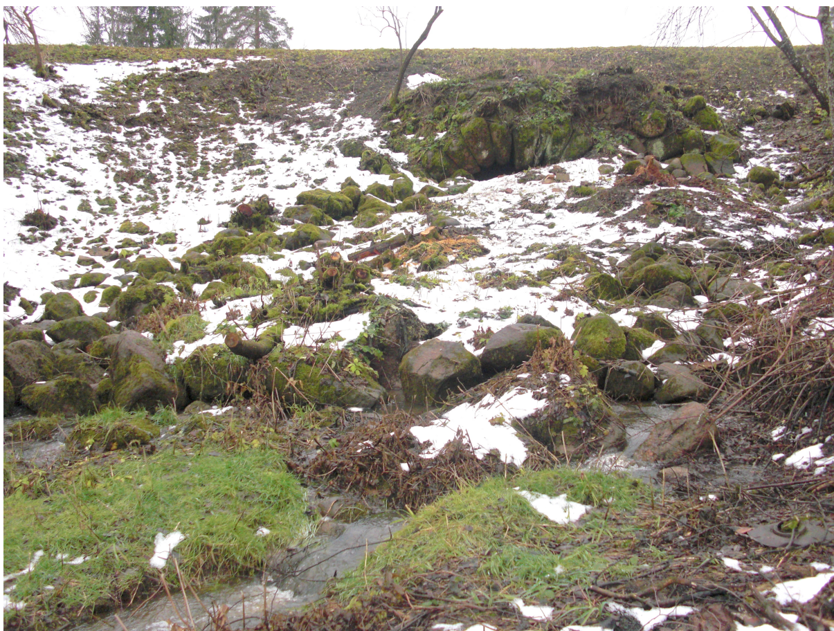
33. Завал у моста через Поваренный ручей. Фото 2008 г. (фотоархив собственника).
