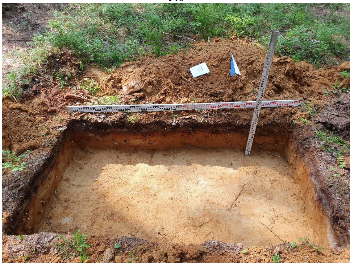
Рис. 286. ЛО-2021. Всеволожский район. Токсово. Шурф 13. Общий вид. Фиксация по материковой поверхности. Вид с Ю
