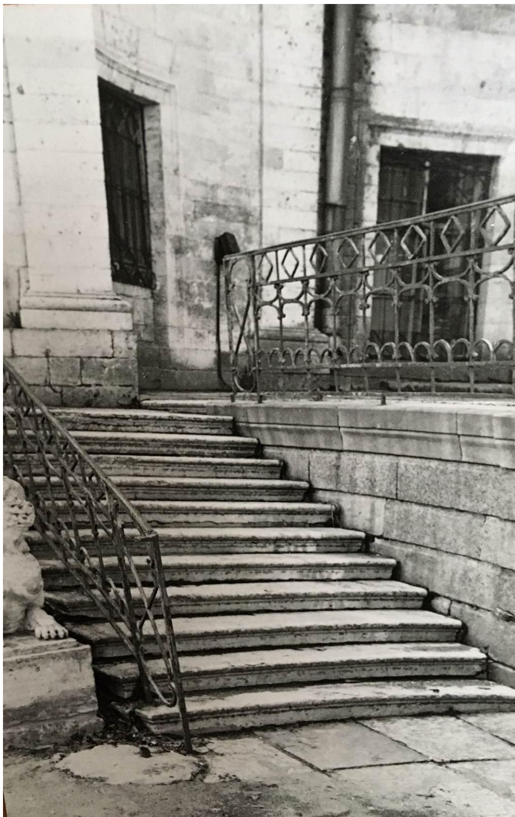
Илл. 120 Фото 1992 г. Выветривание швов, смещение ступеней и плит покрытия площадки. ГМЗ «Гатчина». Фототека. Папка с фотографиями «Собственный сад» [1.4.39]
