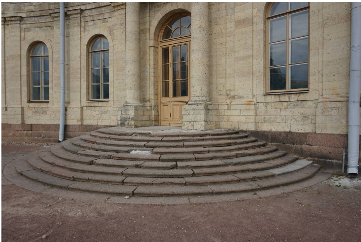
Фото 17. Крыльцо подлежащее реставрации.
