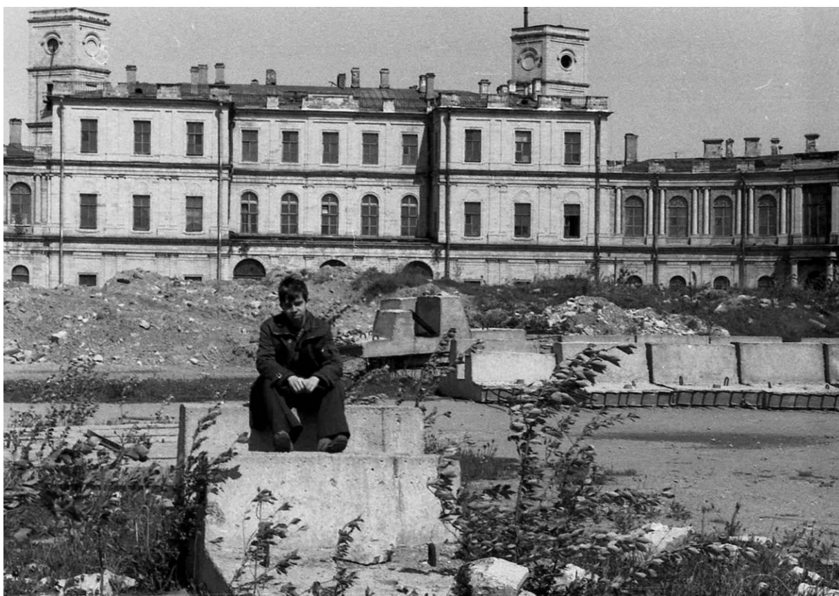
Илл. 45 Фото 1979. Пляц перед дворцом во время его ремонта и восстановления. «Гатчинский дворец» [Электронный ресурс] // Сообщество социальной сети - URL: https://vk.com/gatchina.palace (дата обращения 23.10.2021) [3.2.]
