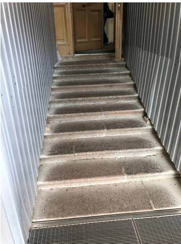
Фото 20. Крыльцо подлежащее реставрации.
