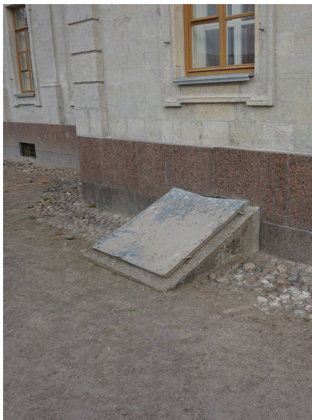
Фото 21. Прямок подлежащий демонтажу.
