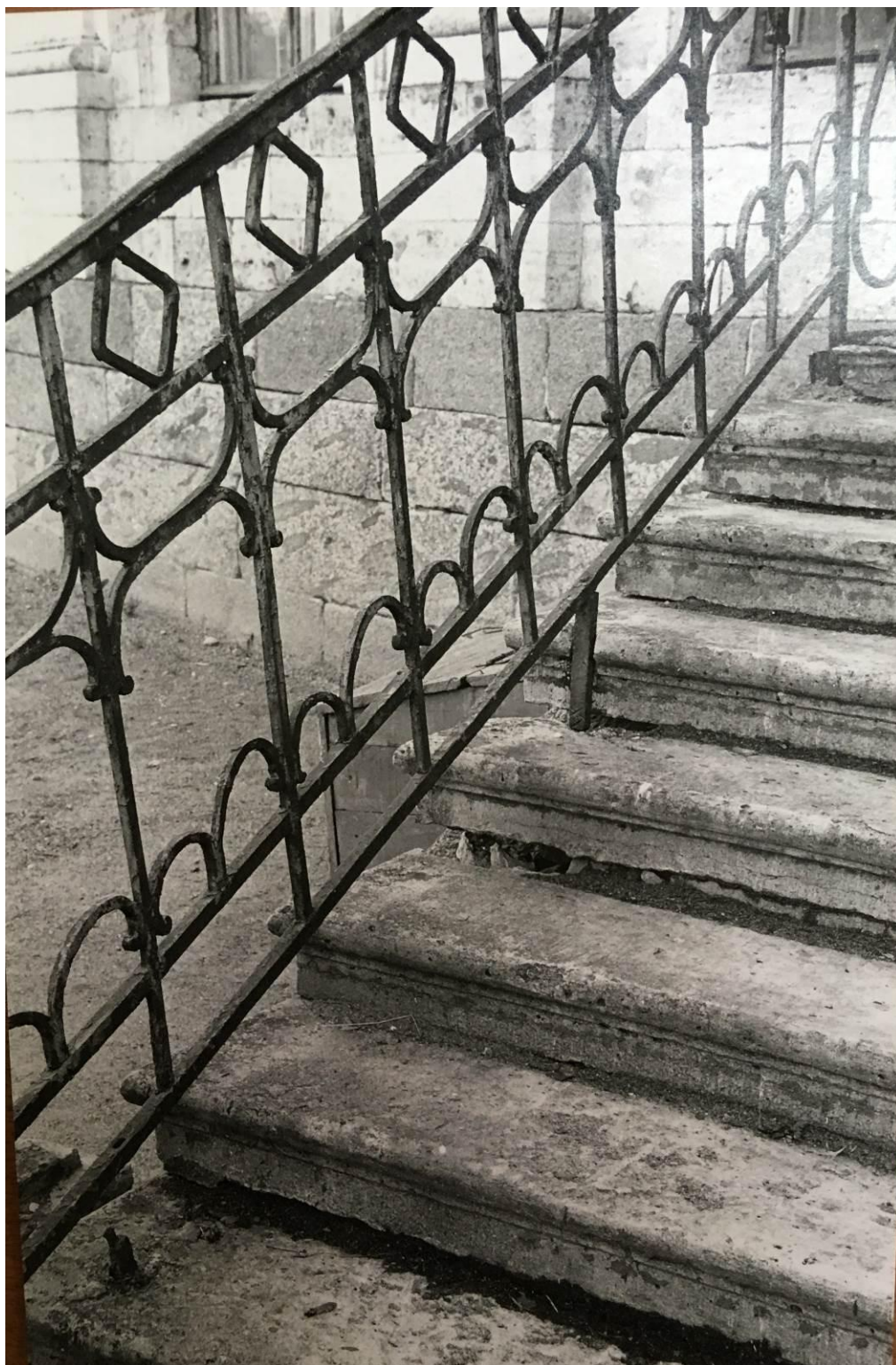
Илл. 119 Фото 1992 г. Изменение проектного положения ступеней, сколы. Устройство локальных подпорок ограждения хоз. методом. ГМЗ «Гатчина». № 1080. Собственный сад. Каменная терраса. Историческая справка. 1992. ТОО «Международный центр по возрождению Гатчинского дворцово-паркового ансамбля». [1.4.25]
