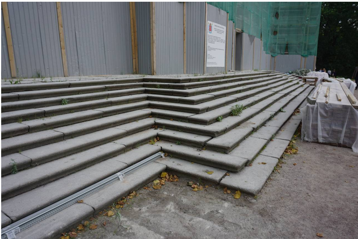
Фото 11. Крыльцо подлежащее реставрации.
