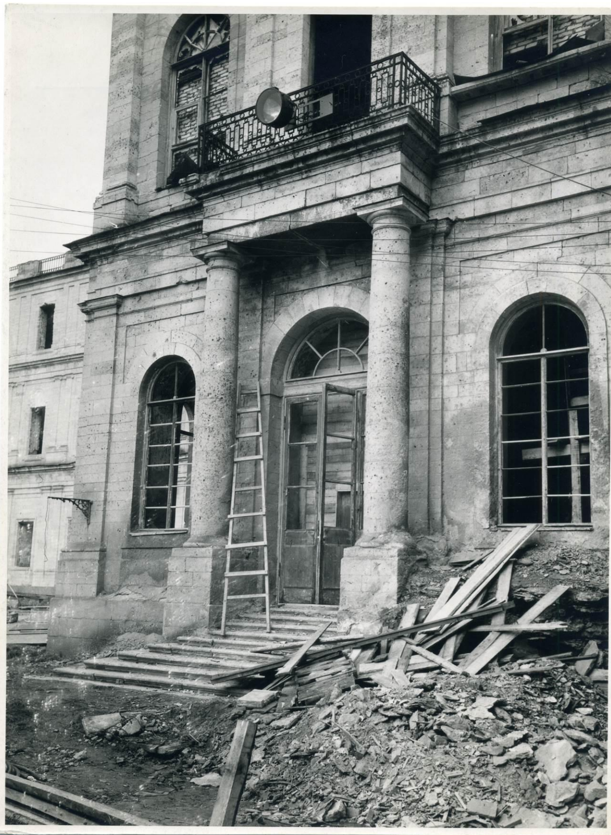
Илл. 141 Фото 1961 г. Ремонтно-реставрационные работы по дворцу. Наблюдаются пустые швы в ступенях, сколы. Марш завален строительным мусором. ГМЗ «Гатчина», Фототека 1960-1990 гг. [1.4.8].
