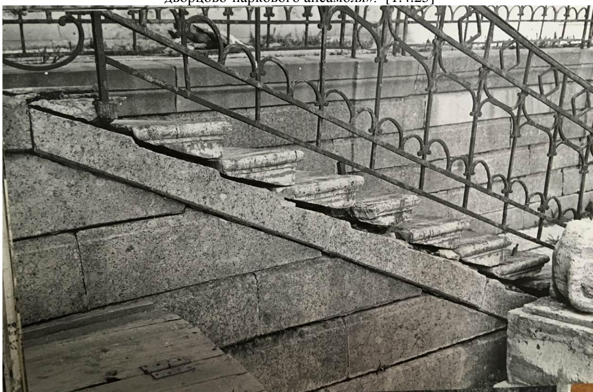
Илл. 117 Фото 1992 г. Утрата заделки зазора ступеней марша, отсутствует заделка швов облицовки террасы. ГМЗ «Гатчина». № 1080. Собственный сад. Каменная терраса. Историческая справка. 1992. ТОО «Международный центр по возрождению Гатчинского дворцово-паркового ансамбля». [1.4.25]
