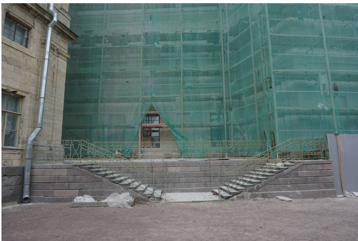
Фото 14. Крыльцо подлежащее реставрации.
