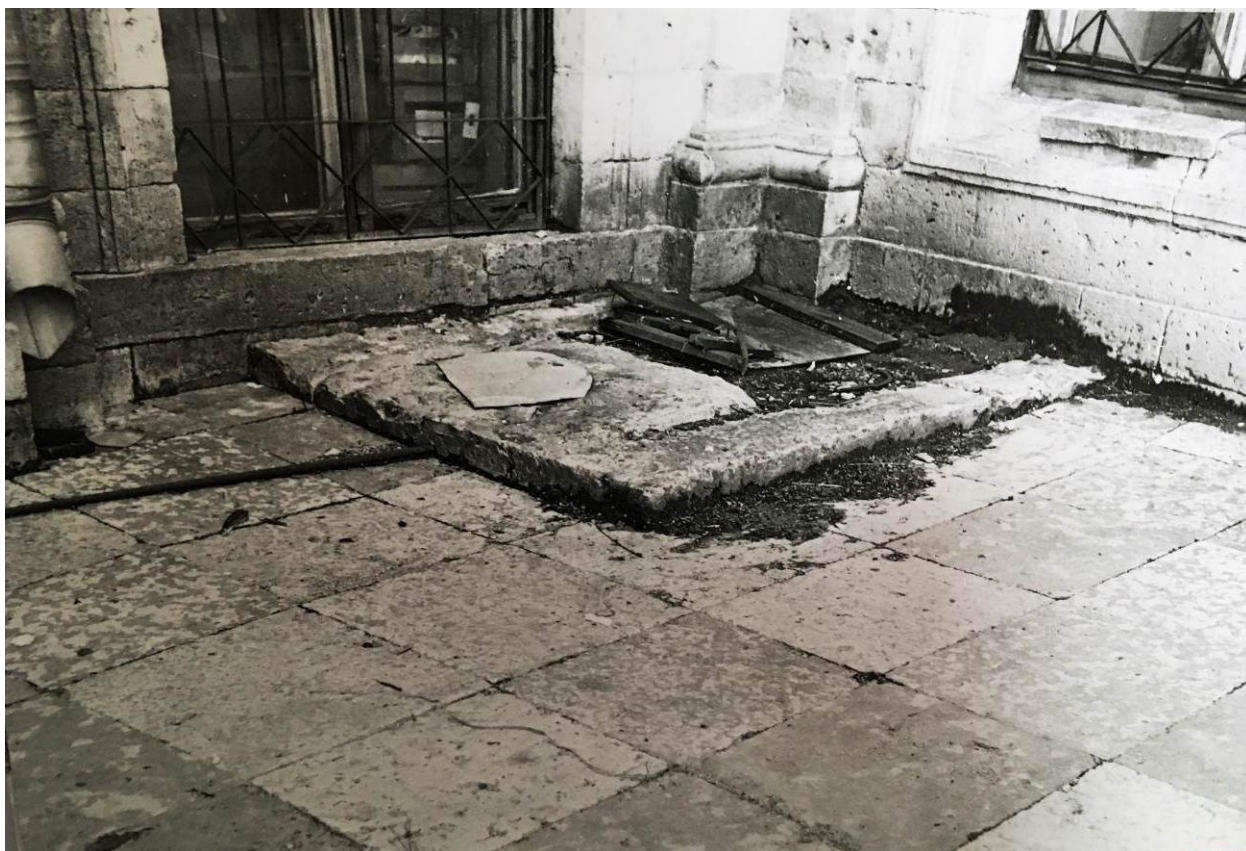
Илл. 121 Фото 1992 г. Вспучивание и деформация плит, их утрата. ГМЗ «Гатчина». № 1080. Собственный сад. Каменная терраса. Историческая справка. 1992. ТОО «Международный центр по возрождению Гатчинского дворцово-паркового ансамбля». [1.4.25]
