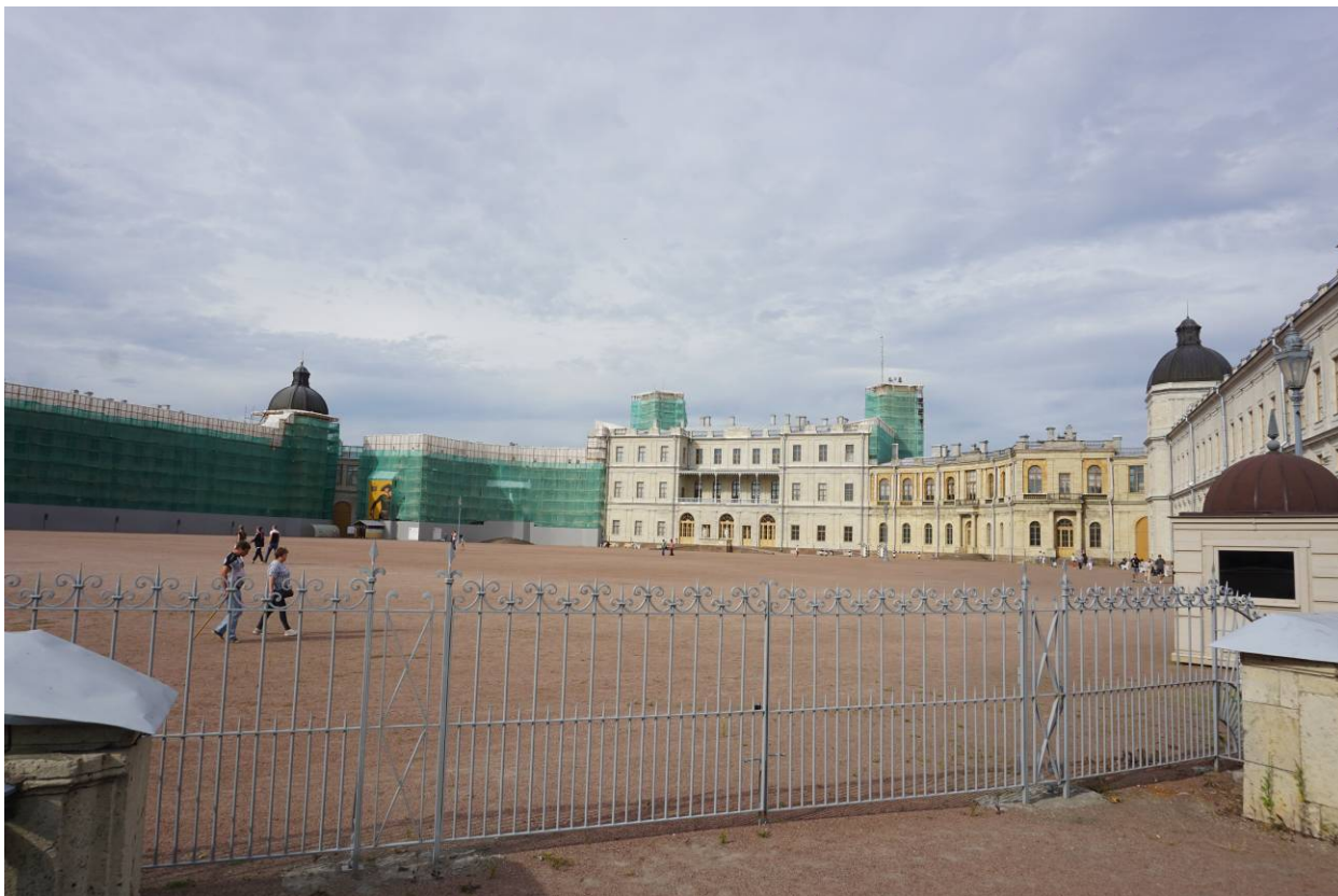
Фото 1. Общий вид объекта культурного наследия федерального значения «Гатчинский дворец (с Арсенальным и Кухонным каре)».
