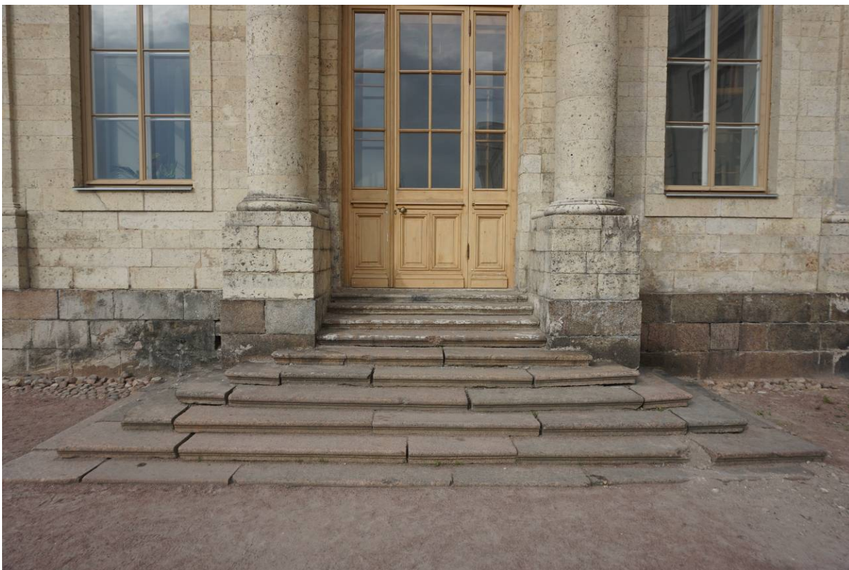
Фото 15. Крыльцо подлежащее реставрации.
