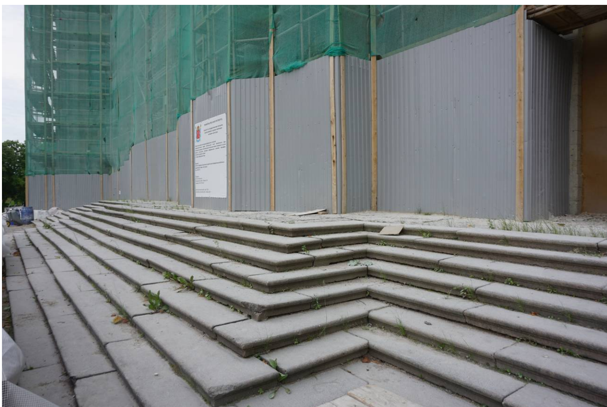
Фото 12. Крыльцо подлежащее реставрации.
