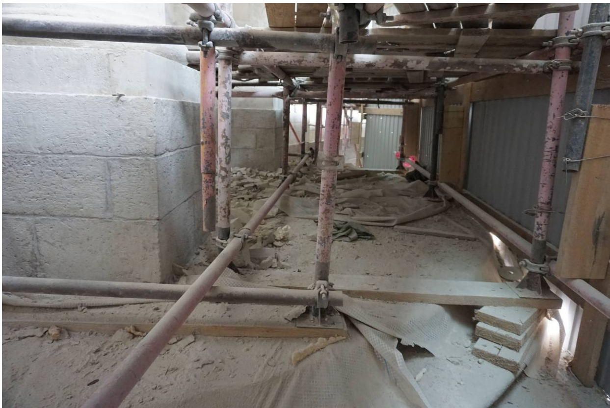
Фото 19. Крыльцо подлежащее реставрации.
