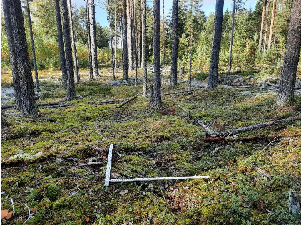
Рис. 80. Ленинградская обл., Лодейнопольский р-н, «Газопровод межпоселковый пос. Янега - дер. Харевщина - г.п. Свирьстрой Лодейнопольского района Ленинградской области». Шурф 5. До начала земляных работ. Вид с Ю.
