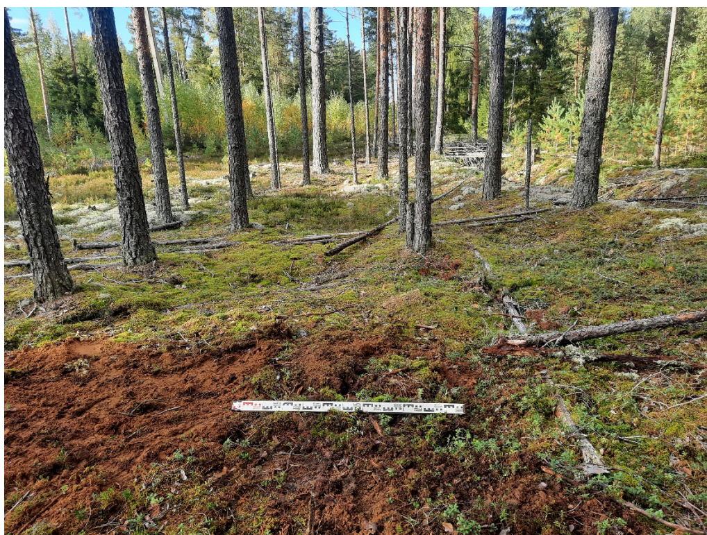
Рис. 83. Ленинградская обл., Лодейнопольский р-н, «Газопровод межпоселковый пос. Янега - дер. Харевщина - г.п. Свирьстрой Лодейнопольского района Ленинградской области». Шурф 5. Рекультивация. Вид с Ю.
