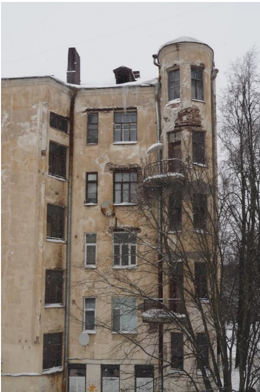
19. «Жилой дом с магазинами б. Горышина», Ленинградская область, Выборгский район, г. Выборг, Ленинградское шоссе, д.3. Дворовый фасад. Фрагмент. Фото 14.01.2022г.
