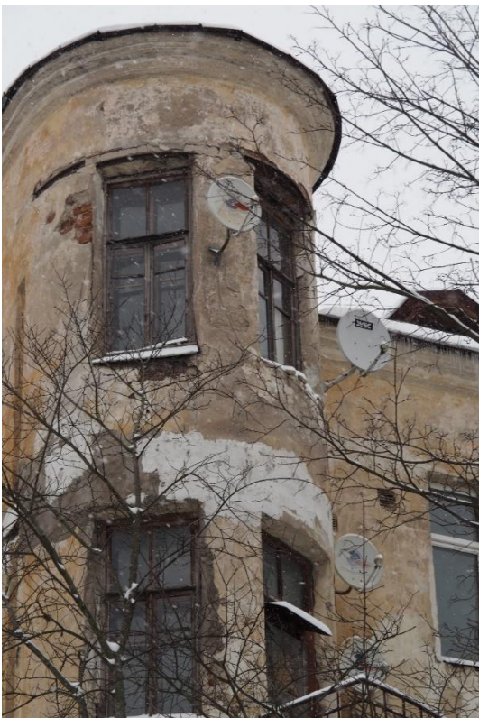
18. «Жилой дом с магазинами б. Горышина», Ленинградская область, Выборгский район, г. Выборг, Ленинградское шоссе, д.3. Дворовый фасад. Фрагмент. Фото 14.01.2022г.
