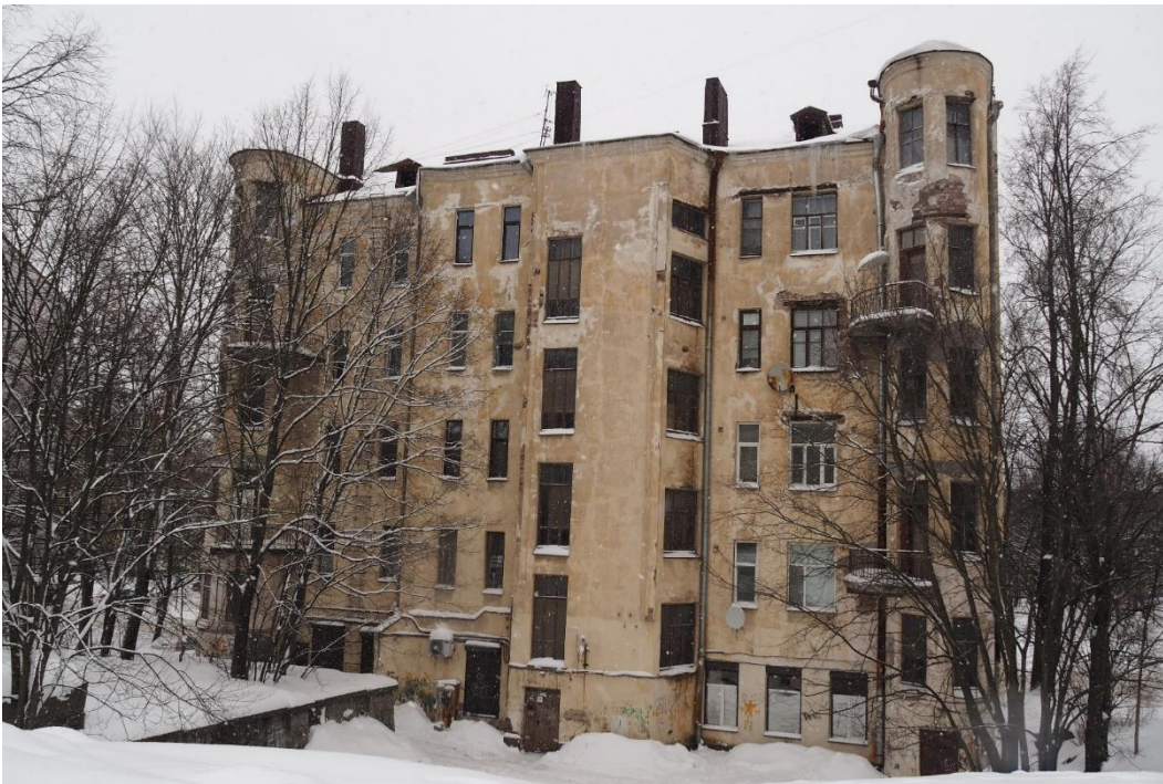
15. «Жилой дом с магазинами б. Горышина», Ленинградская область, Выборгский район, г. Выборг, Ленинградское шоссе, д.3. Дворовый фасад. Общий вид. Фото 14.01.2022г.
