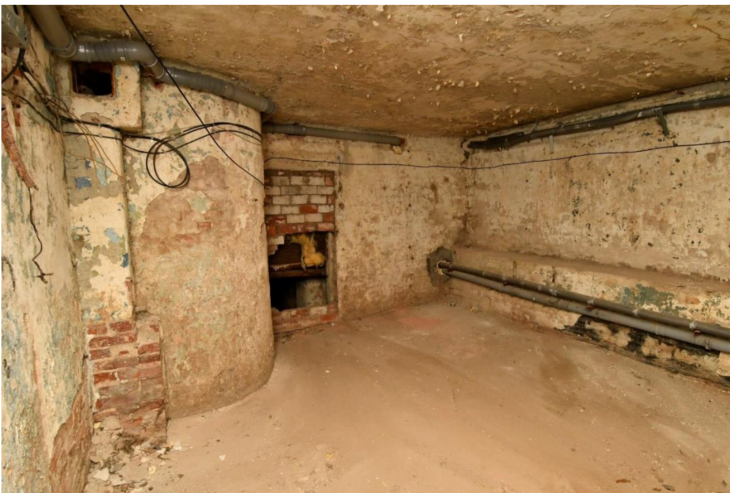
30. «Жилой дом», Ленинградская область, Выборгский район, г. Выборг, пр. Ленина, д. 18. Подвал. Общий вид. Фото 14.01.2022г.
