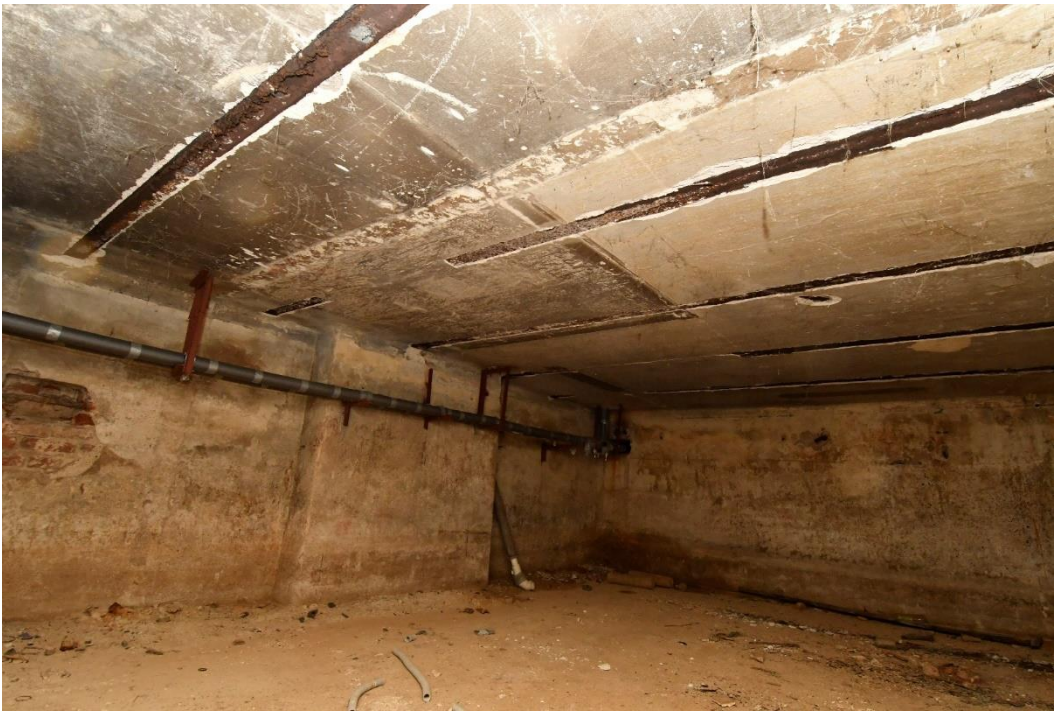
33. «Жилой дом», Ленинградская область, Выборгский район, г. Выборг, пр. Ленина, д. 18. Подвал. Общий вид. Фото 14.01.2022г.
