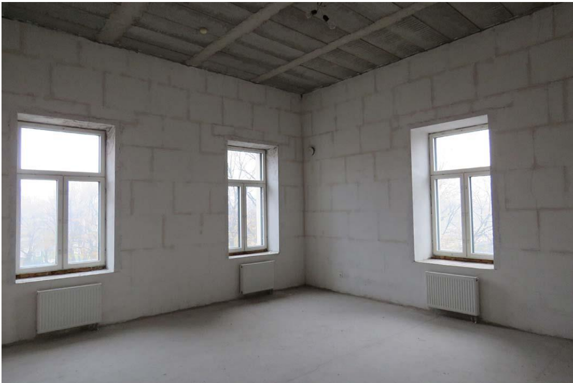
Фото 7. Квартира № 4. Пом. 3. Общий вид помещения с востока. Дата съемки: 14.04.2022 г. Автор: Глинская Н.Б.
