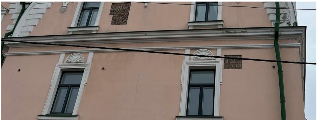
Фото 3. Фрагмент 3-го этажа уличного северо-западного фасада, соответствующего помещениям квартиры № 4. Дата съемки: 14.04.2022 г. Автор: Глинская Н.Б.
