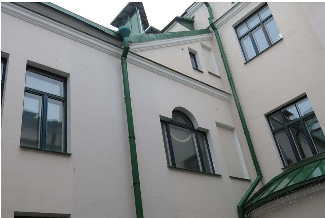
Фото 6. Фрагмент дворового северо-восточного фасада старого объема здания, соответствующего помещению № 6 квартиры № 4. Дата съемки: 14.04.2022 г. Автор: Глинская Н.Б.
