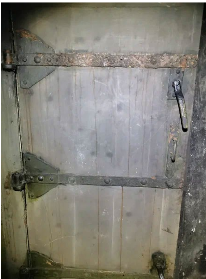
3. Интерьер нижнего яруса, дверь в помещение для отдыха личного состава. ДОТ № 441. Фото: 08.11.21
