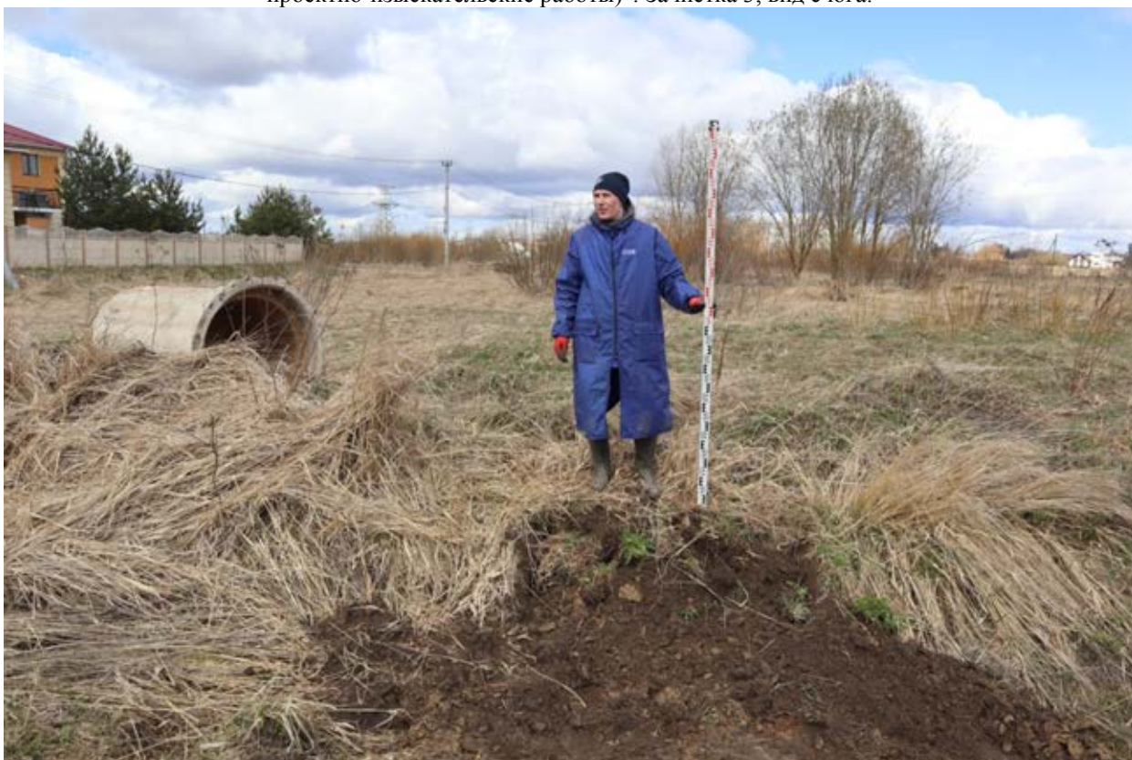
Рис.41. Ленинградская область. Гатчинский район. д.Вайя. Объект "Распределительный газопровод для газоснабжения жилых домов д. Вайя Гатчинского района Ленинградской области (1 этап, в том числе проектно-изыскательские работы)". Зачистка 3, вид с юга после рекультивации.
