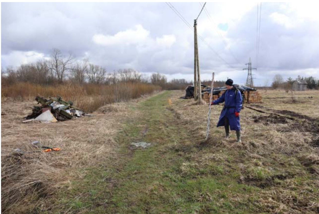
Рис.18. Ленинградская область. Гатчинский район. д.Вайя. Объект "Распределительный газопровод для газоснабжения жилых домов д. Вайя Гатчинского района Ленинградской области (1 этап, в том числе проектно-изыскательские работы)". Точка фотофиксации 3, вид с северо-запада.
