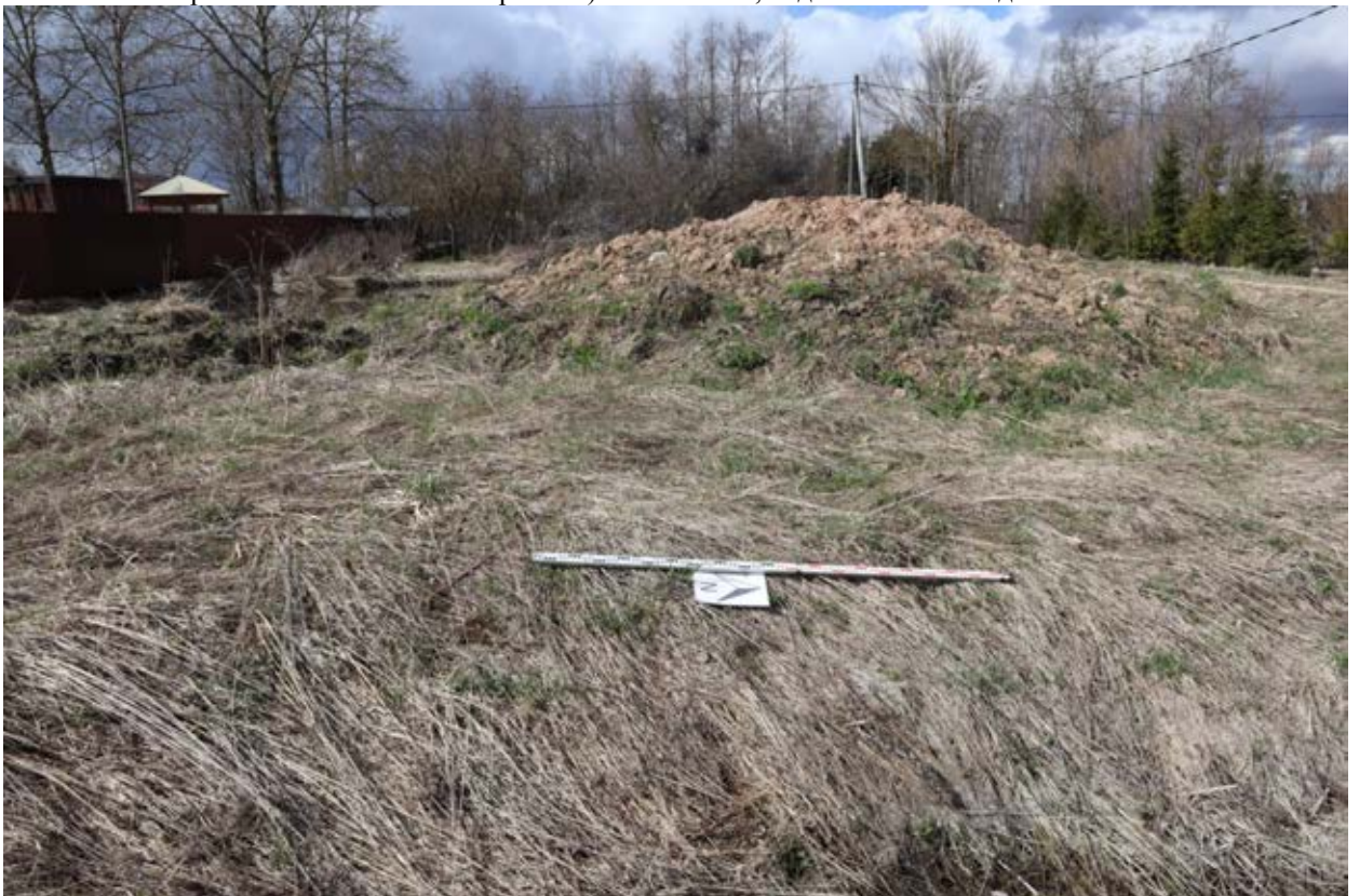
Рис.43. Ленинградская область. Гатчинский район. д.Вайя. Объект "Распределительный газопровод для газоснабжения жилых домов д. Вайя Гатчинского района Ленинградской области (1 этап, в том числе проектно-изыскательские работы)". Зачистка 4, вид на место закладки с востока.
