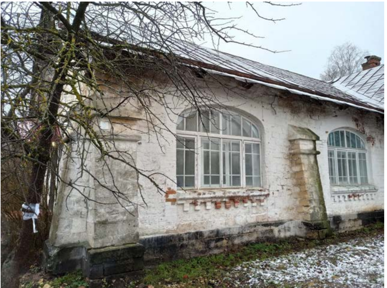
46. Фрагмент фасада здания каменной дачи (административное здание) . Оформление оконных проемов. Вид с востока
