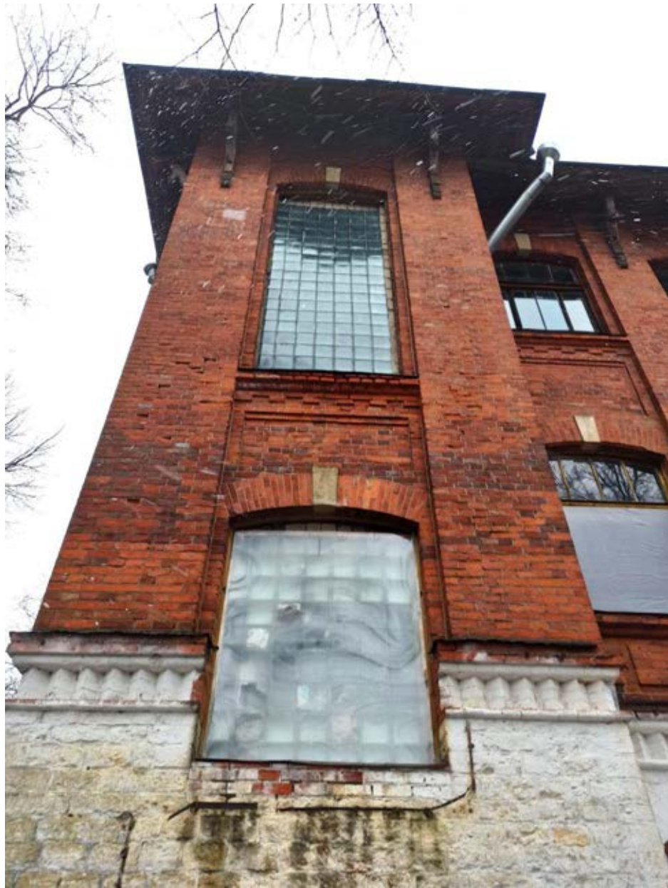
15. Фрагмент фасада здания сельскохозяйственного (земского) училища. Оформление оконных проемов. Вид с юго-востока
