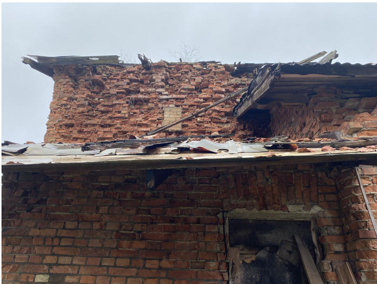
Фото 13. Аварийное состояние кровли и кирпичной кладки.
