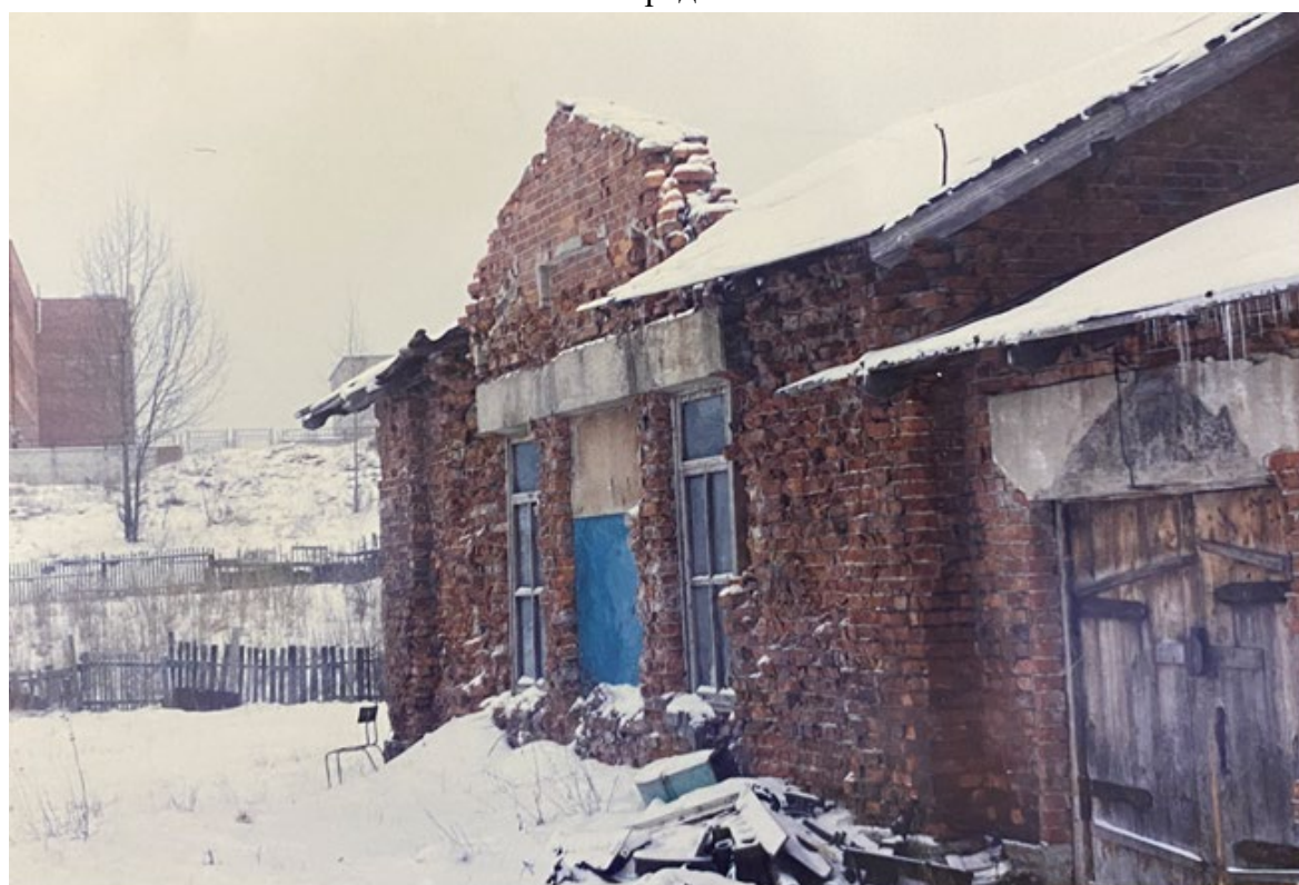
26. г. Сосновый Бор. Насосная станция. // Источник: Материалы архива Комитета Ленинградской области
