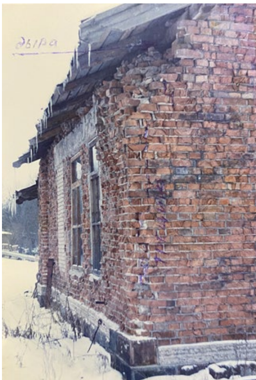
33. г. Сосновый Бор. Насосная станция. // Источник: Материалы архива Комитета Ленинградской области
