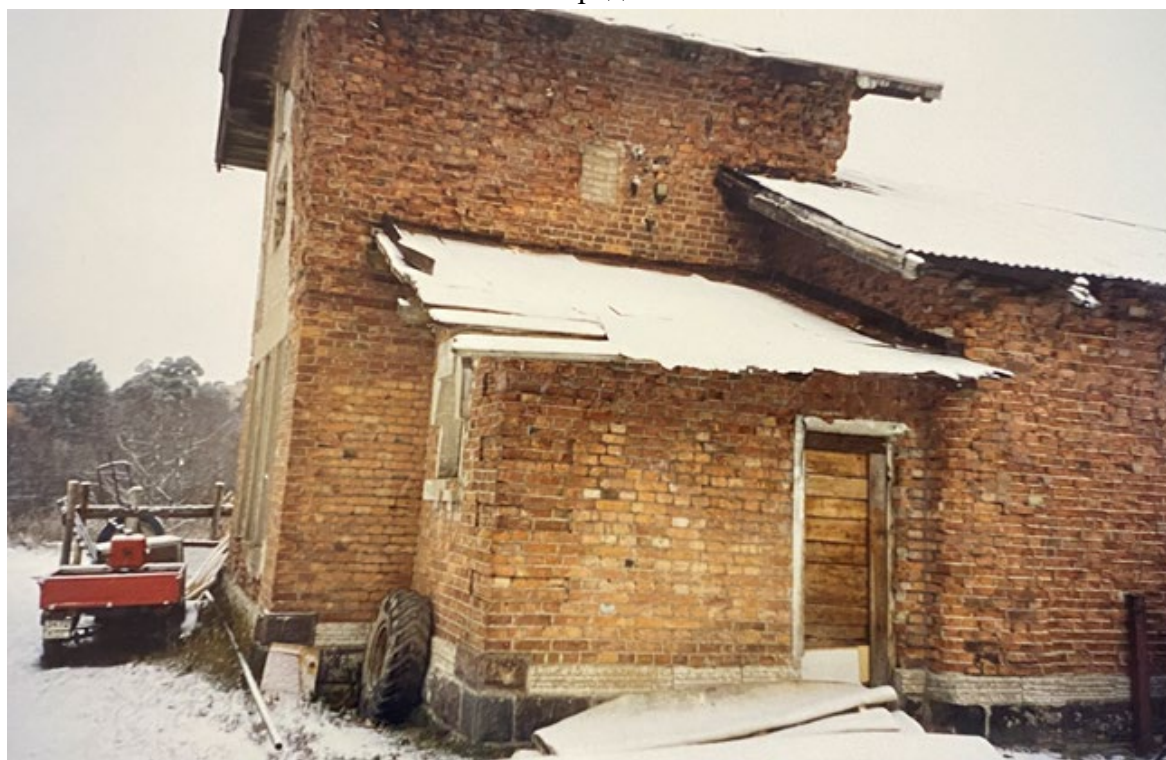
30. г. Сосновый Бор. Насосная станция. // Источник: Материалы архива Комитета Ленинградской области
