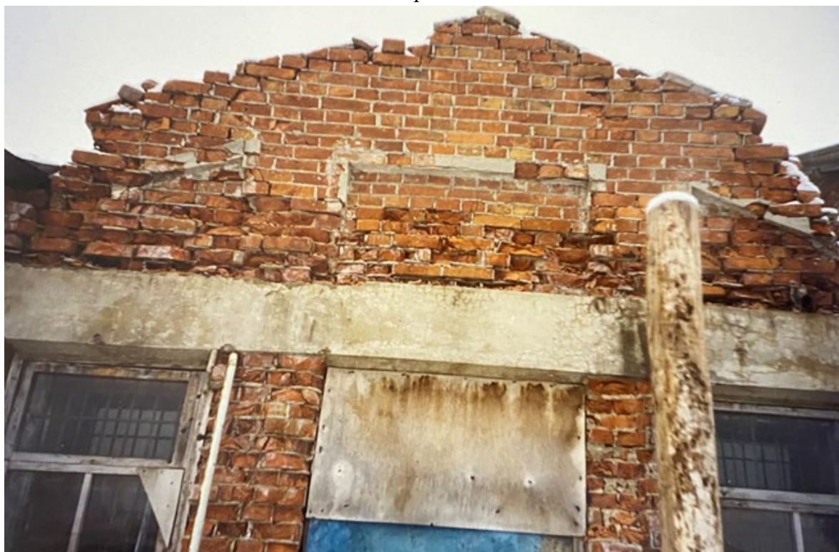
28. г. Сосновый Бор. Насосная станция. // Источник: Материалы архива Комитета Ленинградской области
