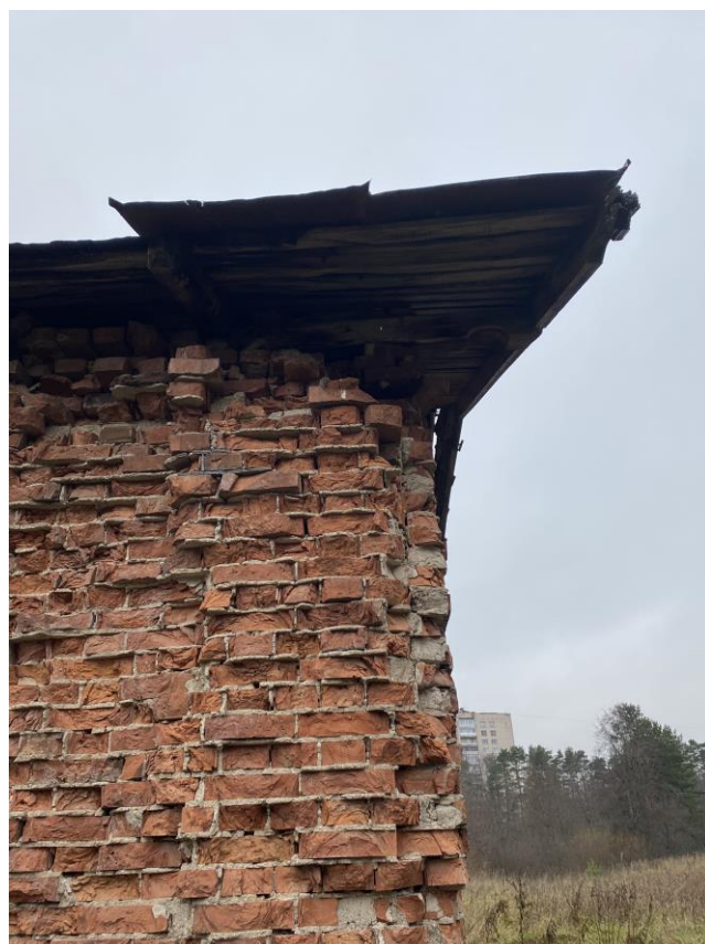
Фото 19. Аварийное состояние кирпичной кладки.
