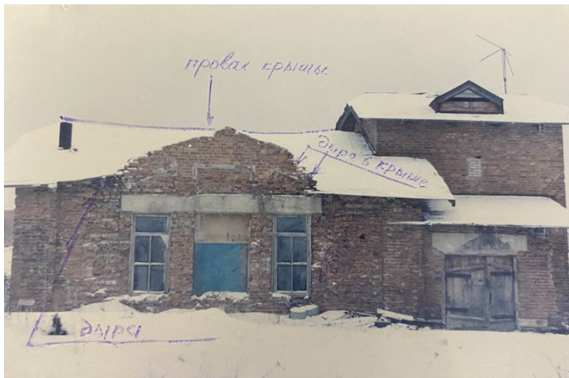
25. г. Сосновый Бор. Насосная станция. // Источник: Материалы архива Комитета Ленинградской области
