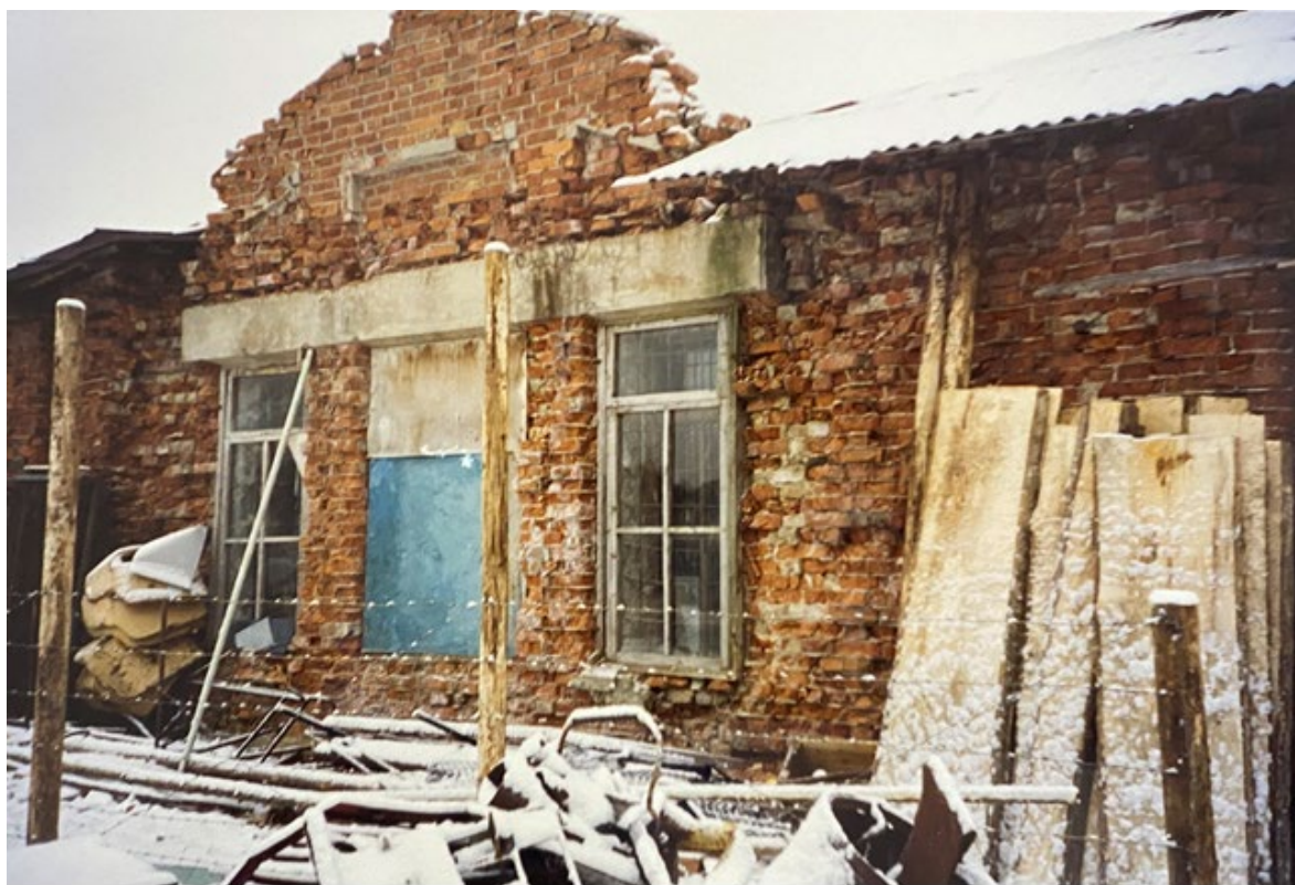
31. г. Сосновый Бор. Насосная станция. // Источник: Материалы архива Комитета Ленинградской области
