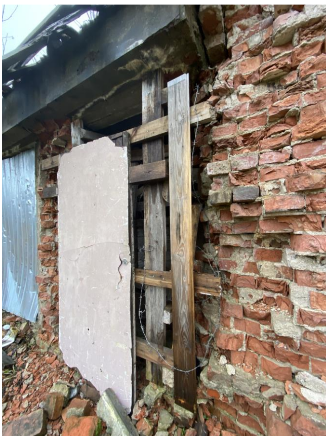
Фото 18. Утраченные оконные заполнения
