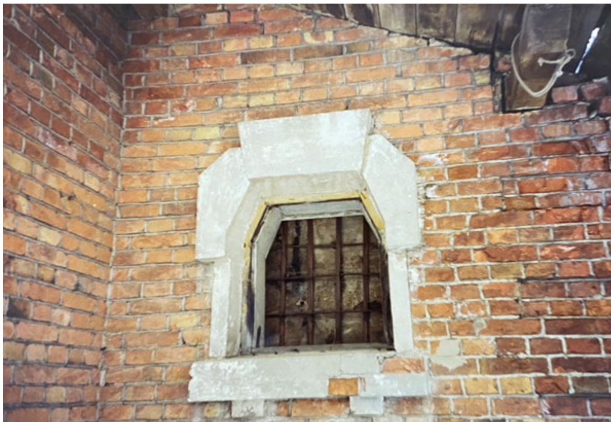
39. г. Сосновый Бор. Насосная станция. // Источник: Материалы архива Комитета Ленинградской области
