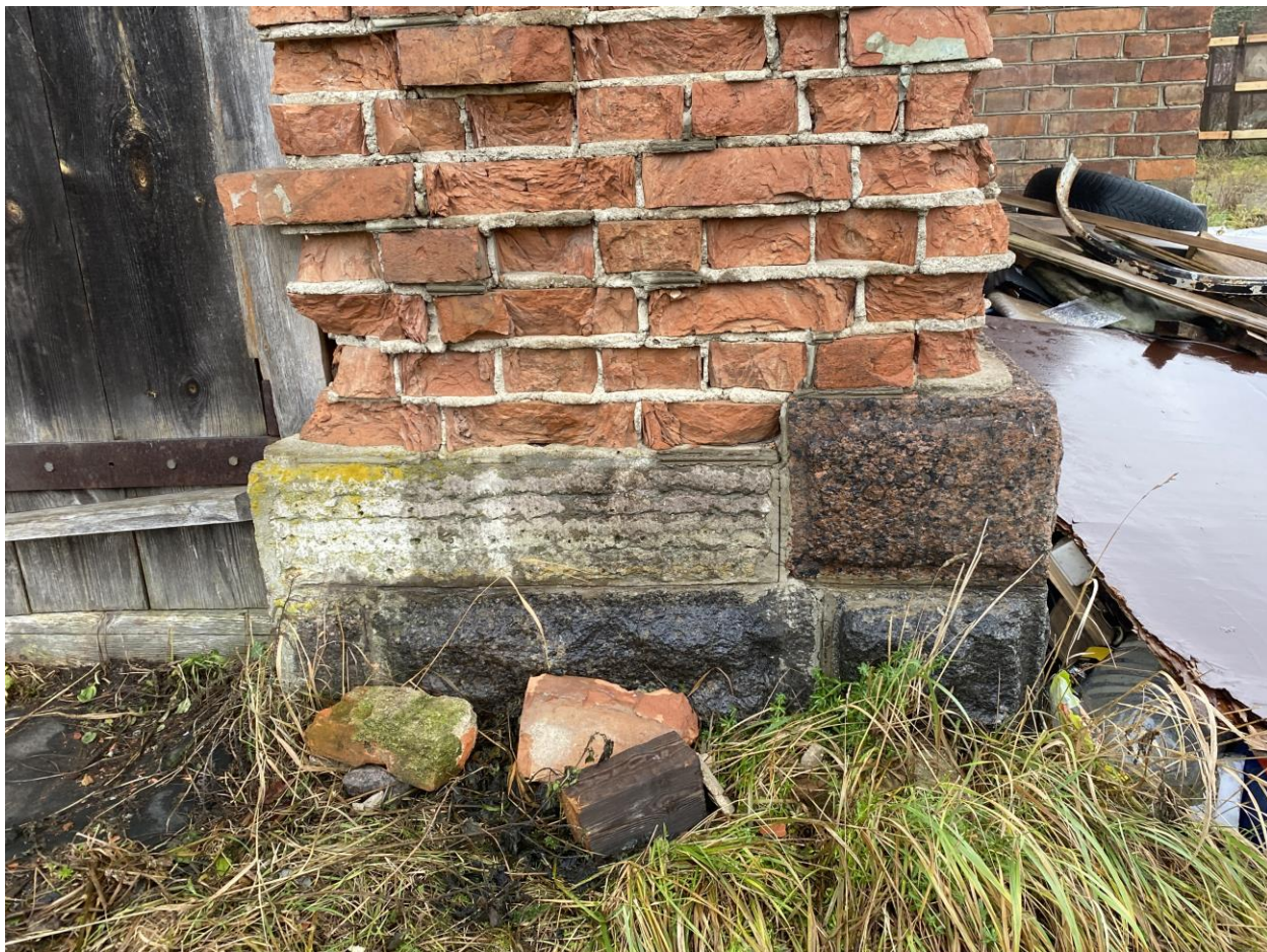
Фото 12. Цоколь, облицованный по нижнему ряду грубоотесанными гранитными блоками, по верхнему ряду – известняком; углы цоколя акцентированы двумя рядами гранита.
