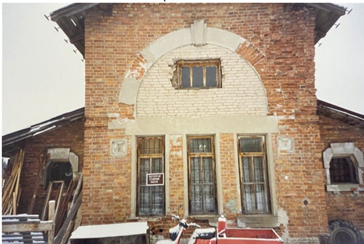
38. г. Сосновый Бор. Насосная станция. // Источник: Материалы архива Комитета Ленинградской области
