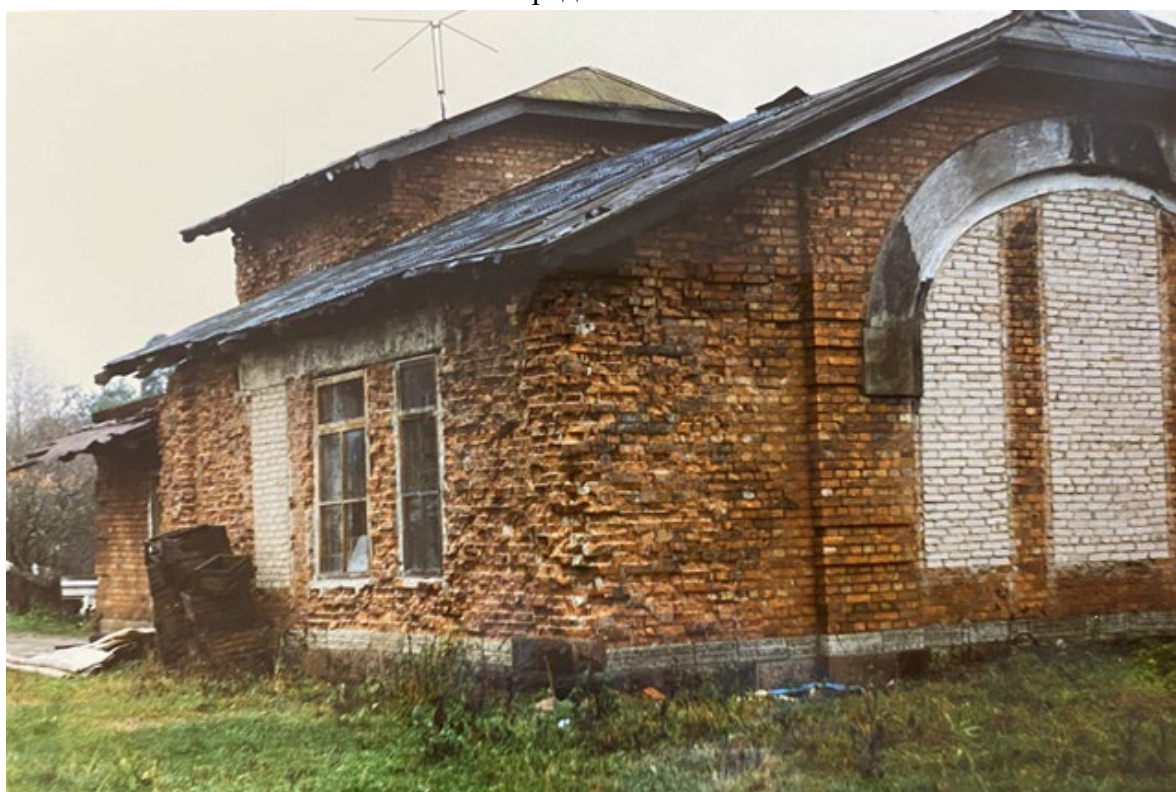
44. г. Сосновый Бор. Насосная станция. // Источник: Материалы архива Комитета Ленинградской области
