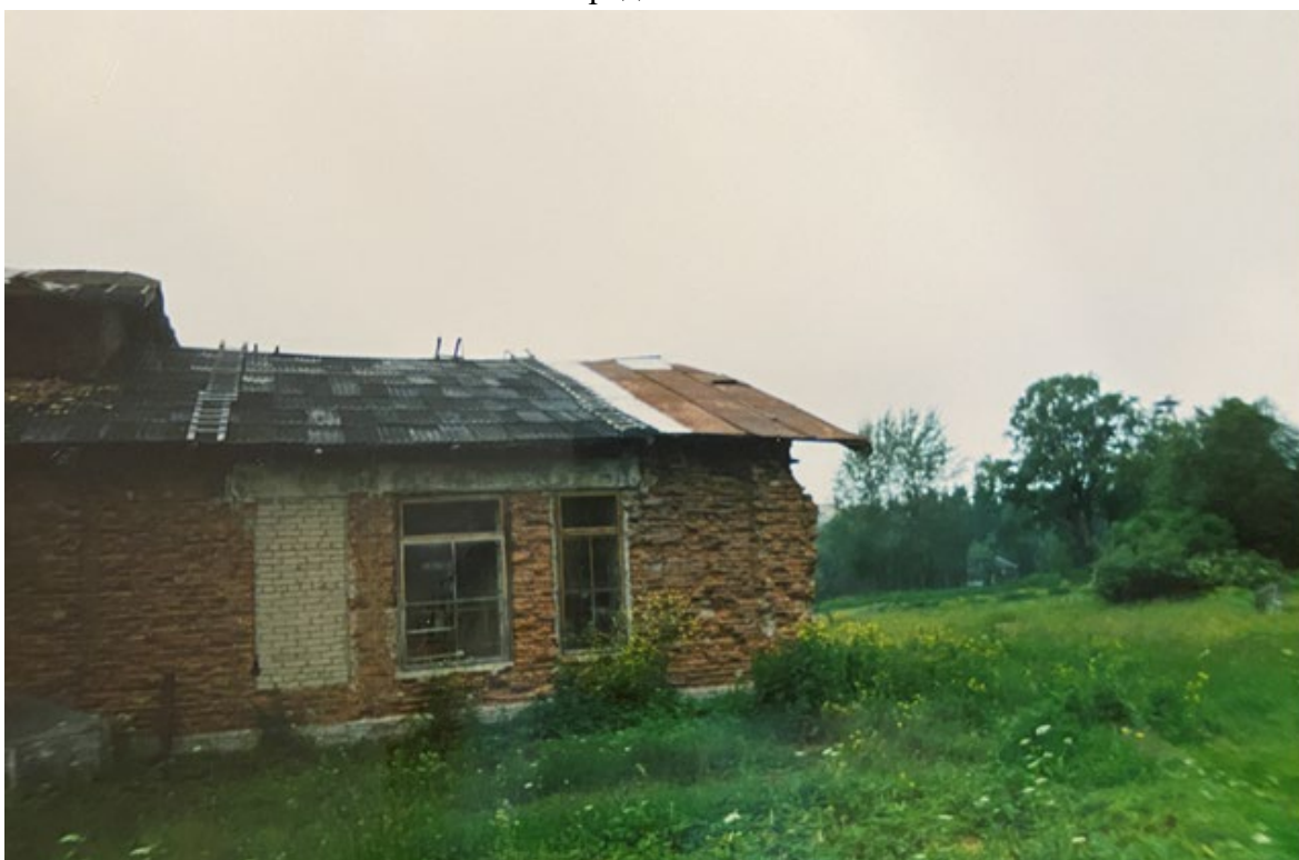
42. г. Сосновый Бор. Насосная станция. // Источник: Материалы архива Комитета Ленинградской области
