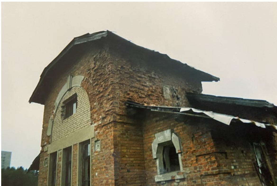
41. г. Сосновый Бор. Насосная станция. // Источник: Материалы архива Комитета Ленинградской области
