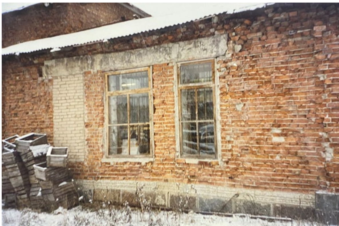
37. г. Сосновый Бор. Насосная станция. // Источник: Материалы архива Комитета Ленинградской области
