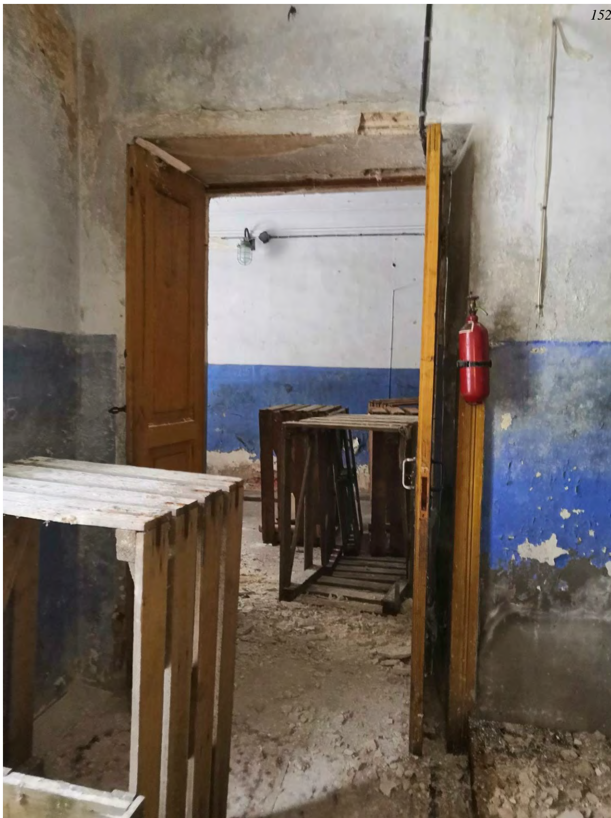
Фото.109. Казарма (расположена в центре территории военной части). Центральная часть. Ощий вид на помещение. Первый этаж.
