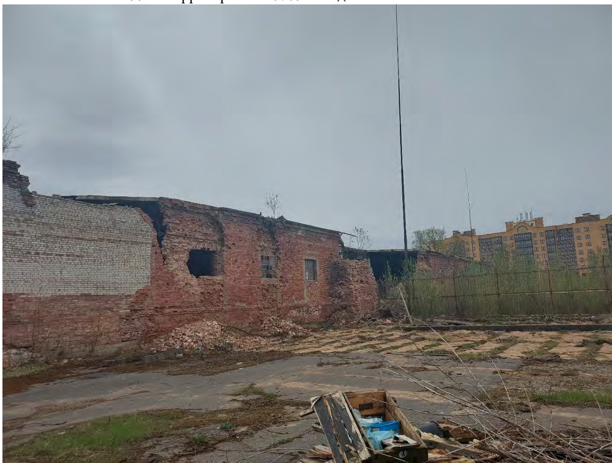
Фото.256. Территория в/ч 67651. Вид на руинированный объект.
