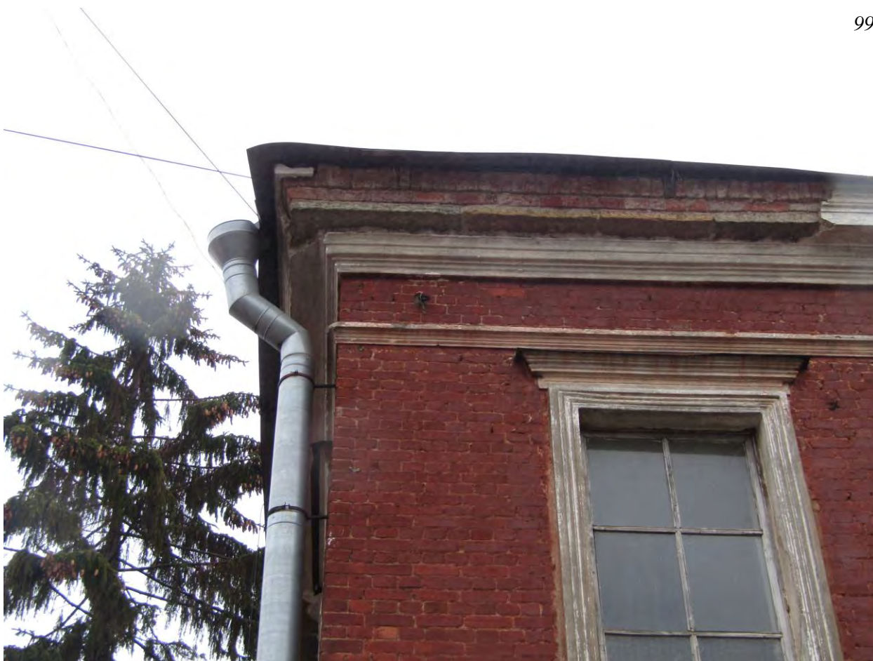
Фото.9. Здание офицерского собрания (г. Гатчина, улица 7-й Армии, 8А). Вид на карниз.
