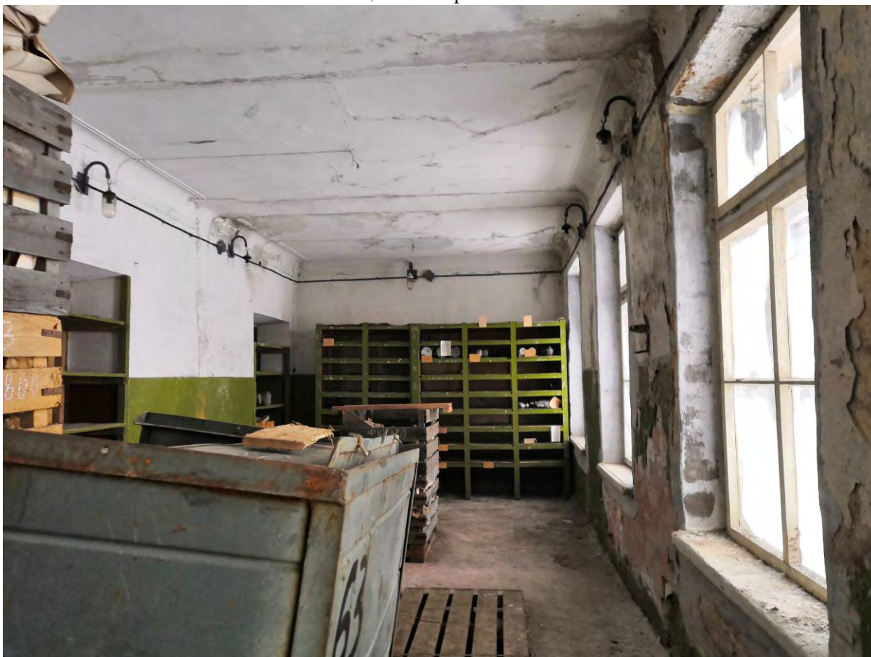
Фото.95. Казарма (расположена в центре территории военной части). Западная часть. Вид на складское помещение. Первый этаж.
