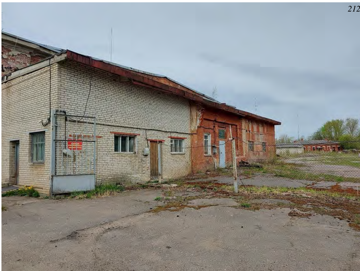
Фото.221. Территория в/ч 67651. Вид на руинированное здание.
