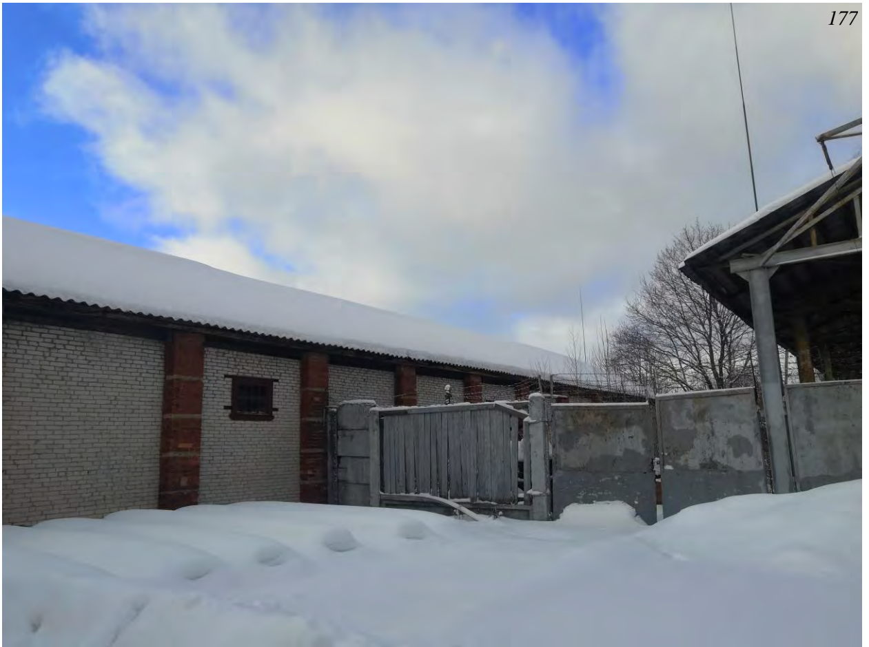
Фото.158. Артиллерийский сарай (расположено на внутренней территории военной части). Вид на северо-восточный фасад. Фрагмент.
