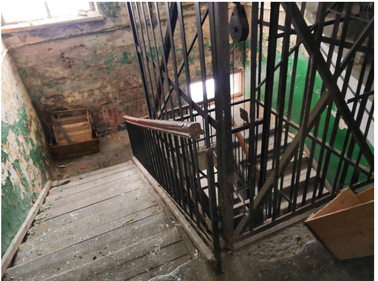
Фото.102. Казарма (расположена в центре территории военной части). Вид на западную ЛК. Второй этаж.
