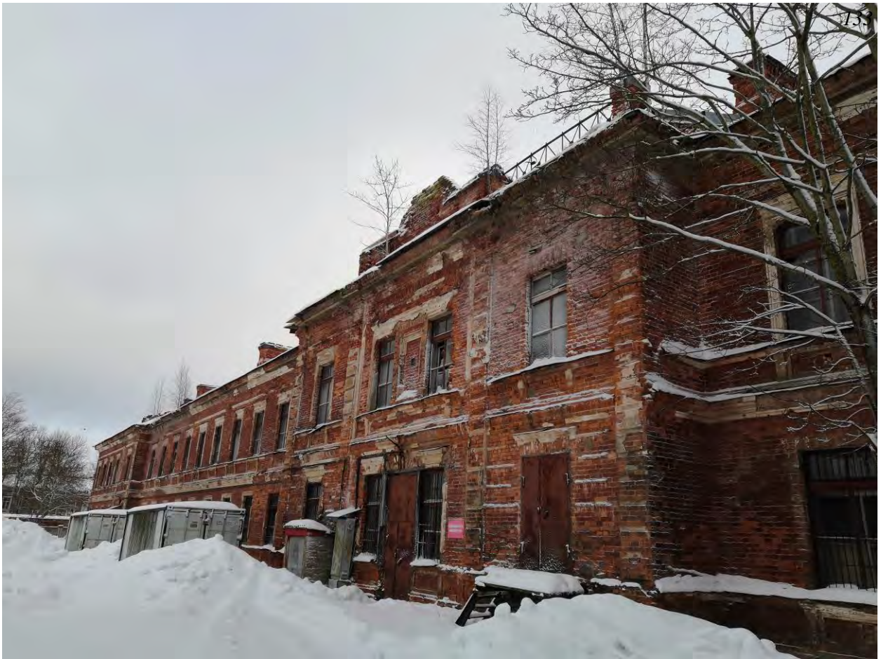
Казарма (расположена в центре территории военной части). Вид на северо-западный фасад. Фрагмент.
