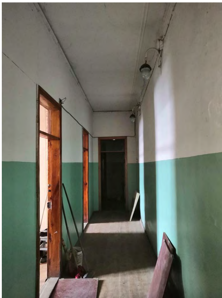
Фото.88. Казарма (расположена в центре территории военной части). Восточная часть. Вид на коридор. Первый этаж.
