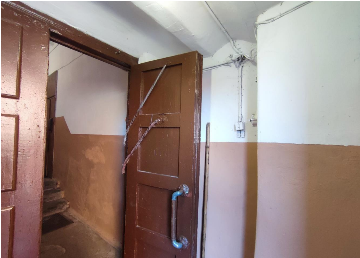
Фото 6. Тамбур лестничной клетки ЛК-3. Вскрыта распределительная коробка. Дата съемки: 11.04.2022 г. Автор: Глинская Н.Б.
