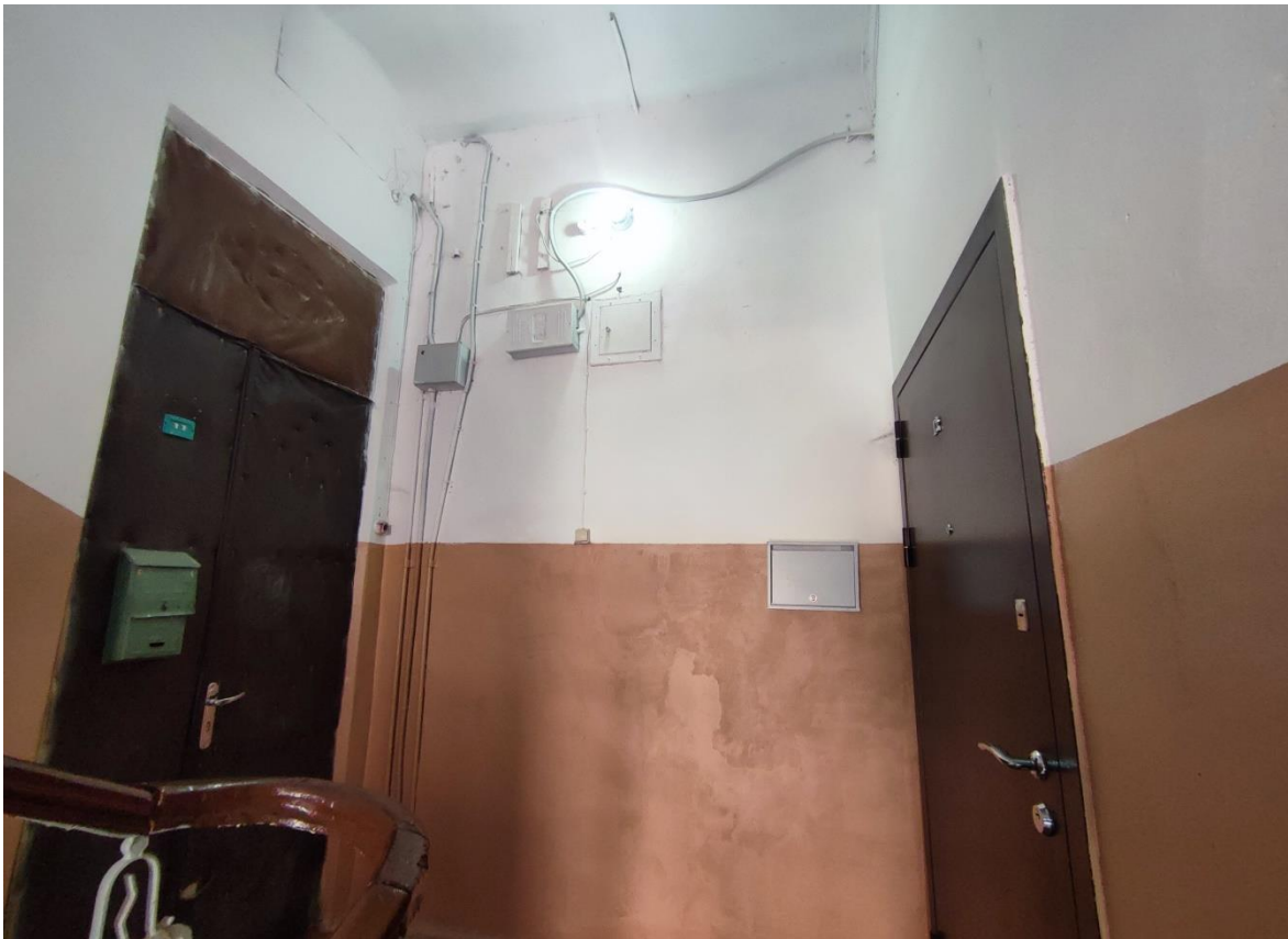
Фото 9. 2-ой этаж лестничной клетки ЛК-3. Расположение электропроводки по стенам с нарушением способа прокладки.
