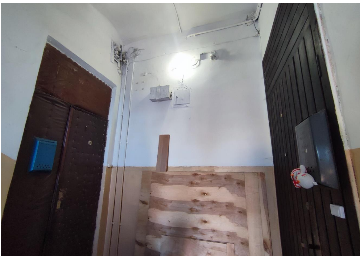
Фото 8. 2-ой этаж лестничной клетки ЛК-1. Расположение электропроводки по стенам с нарушением способа прокладки. Дата съемки: 11.04.2022 г. Автор: Глинская Н.Б.
