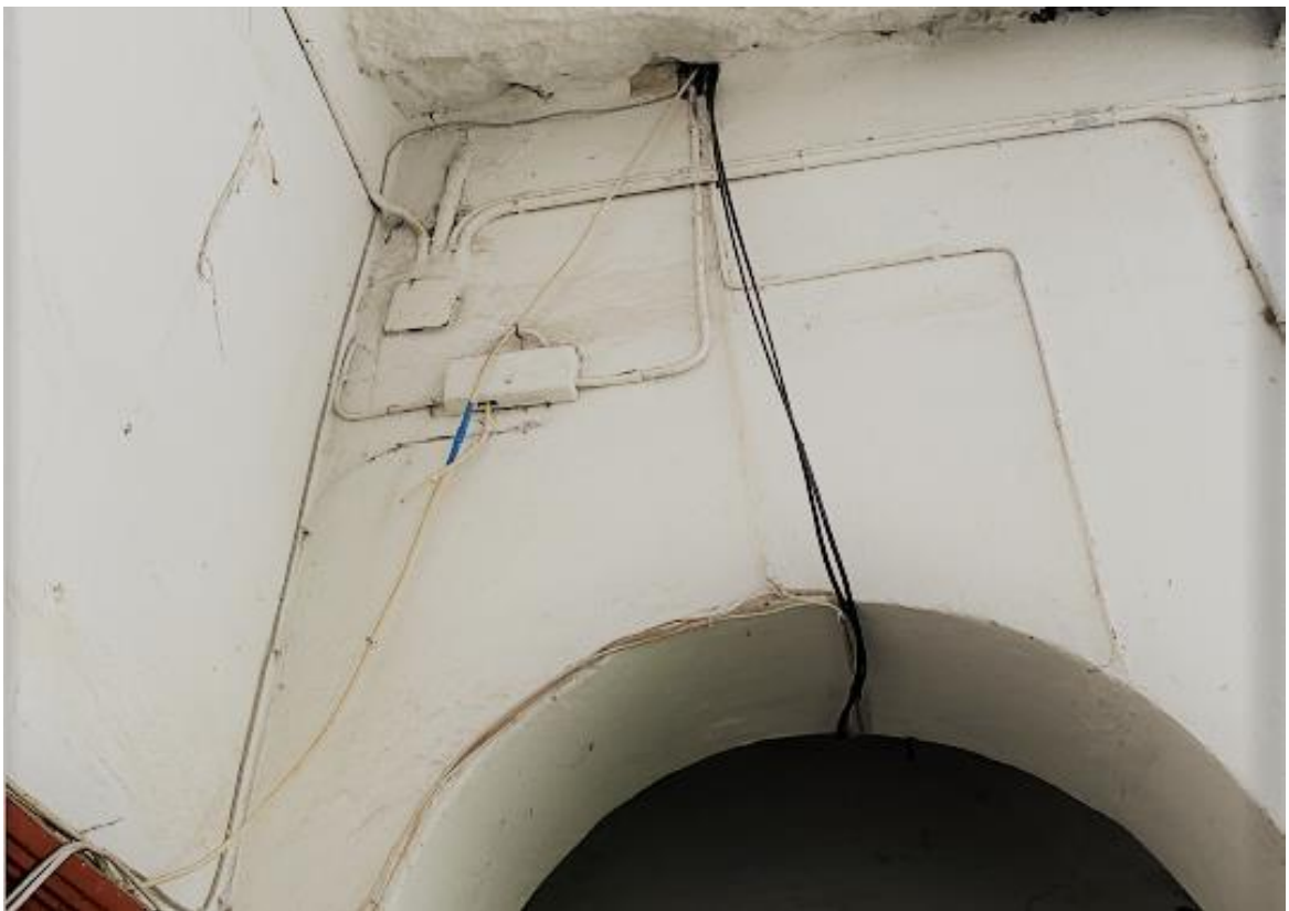
Фото 8. 1-ый этаж лестничной клетки ЛК-2. Расположение электропроводки по стенам с нарушением способа прокладки. Дата съемки: 11.04.2022 г. Автор: Прокофьев М.Ф.
