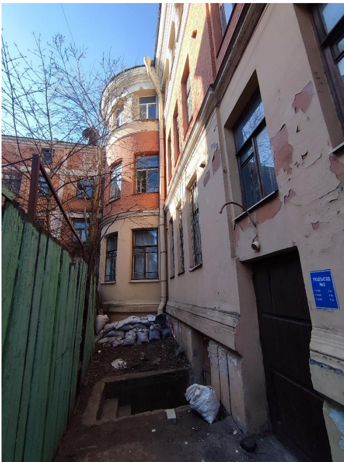
Фото 4. Фрагмент дворового фасада здания. Вид с юго-запада. Дата съемки: 11.04.2022 г. Автор: Прокофьев М.Ф.
