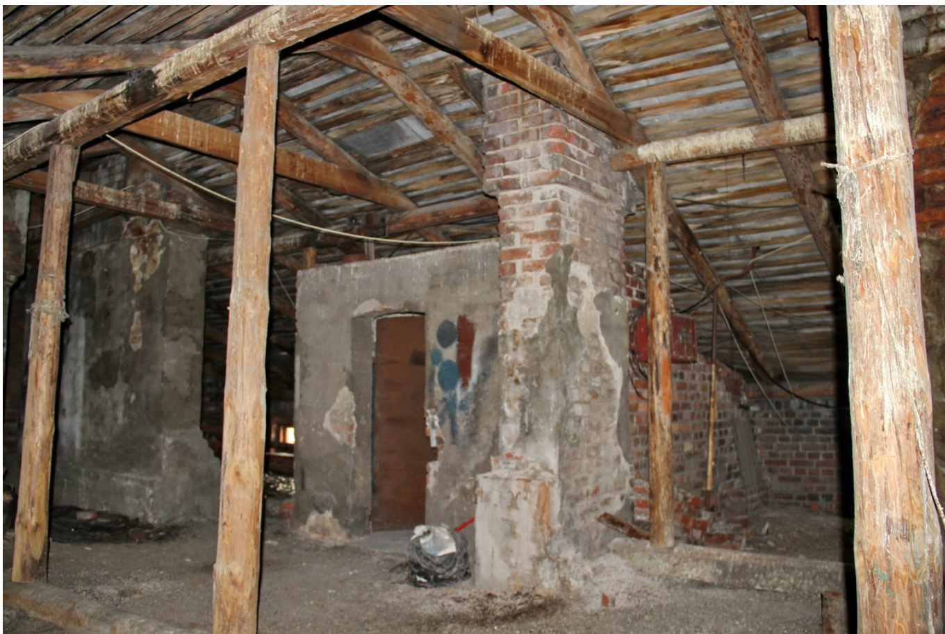
6 ОКН регионального значения “Жилой дом б. И. Науккаринена” ул. Титова, д. 4. Чердак. Дата съемки: 13.10.2021 г.
