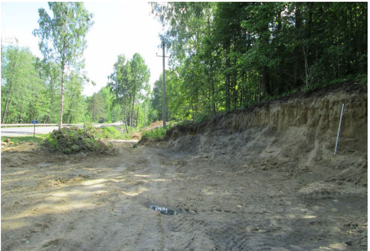
Илл. 44. Ленинградская область, Всеволожский район. Трасса проектируемой реконструкции автомобильной дороги А-181. Точка фотофиксации Ф7. Для масштаба использована нивелировочная рейка длиной 2 м.
