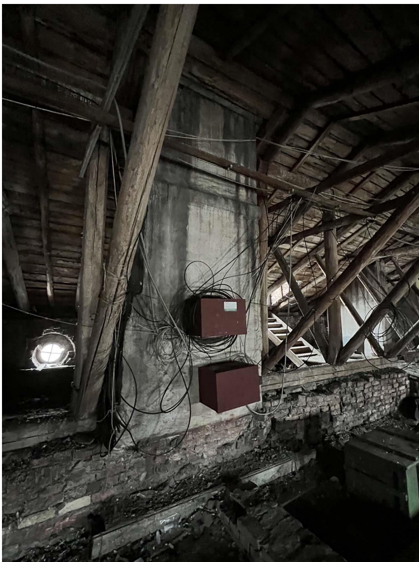
Фото 20. Чердак. Помещение в юго-восточной половине здания. Крепление электрощитов к стене вентиляционной шахты. Дата съемки: 11.04.2022 г. Автор: Куваева Ю.П.
