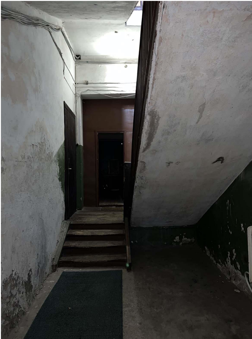
Фото 9. Лестничная клетка. 2-ой подъезд. Общий вид помещения 1-го этажа. Дата съемки: 11.04.2022 г. Автор: Куваева Ю.П.
