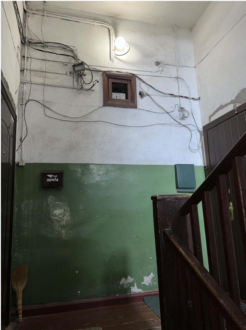
Фото 6. Лестничная клетка. 1-ый подъезд. Крепление электропроводки к стене 1-го этажа. Дата съемки: 11.04.2022 г. Автор: Куваева Ю.П.
