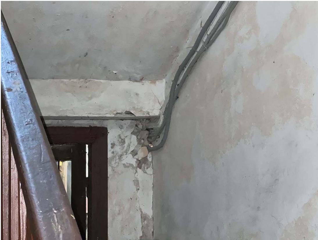
Фото 10. Лестничная клетка. 2-ой подъезд. 1-ый этаж. Прохождение электропроводов в гофрированных трубах в стене тамбура. Дата съемки: 11.04.2022 г. Автор: Куваева Ю.П.
