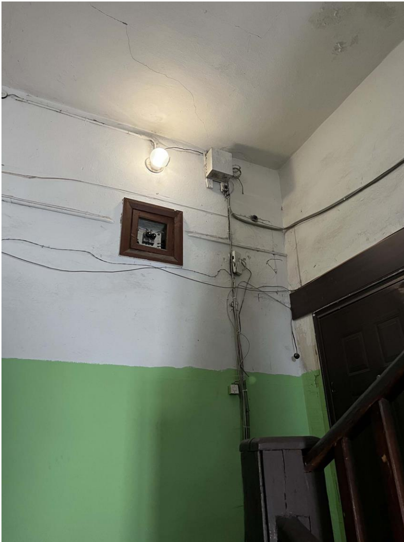
Фото 15. Лестничная клетка. 3-ий подъезд. Крепление открытой электропроводки к стене 2-го этажа. Дата съемки: 11.04.2022 г. Автор: Куваева Ю.П.
