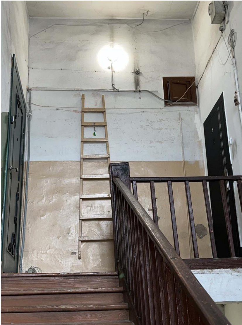
Фото 12. Лестничная клетка. 2-ой подъезд. Крепление открытой электропроводки на стене 1-го этажа. Дата съемки: 11.04.2022 г. Автор: Куваева Ю.П.
