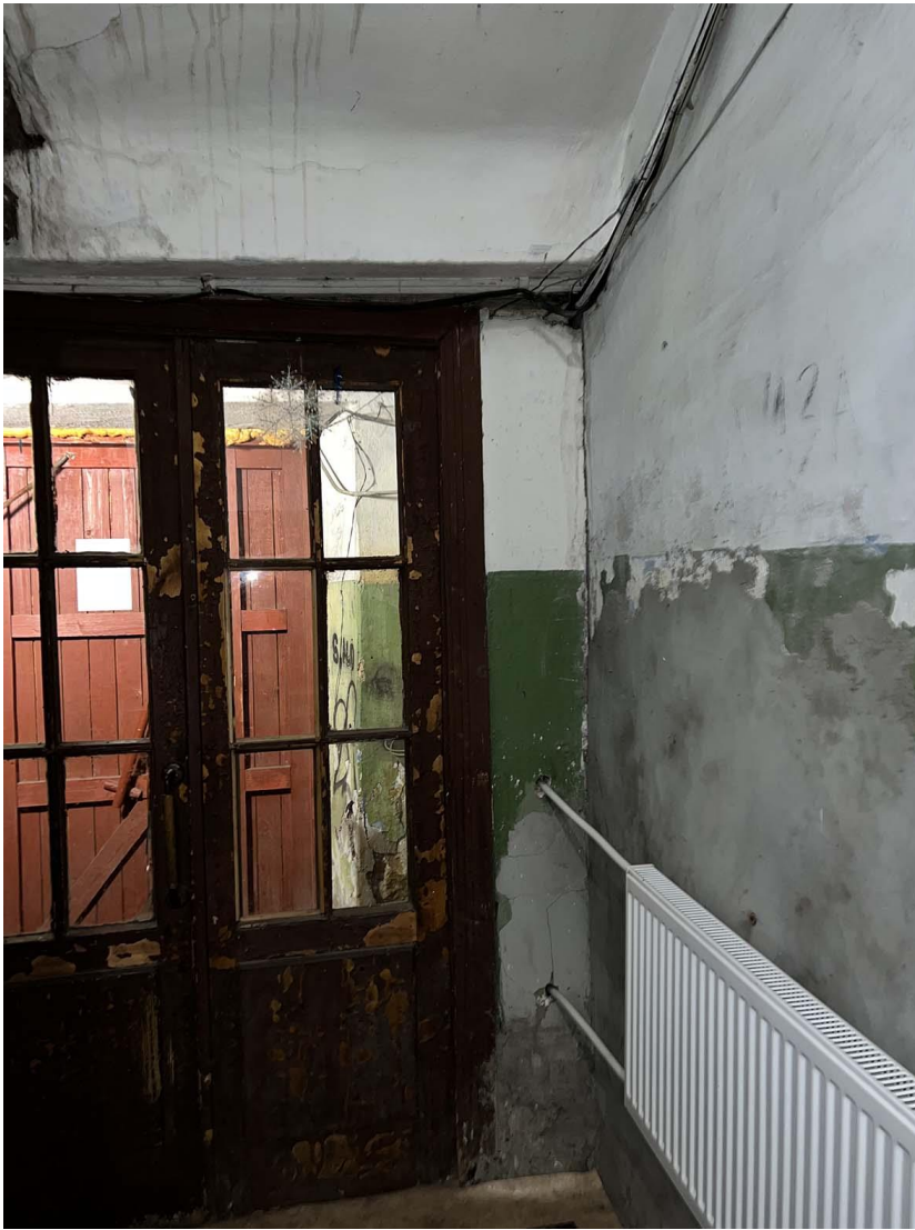
Фото 5. Лестничная клетка. 1-ый подъезд, 1-ый этаж. Крепление электропроводки к стене тамбура. Дата съемки: 11.04.2022 г. Автор: Куваева Ю.П.
