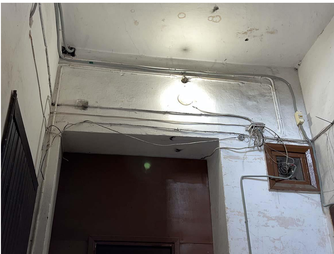
Фото 11. Лестничная клетка. 2-ой подъезд. Крепление электропроводки (открытая и в гофрированных трубах) на стене 1-го этажа. Дата съемки: 11.04.2022 г. Автор: Куваева Ю.П.
