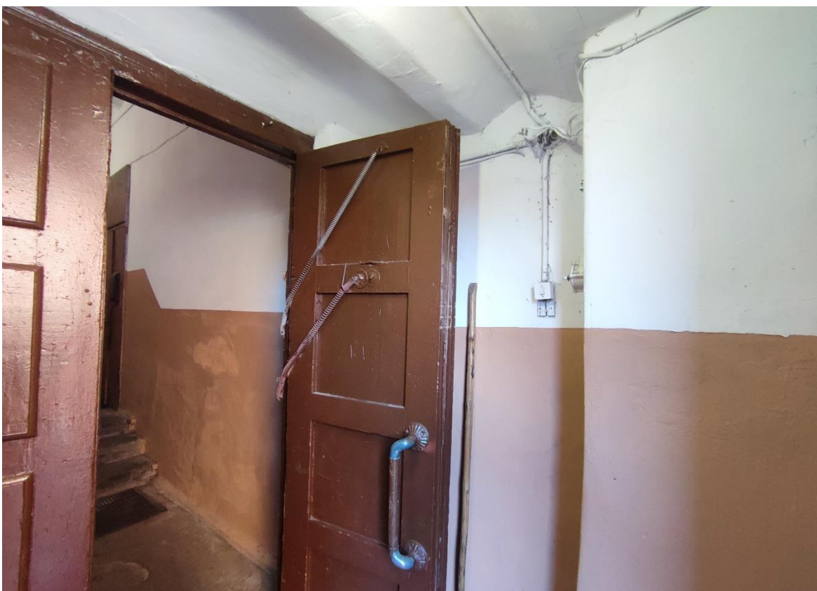
Фото 6. Тамбур лестничной клетки ЛК-3. Вскрыта распределительная коробка. Дата съемки: 11.04.2022 г. Автор: Глинская Н.Б.
