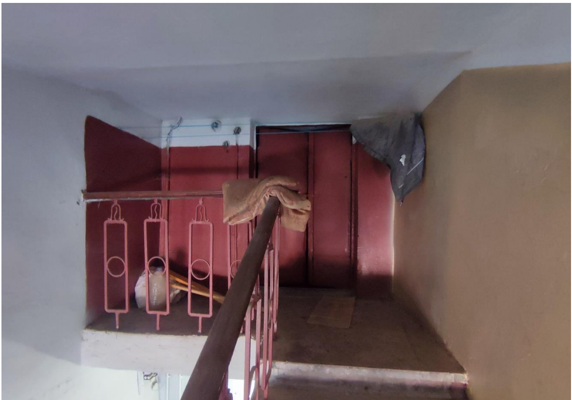
Фото 10. Лестничная площадка ЛК-1 в уровне чердака. Вскрыта распределительная коробка.
