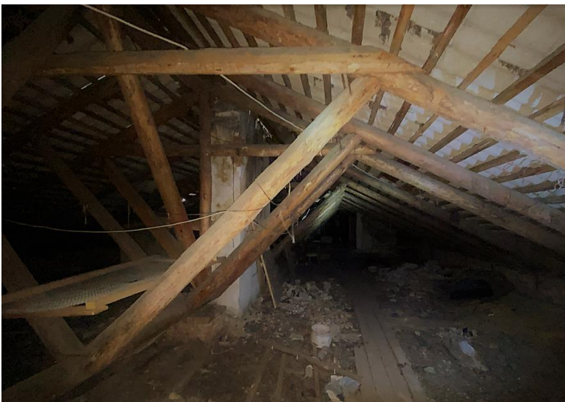
Фото 12. Общий вид помещения чердака. В помещении отсутствует система освещения.
