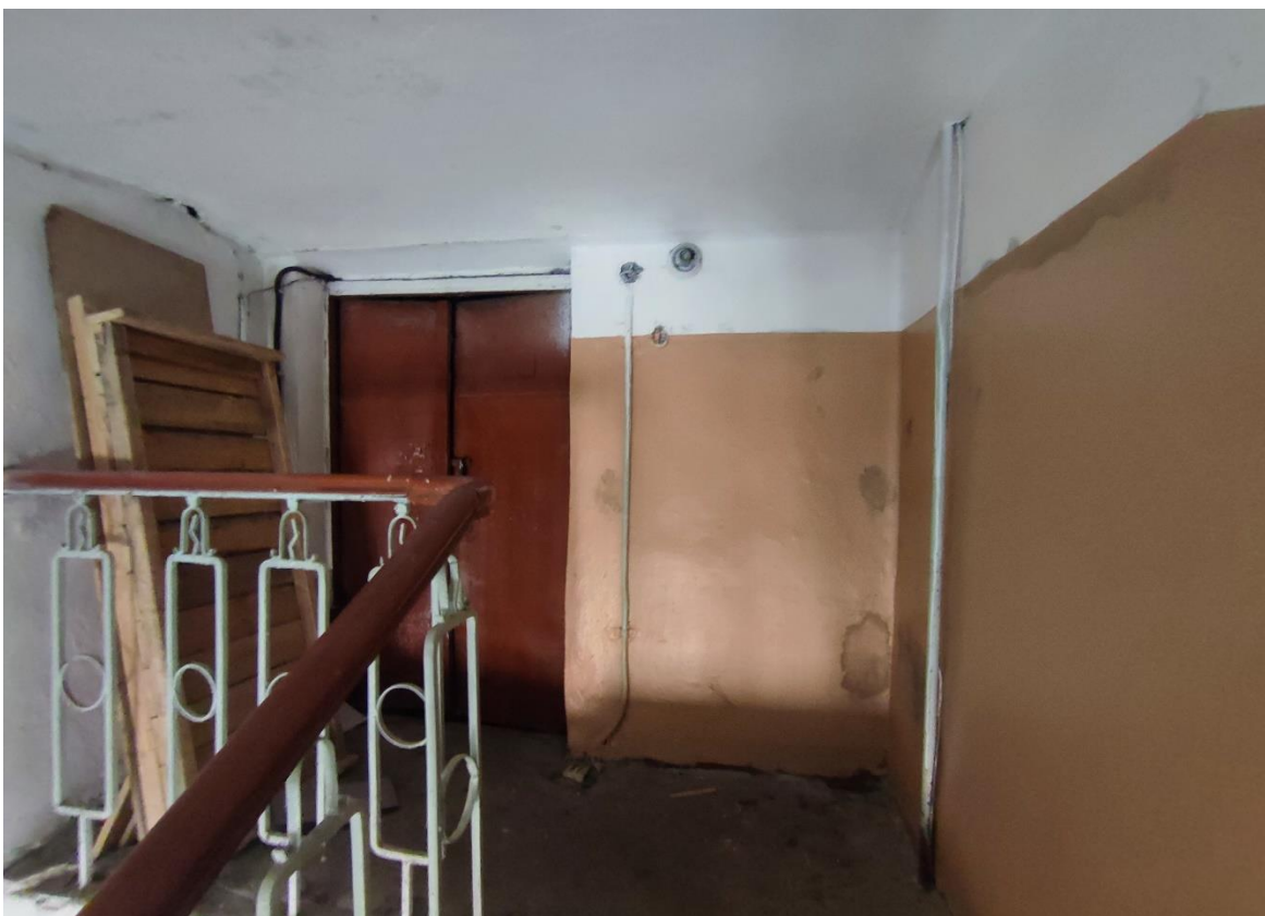
Фото 11. Лестничная площадка ЛК-3 в уровне чердака. Вскрыта распределительная коробка.
