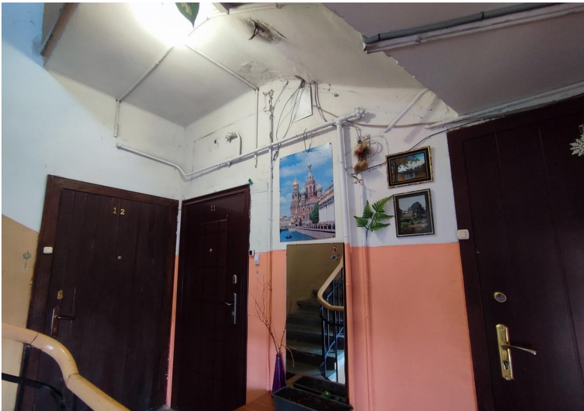
Фото 12. 4-ый этаж лестничной клетки ЛК-1. Расположение электропроводки по стенам с нарушением способа прокладки. Провода сетей связи не закреплены. Дата съемки: 11.04.2022 г. Автор: Глинская Н.Б.
