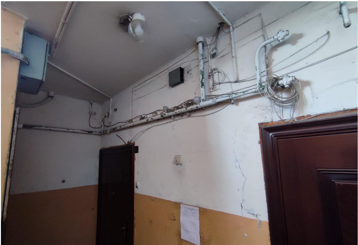
Фото 7. 1-ый этаж лестничной клетки ЛК-2. Расположение электропроводки по стенам с нарушением способа прокладки. Провода сетей связи не закреплены. Аварийное освещение отсутствует. Дата съемки: 11.04.2022 г. Автор: Глинская Н.Б.
