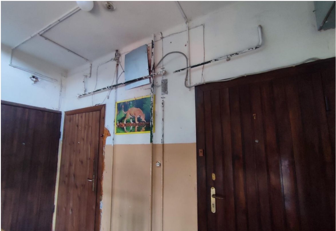
Фото 10. 3-ий этаж лестничной клетки ЛК-1. Расположение электропроводки по стенам с нарушением способа прокладки. Провода сетей связи не закреплены. Дата съемки: 11.04.2022 г. Автор: Глинская Н.Б.
