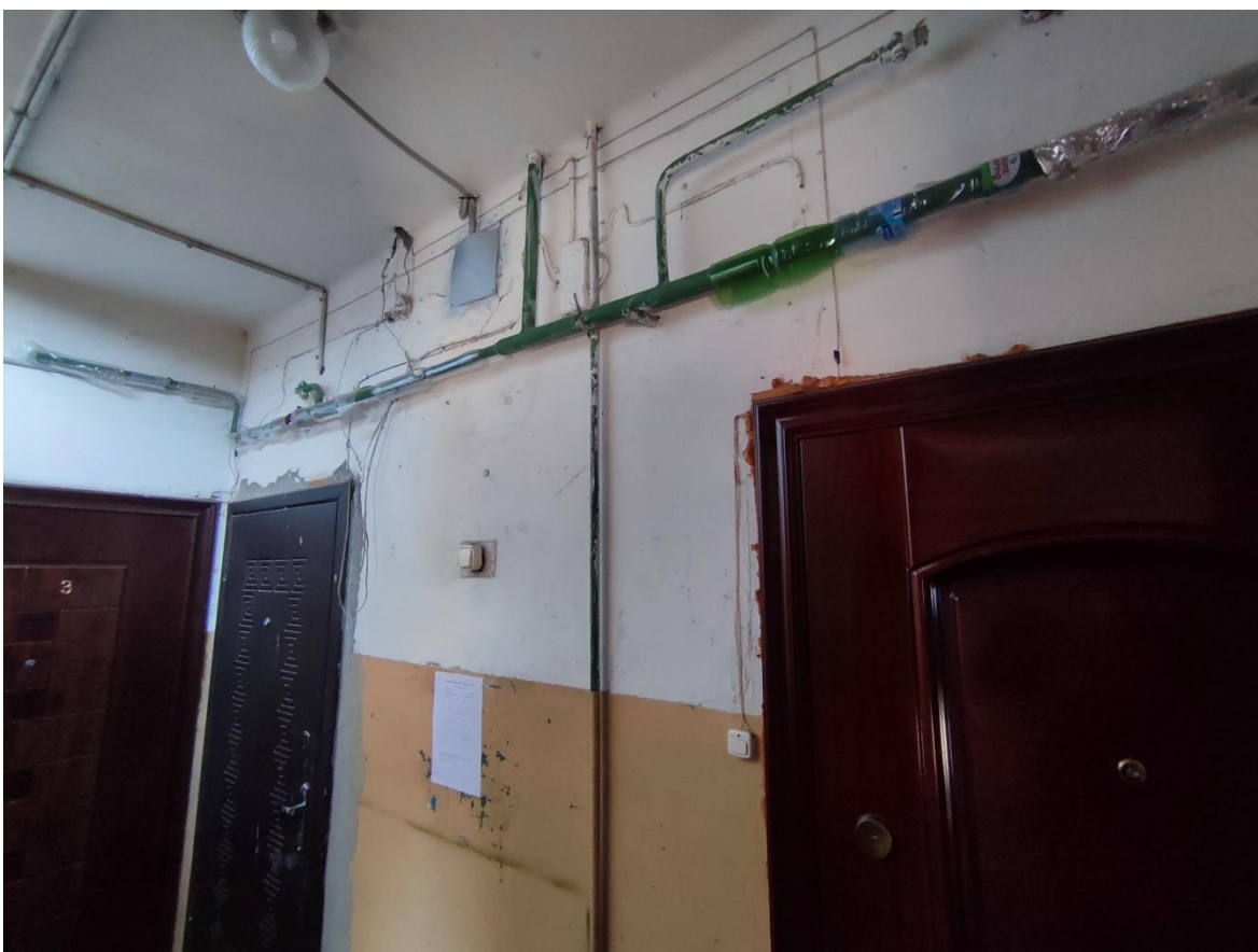
Фото 6. 1-ый этаж лестничной клетки ЛК-1. Расположение электропроводки по стенам с нарушением способа прокладки. Дата съемки: 11.04.2022 г. Автор: Глинская Н.Б.
