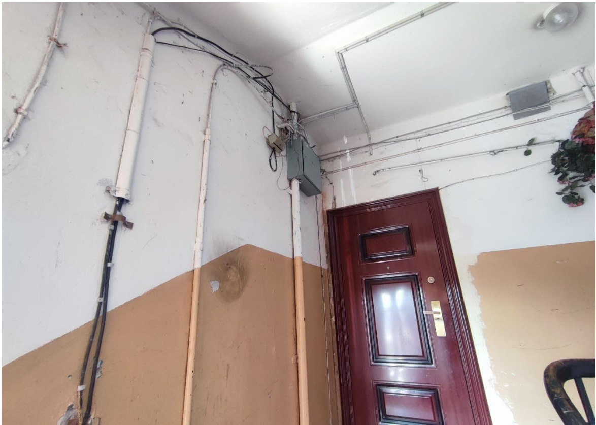
Фото 9. 2-ой этаж лестничной клетки ЛК-2. Расположение электропроводки по стенам с нарушением способа прокладки. Дата съемки: 11.04.2022 г. Автор: Глинская Н.Б.
