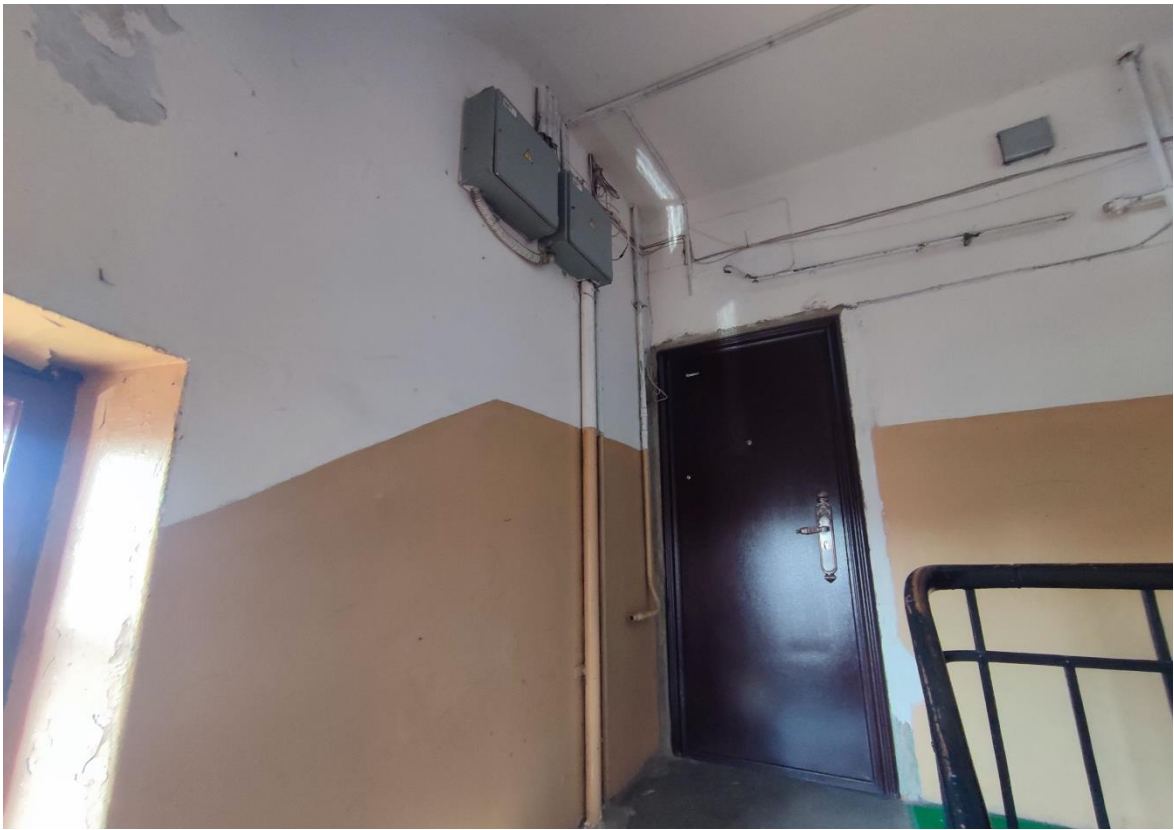
Фото 11. 3-ий этаж лестничной клетки ЛК-2. Расположение электропроводки по стенам с нарушением способа прокладки. Провода сетей связи не закреплены. Дата съемки: 11.04.2022 г. Автор: Глинская Н.Б.
