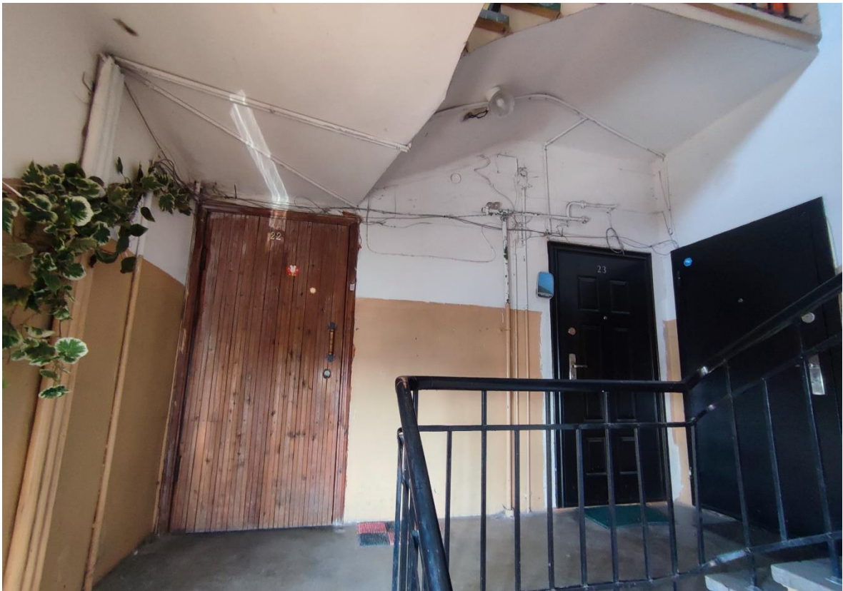
Фото 13. 4-ый этаж лестничной клетки ЛК-2. Расположение электропроводки по стенам с нарушением способа прокладки. Провода сетей связи не закреплены. Аварийное освещение отсутствует. Дата съемки: 11.04.2022 г. Автор: Глинская Н.Б.
