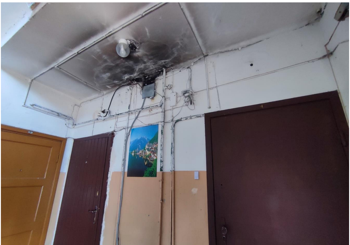
Фото 8. 2-ой этаж лестничной клетки ЛК-1. Следы возгорания кабеля. Расположение электропроводки по стенам с нарушением способа прокладки. Провода сетей связи не закреплены. Аварийное освещение отсутствует. Дата съемки: 11.04.2022 г. Автор: Глинская Н.Б.
