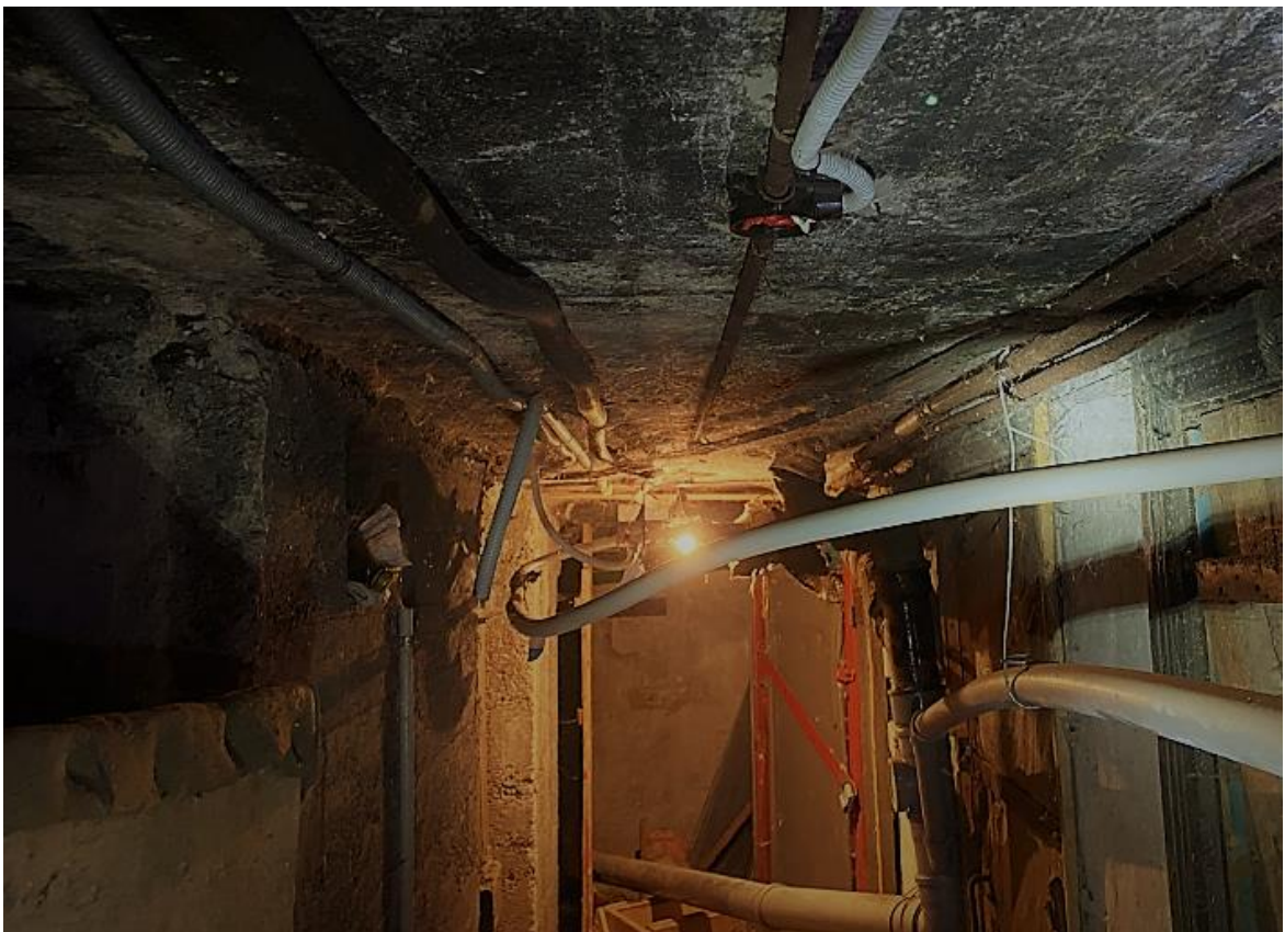
Фото 4. Подвал. Вскрыта распределительная коробка. Отсутствует плафон светильника. Дата съемки: 11.04.2022 г. Автор: Глинская Н.Б.
