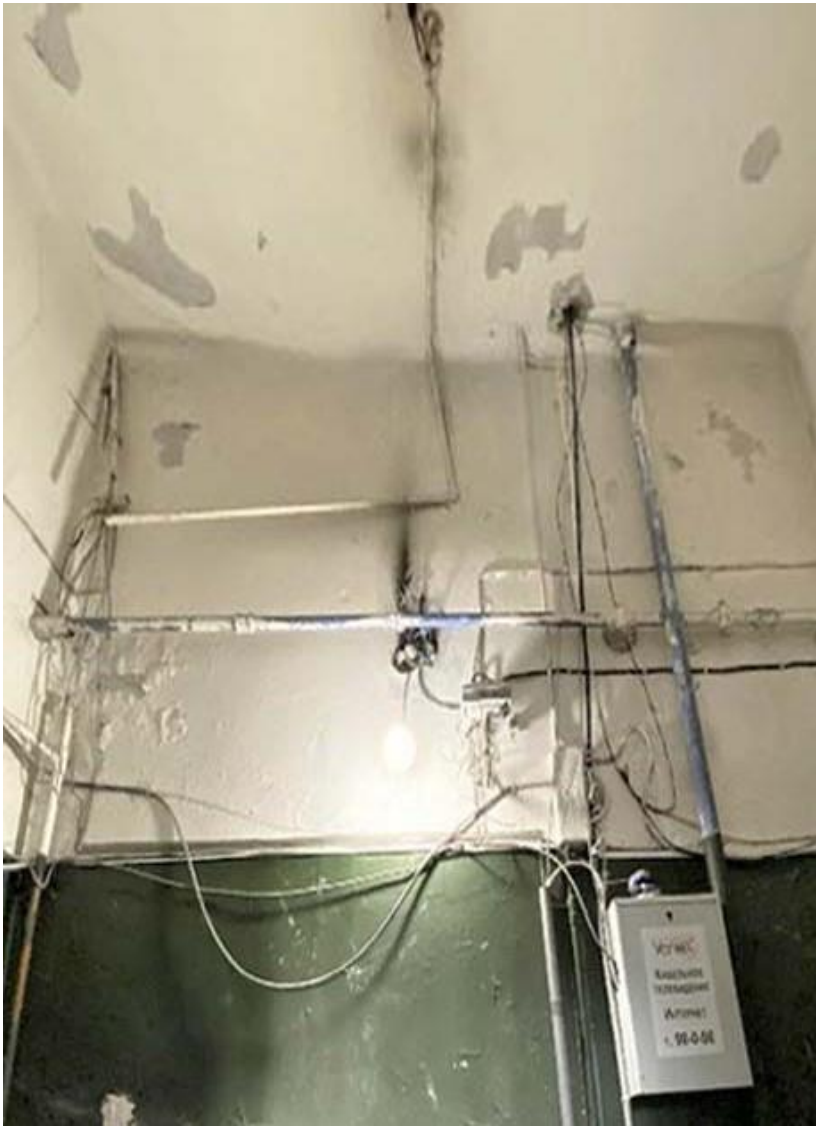
Фото 18. Лестничная клетка во 2-ом подъезде. Расположение электропроводки по стенам и потолку с нарушением способа прокладки. Дата съемки: 11.04.2022 г. Автор: Куваева Ю.П.
