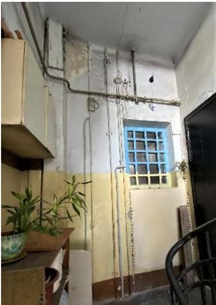
Фото 22. Лестничная клетка в 5-ом подъезде. 5-ый этаж. Расположение электропроводки по стене с нарушением способа прокладки. Дата съемки: 11.04.2022 г. Автор: Куваева Ю.П.
