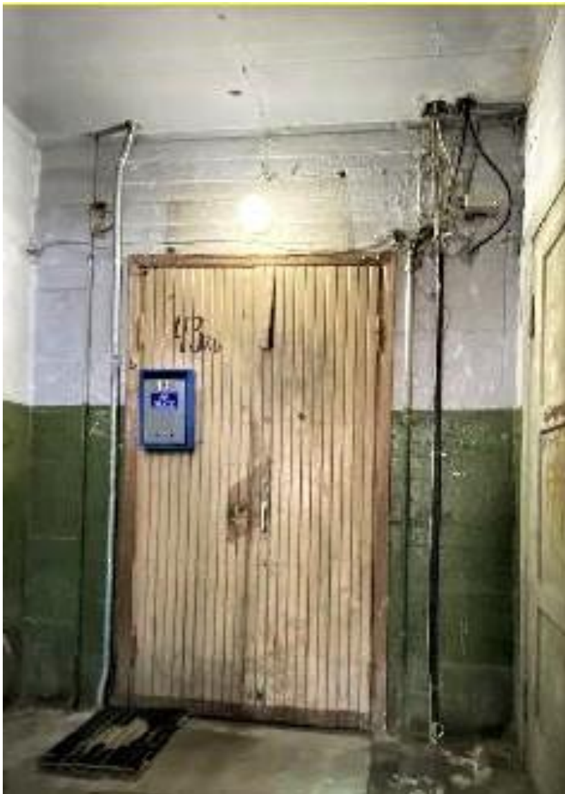
Фото 19. Лестничная клетка в 3-ем подъезде. 2-ой этаж. Расположение электропроводки по стене с нарушением способа прокладки. Дата съемки: 11.04.2022 г. Автор: Куваева Ю.П.
