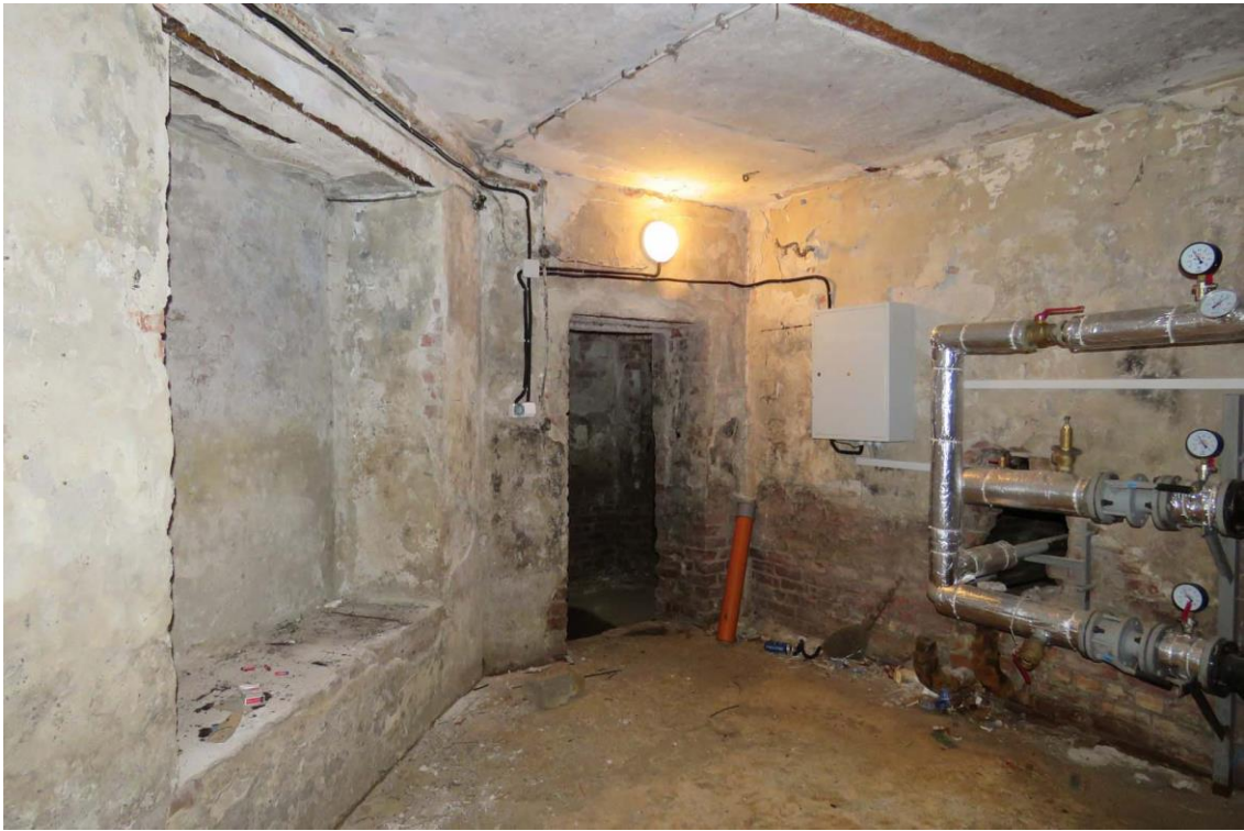
Фото 7. Расположение электропроводки по стенам помещения с нарушением способа прокладки. Дата съёмки: 11.04.2022 г. Автор: Куваева Ю.П.
