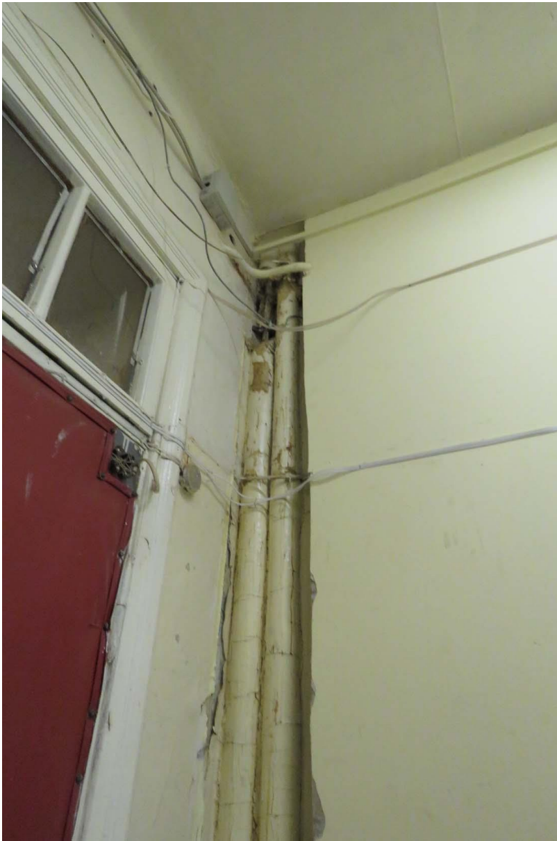
Фото 16. Помещение 2-го этажа. Расположение электропроводки по стенам с нарушением способа прокладки. Дата съемки: 11.04.2022 г. Автор: Куваева Ю.П.
