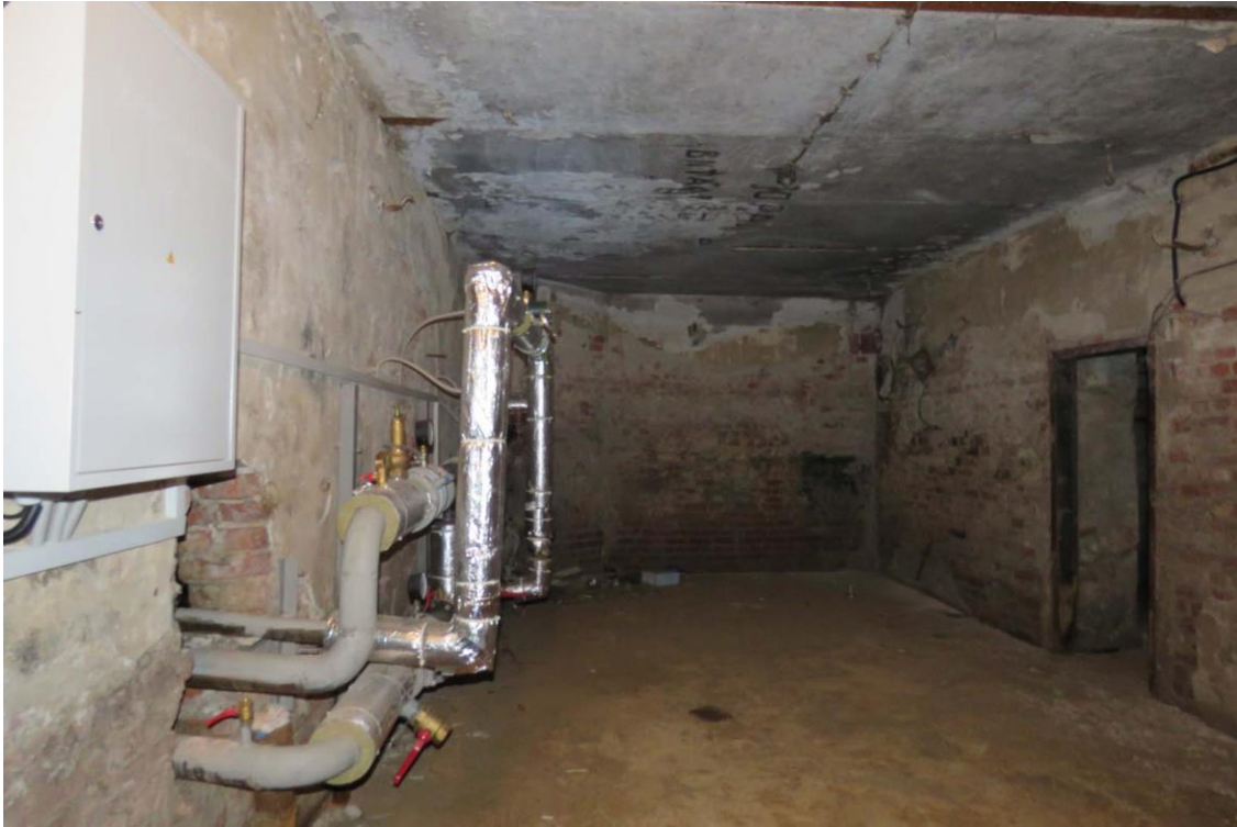
Фото 5. Подвал. Расположение щита и электропроводки по стенам. Дата съемки: 11.04.2022 г. Автор: Куваева Ю.П.
