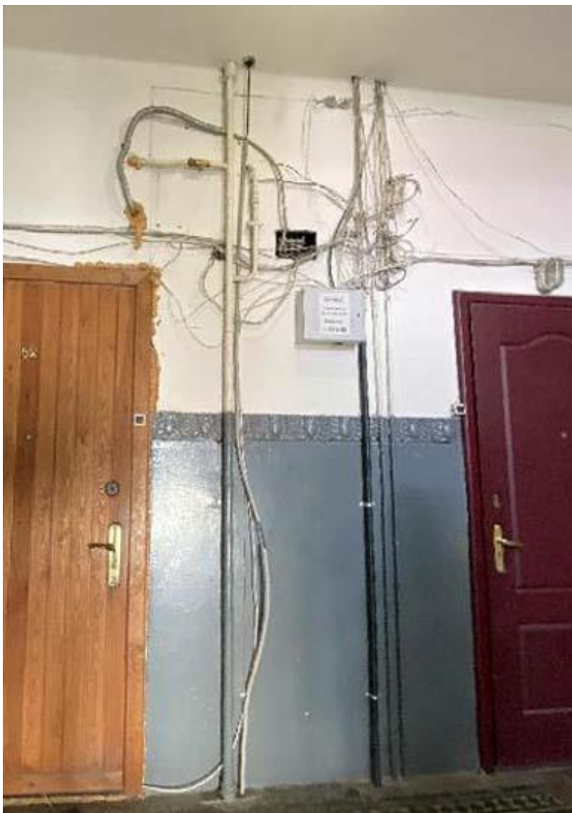
Фото 15. Лестничная клетка в 1-ом подъезде. 4-ый этаж. Расположение электропроводки по стене с нарушением способа прокладки. Дата съемки: 11.04.2022 г. Автор: Куваева Ю.П.
