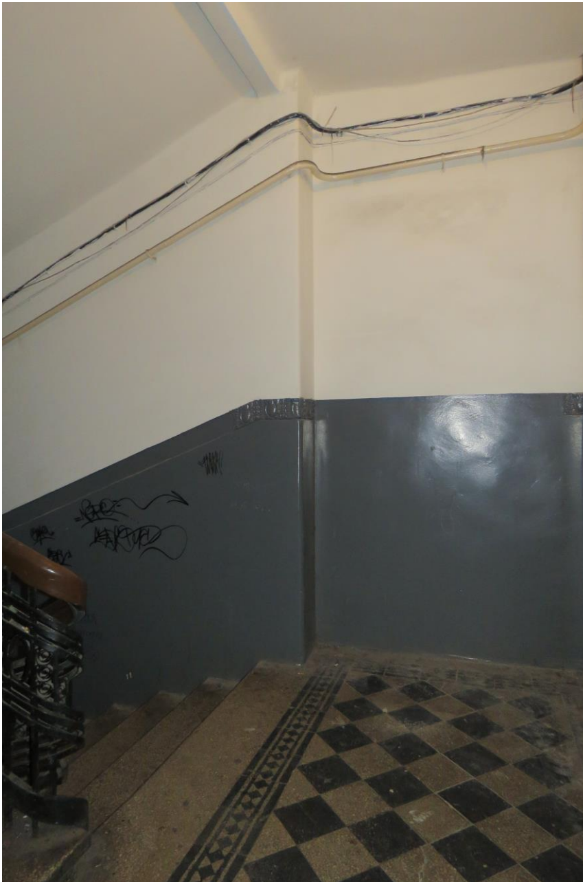
Фото 14. Лестничная клетка в 1-ом подъезде. 2-ой этаж. Расположение электропроводки по стене. Дата съемки: 11.04.2022 г. Автор: Куваева Ю.П.
