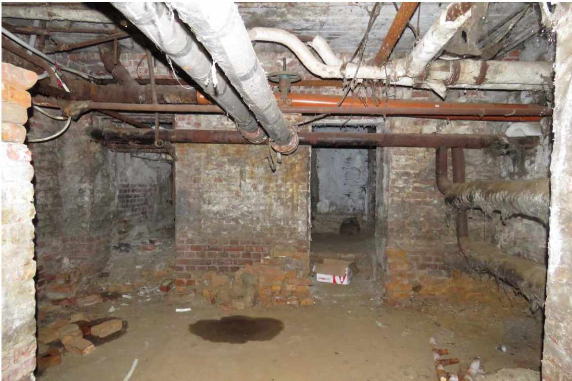
Фото 10. Расположение электропроводки с нарушением способа прокладки. Дата съемки: 11.04.2022 г. Автор: Куваева Ю.П.
