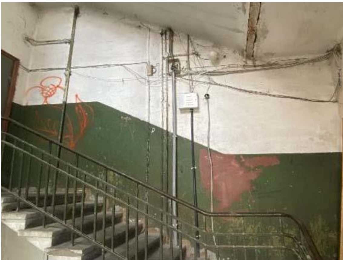
Фото 21. Лестничная клетка в 4-ом подъезде. 3-ий этаж. Расположение электропроводки по стене с нарушением способа прокладки. Дата съемки: 11.04.2022 г. Автор: Куваева Ю.П.
