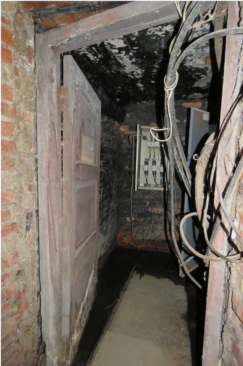
Фото 11. Расположение щита и электропроводки с нарушением способа прокладки. Дата съемки: 11.04.2022 г. Автор: Куваева Ю.П.
