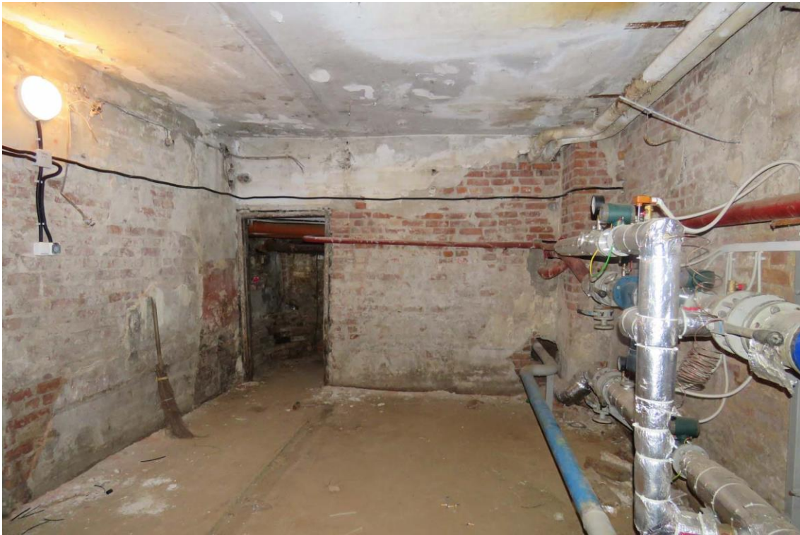
Фото 9. Расположение электропроводки по стенам помещения. Дата съемки: 11.04.2022 г. Автор: Куваева Ю.П.
