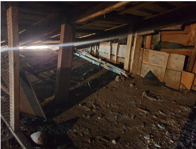
36. «Жилой дом М. Шушина», Ленинградская область, Выборгский район, г. Выборг, ул. Крепостная, д.12. Чердак. Общий вид. Фото 20.08.2022г.
