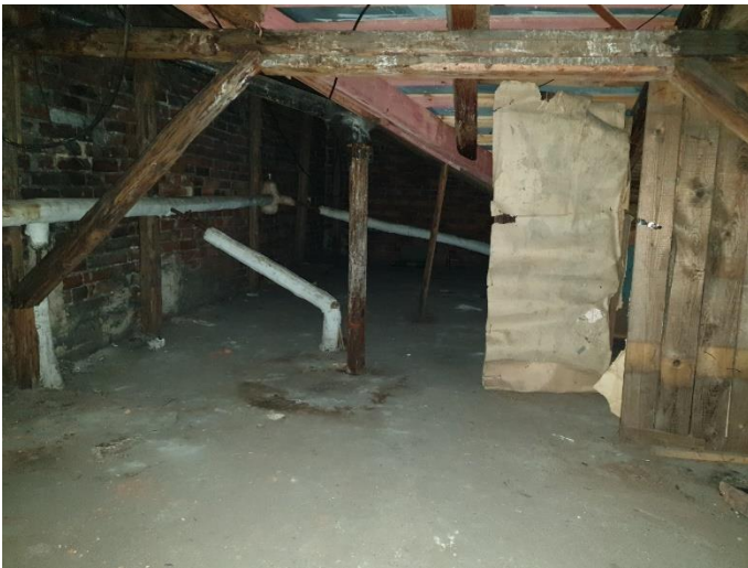
42. «Жилой дом М. Шушина», Ленинградская область, Выборгский район, г. Выборг, ул. Крепостная, д.12. Чердак. Общий вид. Фото 20.08.2022г.
