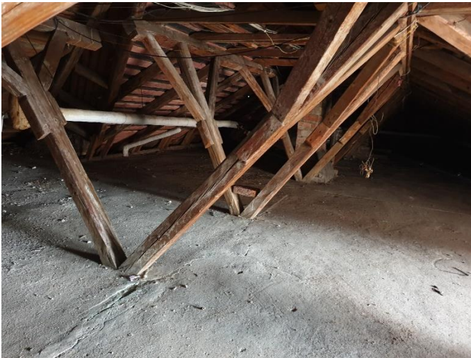
43. «Жилой дом М. Шушина», Ленинградская область, Выборгский район, г. Выборг, ул. Крепостная, д.12. Чердак. Общий вид. Фото 20.08.2022г.
