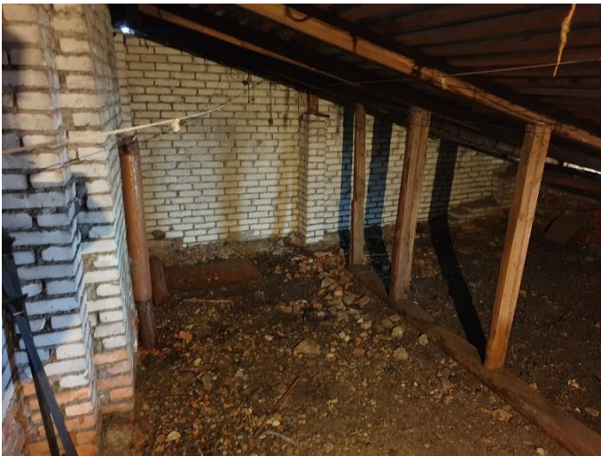
33. «Жилой дом М. Шушина», Ленинградская область, Выборгский район, г. Выборг, ул. Крепостная, д.12. Чердак. Общий вид. Фото 20.08.2022г.
