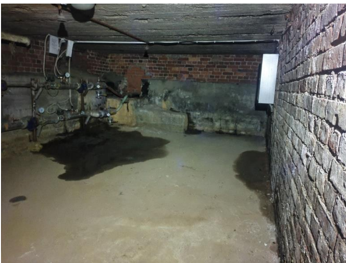
26. «Жилой дом с флигелем», Ленинградская область, Выборгский район, г. Выборг, ул. Садовая д.3,3а. Подвал. Общий вид. Фото 20.08.2022г.
