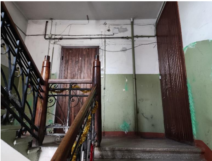
6. «Жилой дом с флигелем», Ленинградская область, Выборгский район, г. Выборг, ул. Садовая д.3,3а. Подъезд №1. Фрагмент. Фото 20.08.2022г.
