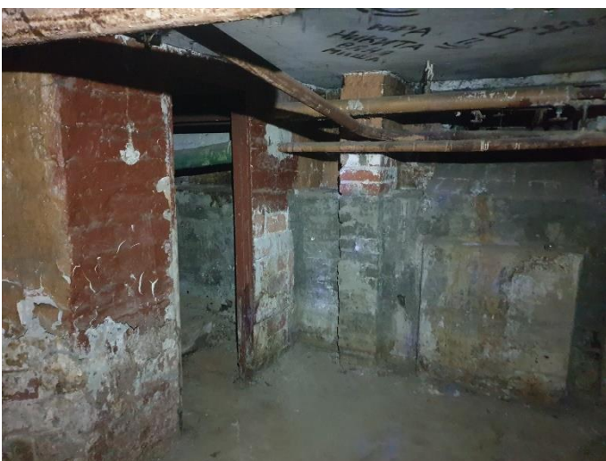
35. «Жилой дом с флигелем», Ленинградская область, Выборгский район, г. Выборг, ул. Садовая д.3,3а. Подвал. Фрагмент. Фото 20.08.2022г.
