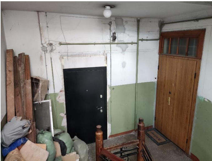
10. «Жилой дом с флигелем», Ленинградская область, Выборгский район, г. Выборг, ул. Садовая д.3,3а. Подъезд №1. Фрагмент. Фото 20.08.2022г.
