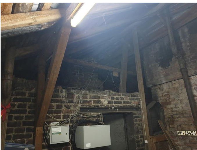
47. «Жилой дом с флигелем», Ленинградская область, Выборгский район, г. Выборг, ул. Садовая д.3,3а. Чердак. Фрагмент. Фото 20.08.2022г.
