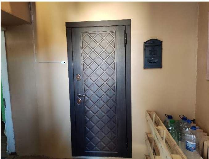
19. «Жилой дом», Ленинградская область, Выборгский район, г. Выборг, ул. Прогонная, д.1. Подъезд №4. Общий вид. Фото 20.08.2022г.
