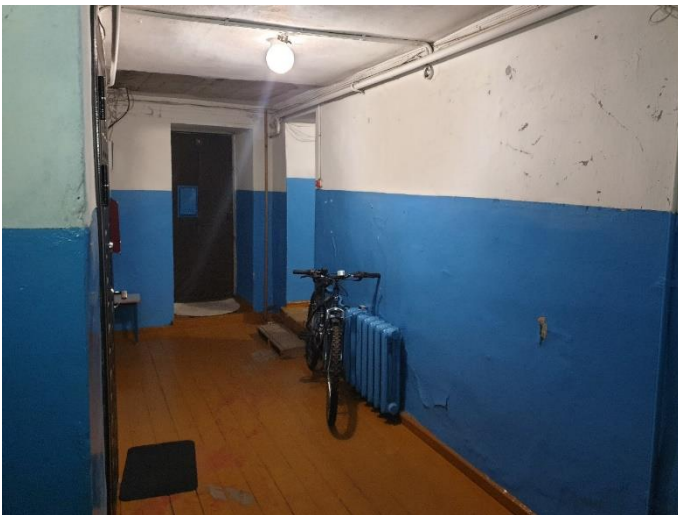
10. «Жилой дом», Ленинградская область, Выборгский район, г. Выборг, ул. Прогонная, д.1. Подъезд №2. Фрагмент. Фото 20.08.2022г.
