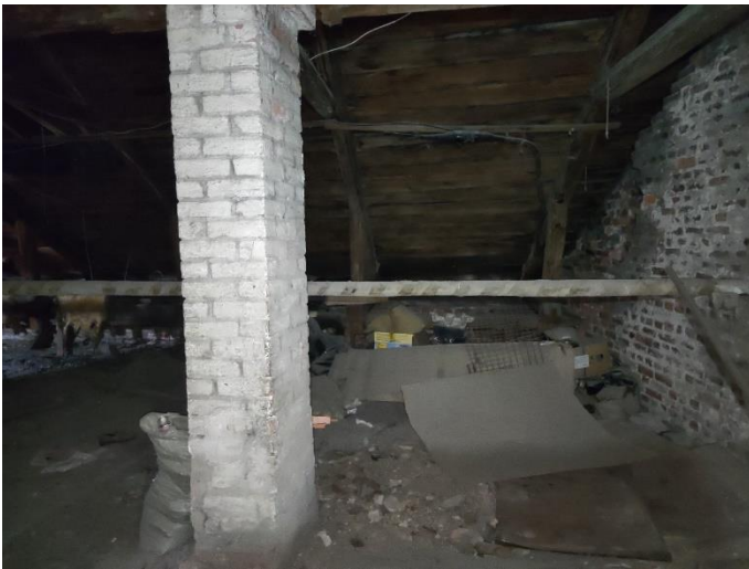
42. «Жилой дом», Ленинградская область, Выборгский район, г. Выборг, ул. Прогонная, д.1. Чердак. Фрагмент. Фото 20.08.2022г.
