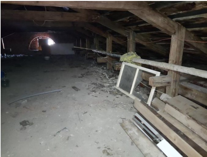
37. «Жилой дом», Ленинградская область, Выборгский район, г. Выборг, ул. Прогонная, д.1. Чердак. Фрагмент. Фото 20.08.2022г.
