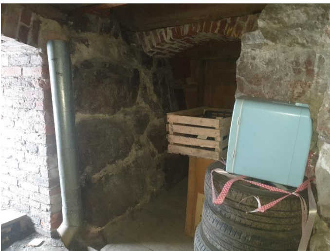
26. «Жилой дом», Ленинградская область, Выборгский район, г. Выборг, ул. Прогонная, д.1. Подвал. Фрагмент. Фото 20.08.2022г.
