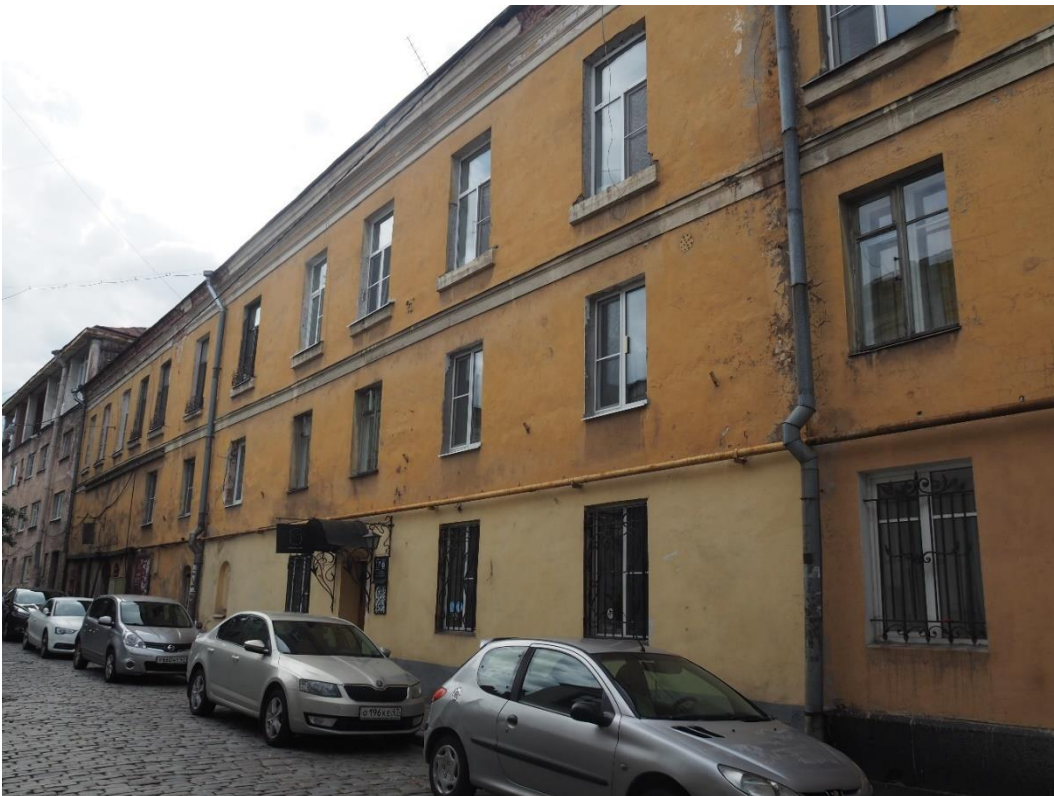
2. «Жилой дом», Ленинградская область, Выборгский район, г. Выборг, ул. Прогонная, д.1. Северо-восточный фасад. Общий вид. Фото 20.08.2022г.
