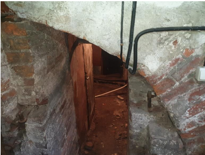
27. «Жилой дом», Ленинградская область, Выборгский район, г. Выборг, ул. Прогонная, д.1. Подвал. Фрагмент. Фото 20.08.2022г.
