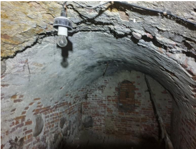
33. «Жилой дом», Ленинградская область, Выборгский район, г. Выборг, ул. Прогонная, д.1. Подвал. Фрагмент. Фото 20.08.2022г.
