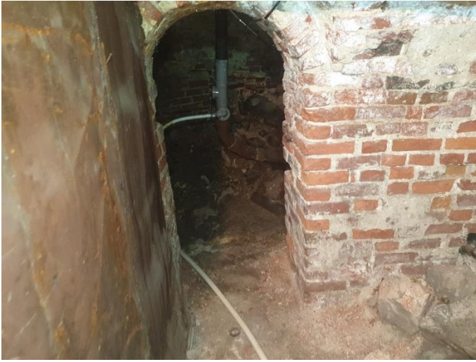
30. «Жилой дом», Ленинградская область, Выборгский район, г. Выборг, ул. Прогонная, д.1. Подвал. Фрагмент. Фото 20.08.2022г.
