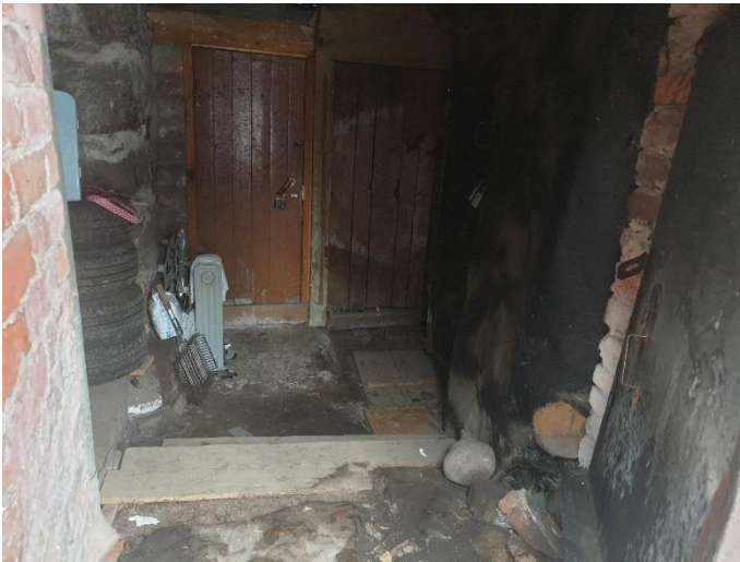
25. «Жилой дом», Ленинградская область, Выборгский район, г. Выборг, ул. Прогонная, д.1. Подвал. Общий вид. Фото 20.08.2022г.
