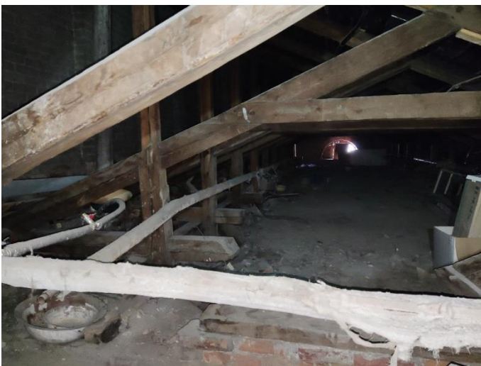
35. «Жилой дом», Ленинградская область, Выборгский район, г. Выборг, ул. Прогонная, д.1. Чердак. Общий вид. Фото 20.08.2022г.
