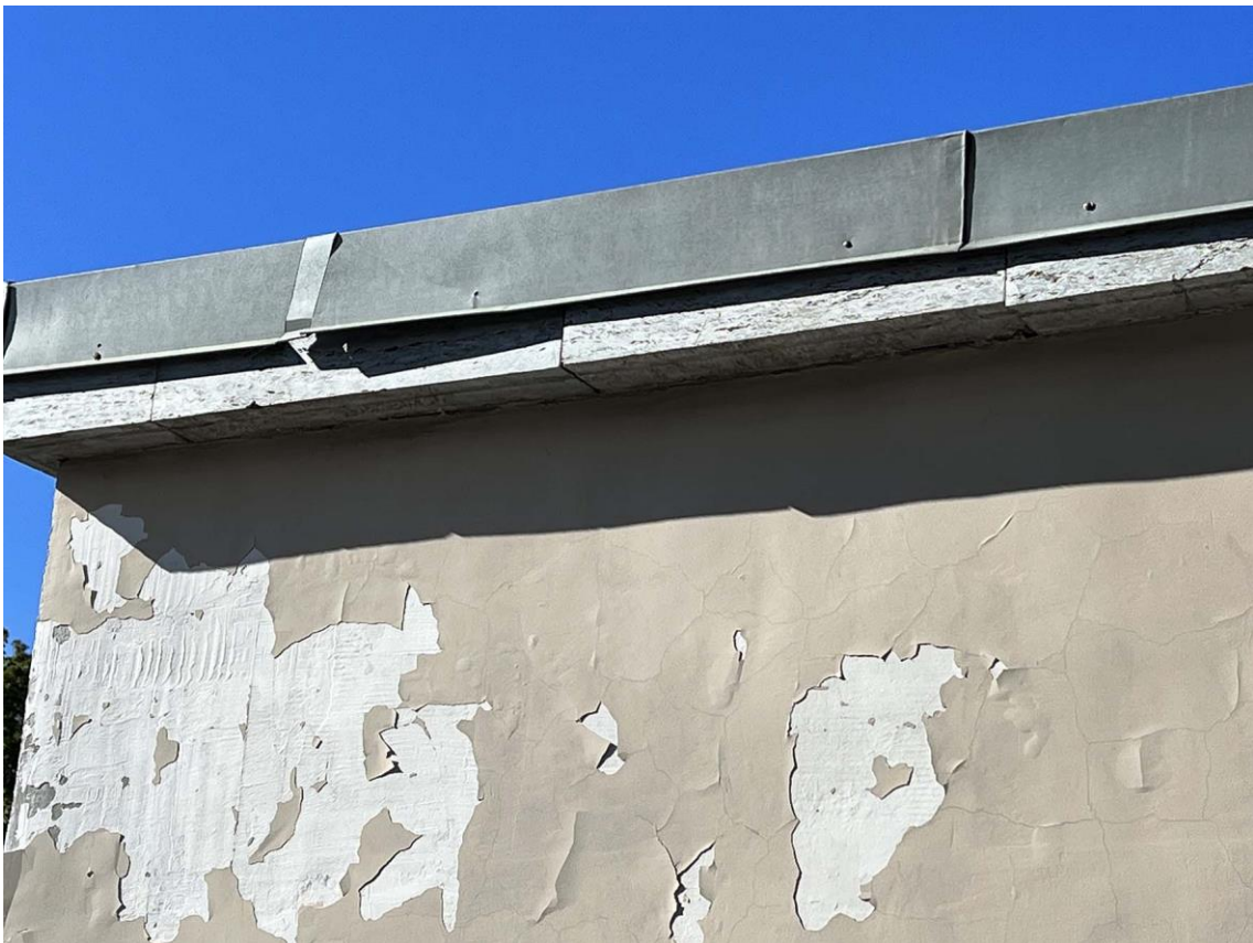
Фото 8. Фрагмент левой части юго-восточного фасада светового фонаря. Дата съемки: 08.09.2022 г. Автор съемки: Куваева Ю.П.
