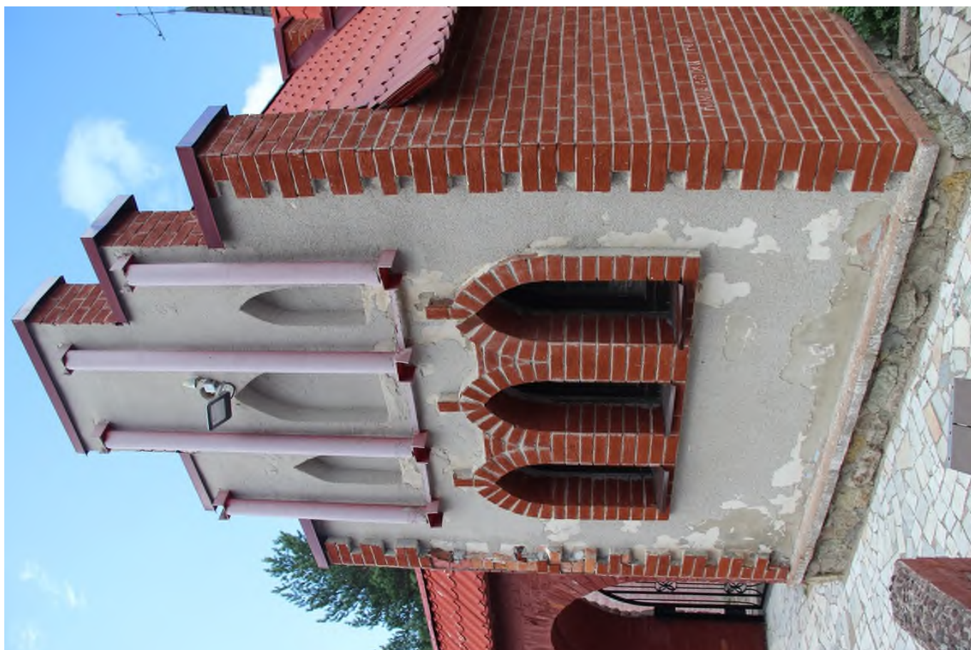
60 Выявленный ОКН «Детский игровой комплекс «Андерсенград», адрес: Ленинградская обл., г. Сосновый Бор, ул. Солнечная, д. 1. Домик Оле-Лукойе. Южный фасад. Дата съемки: 19.07.2022 г.
