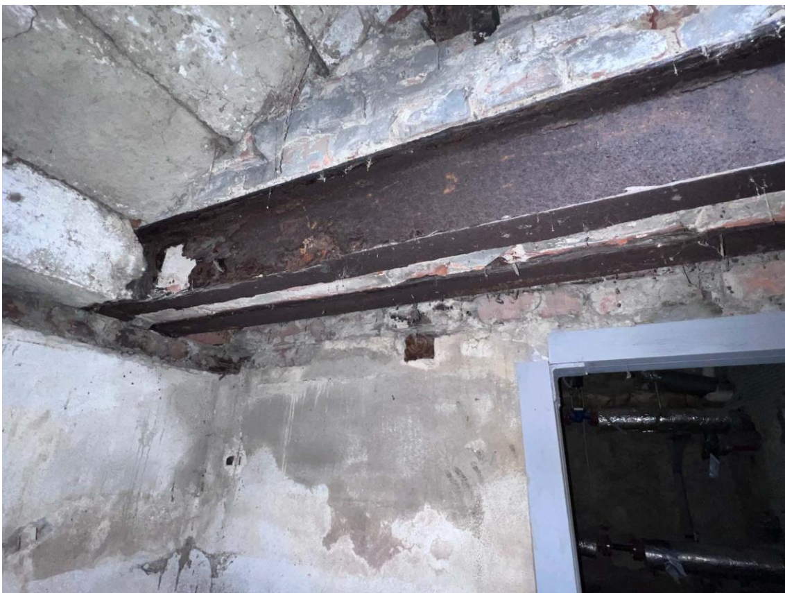
Фото 11. Фрагмент разрушенной балки. Фото с запада. Пом. 2. Дата съемки: 19.05.2022 г. Автор съемки: Куваева Ю.П.
