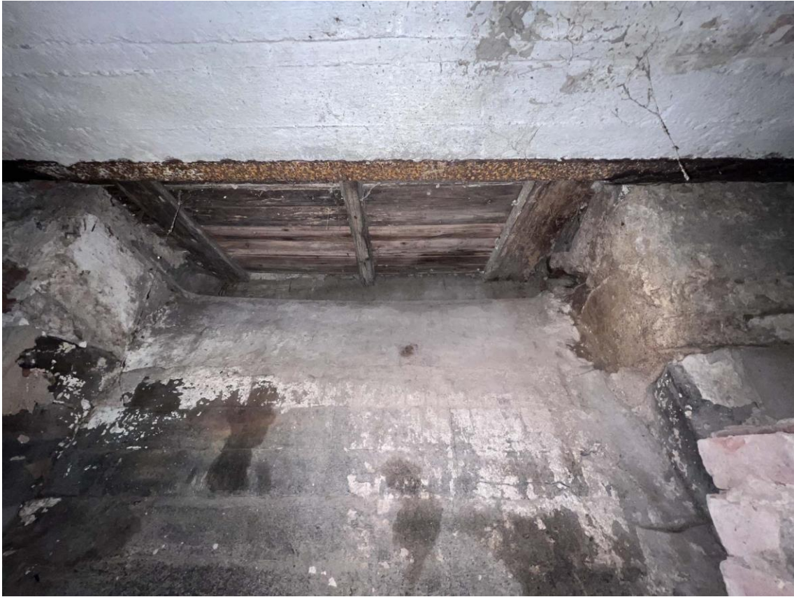
Фото 22. Пом. 7. Защи́тый приямок. Дата съёмки: 19.05.2022 г. Автор съёмки: Куваева Ю.П.
