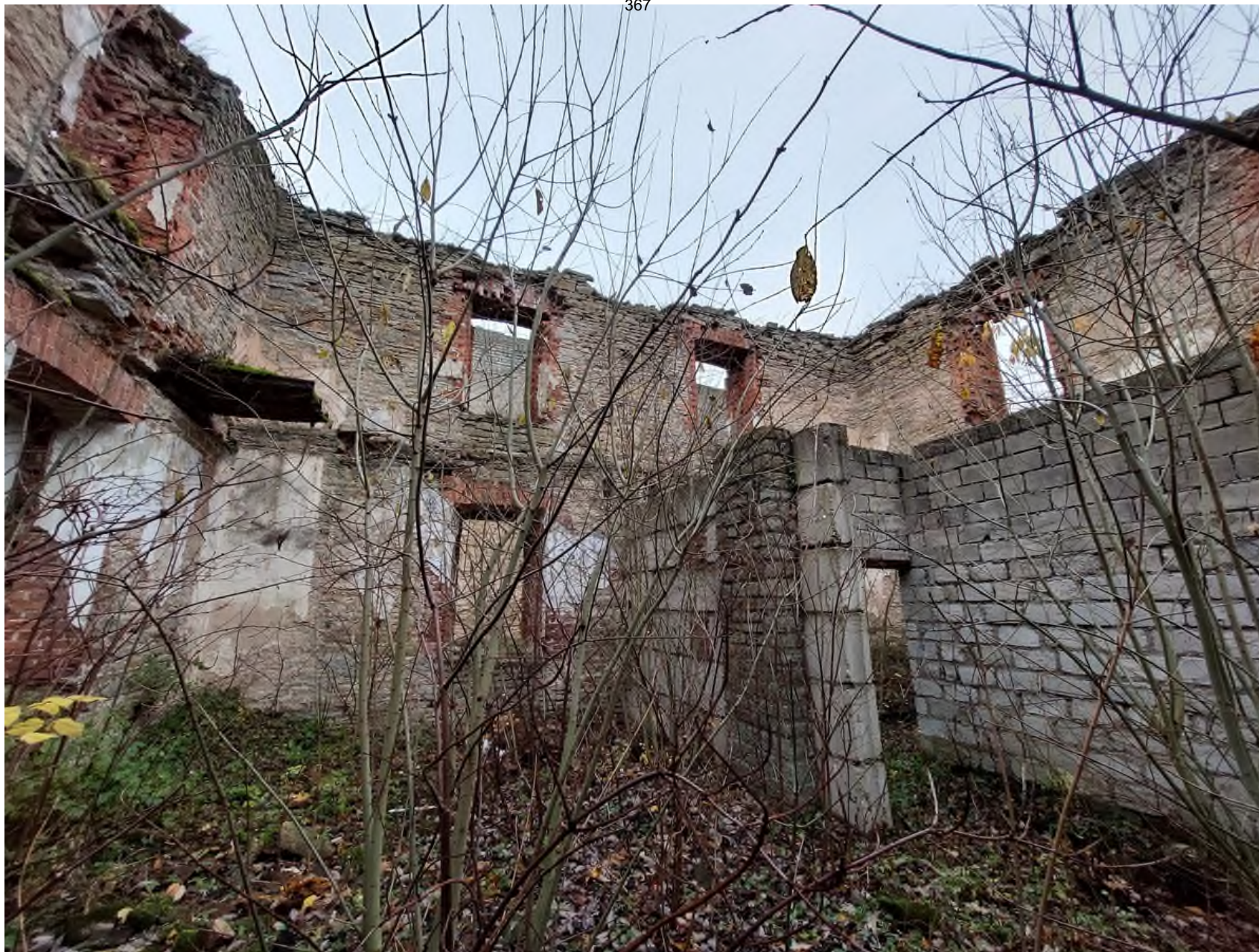
28 Выявленный ОКН «Большой Амбар» в составе ОКН федерального значения «Ансамбль Ивангородской крепости» по адресу: Ленинградская область, Кингисеппский район, г. Ивангород, Девичья Гора, литера Ж. Интерьер. Вид на западную наружную стену. Дата съемки: 14.10.2022 г.
