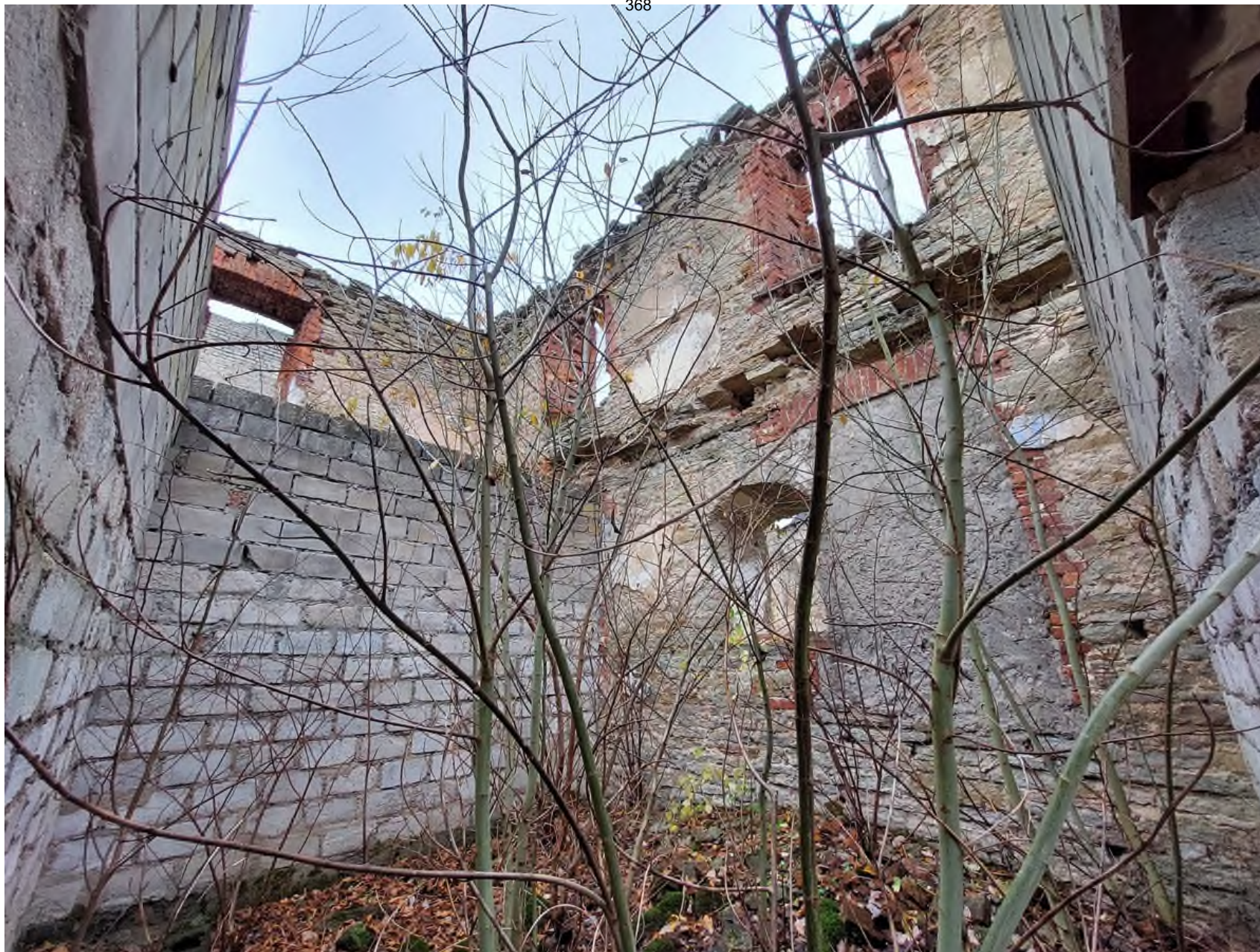
29 Выявленный ОКН «Большой Амбар» в составе ОКН федерального значения «Ансамбль Ивангородской крепости» по адресу: Ленинградская область, Кингисеппский район, г. Ивангород, Девичья Гора, литера Ж. Интерьер. Вид на северную наружную стену. Дата съемки: 14.10.2022 г.
